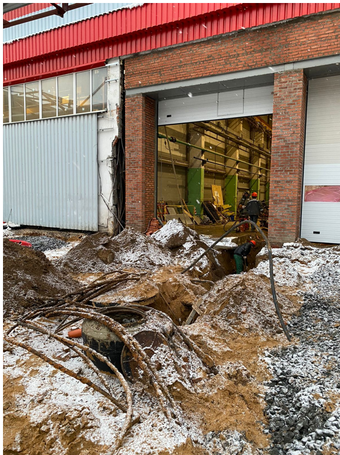
Фотофиксация разрушенного земляного полотна.
