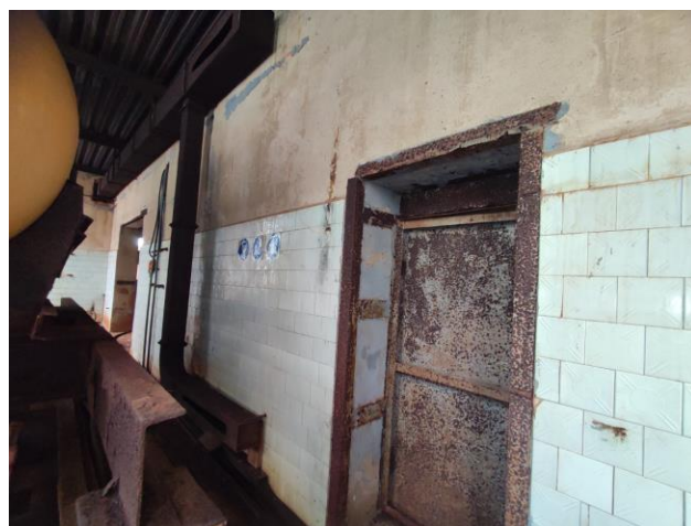
Фото 52. Коррозия всех элементов дверного блока.
