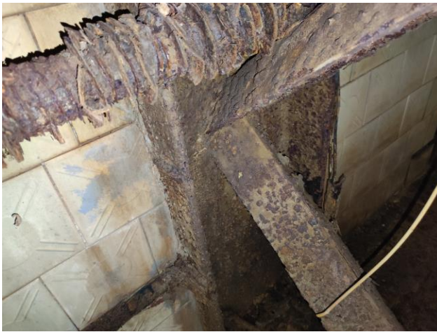
Фото 27. Пластичная химическая (газовая) коррозия, что привело к потере сечения элементов решетки колонн до 40% и ветвей колонны до 30%.
