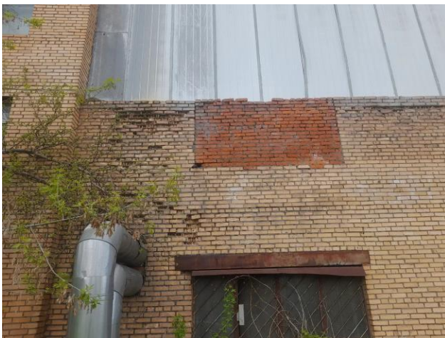
Фото 17. Отсутствие защитного фартука верха кирпичной части стены. Следы замачивания. Морозная деструкция элементов кирпичной кладки. Коррозия оконного блока включая перемычки.
