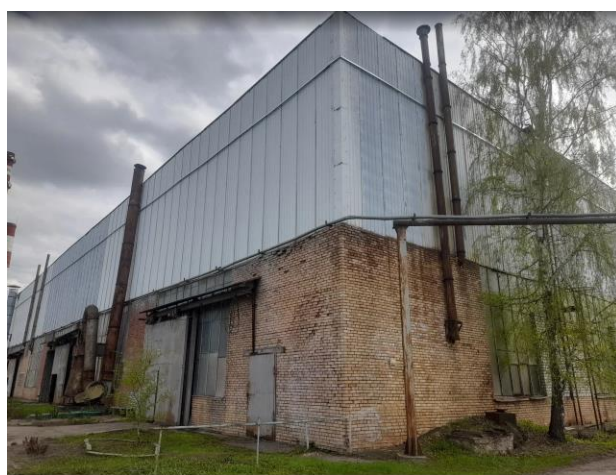
Фото 8. Скопление грунта. Произрастание растительности по отмостке.
