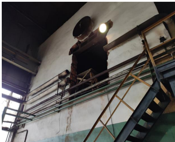
Фото 54. Необращенный проем в стене вент. камеры.
