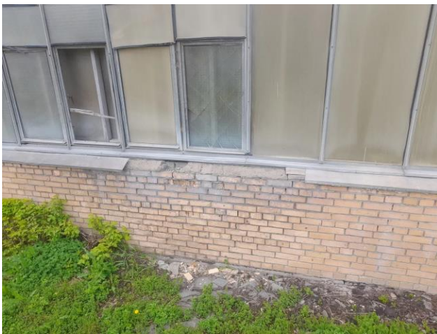
Фото 15. Отсутствие оконного отлива.
