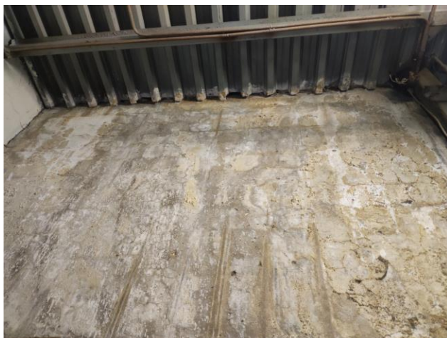
Фото 49. Следы замачивания. Растрескивание отделочного слоя.
