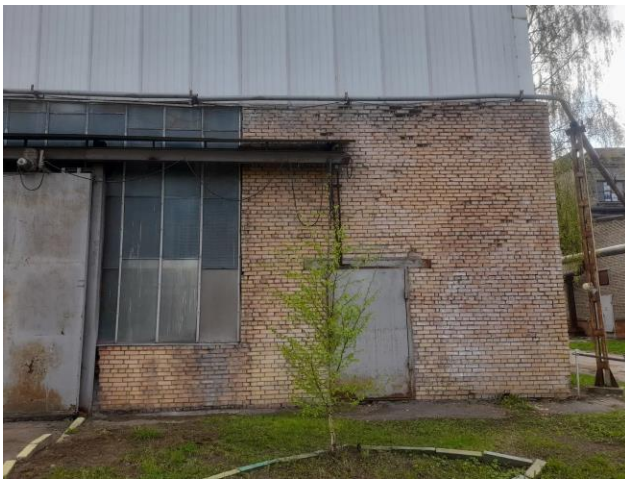
Фото 13. Отсутствие защитного фартука верха кирпичной части стены. Следы замачивания. Морозная деструкция элементов кирпичной кладки. Коррозия дверного блока включая перемычки.
