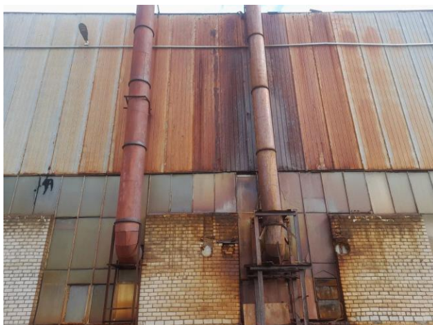
Фото 11. Отсутствие защитного фартука выступа участка стеновой конструкции. Следы замачивания. Морозная деструкция элементов кирпичной кладки. Налет из-за газовых труб. Коррозия металлического основания сэндвич панелей.
