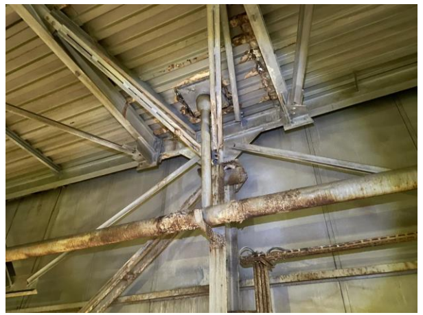
Фото 78. Следы замачивания. Продукты коррозии элементов покрытия.
