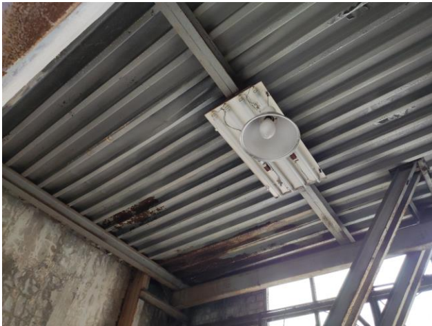
Фото 63. Коррозия ограждающей конструкции.
