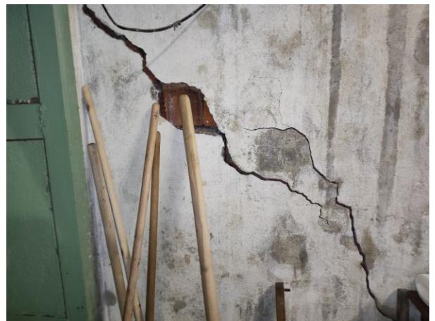
Фото 48. Вертикальная наклонная сквозная трещина по перегородке помещений.
