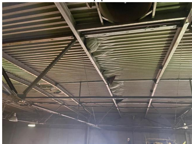
Фото 81. Отслоение окрасочного покрытия.
