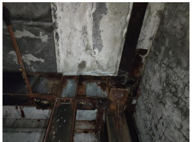
Фото 60. Вид на конструкции перекрытия. Коррозия металлических элементов перекрытия. Следы замачивания.
