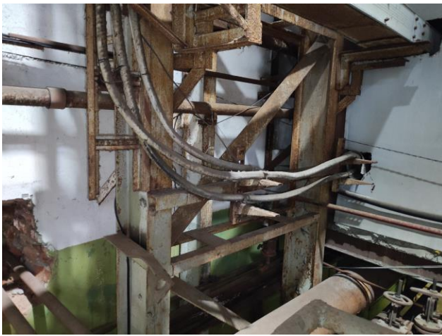
Фото 31. Продукты коррозии всех элементов конструкций колонн (включая фахверковые колонны и элементы решеток колонн).
