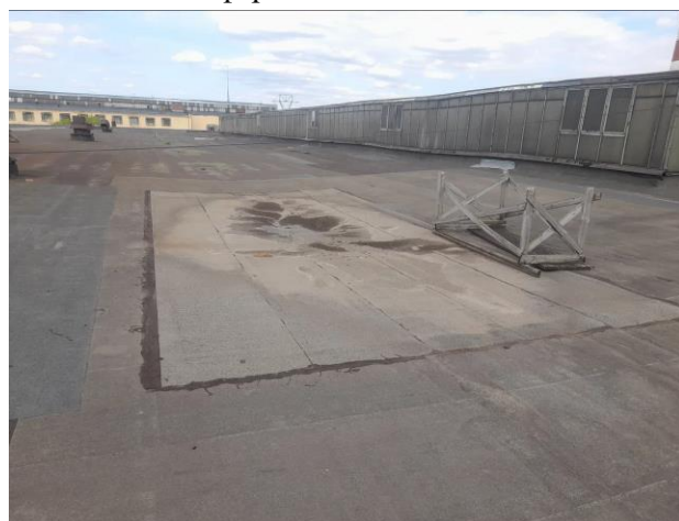
Фото 96. Следы застоев воды. Отсутствие листвоуловителя.
