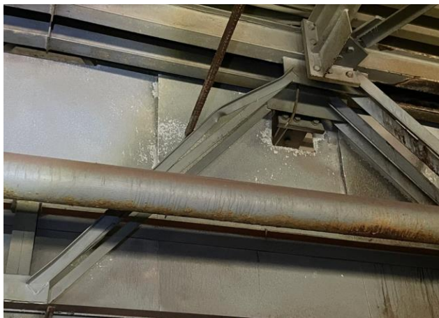
Фото 79. Деформация элемента подстропильной фермы.
