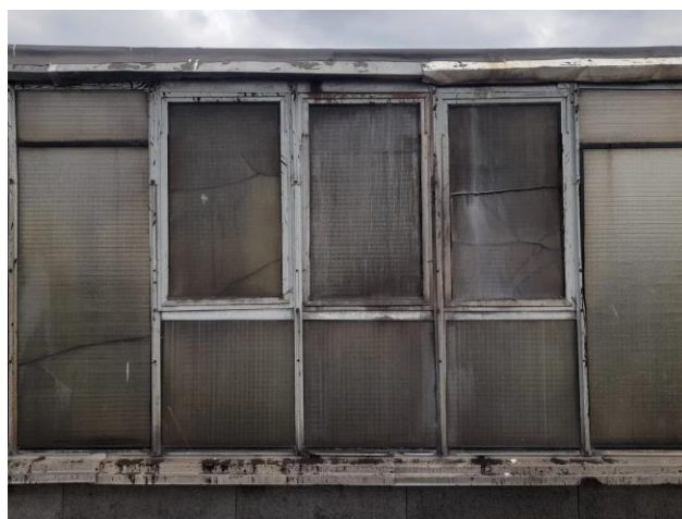
Фото 92. Трещина по остеклению фонаря.
