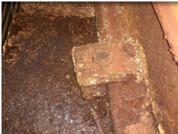
Фото 45. Пластиновая коррозия рельс, и прижимных лапок, включая болты крепления.
