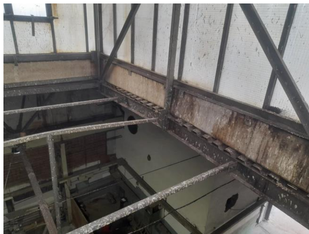
Фото 86. Механическая деформация элемента покрытия. Следы замачивания бортовых стен.
