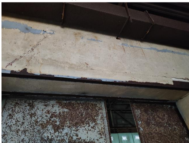
Фото 51. Коррозия всех элементов дверного блока.
