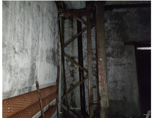
Фото 46. Следы замачивания. Растрескивание отделочного слоя. Коррозия колонн.
