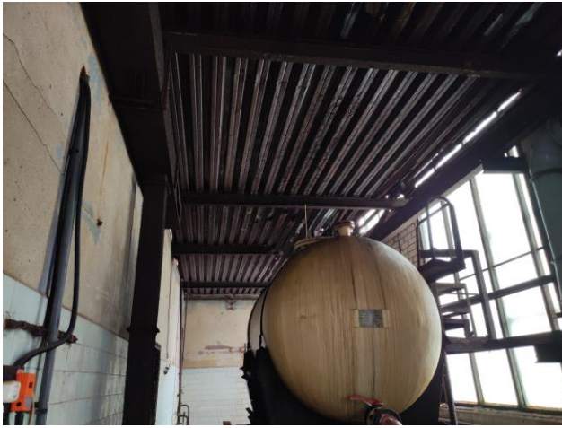
Фото 61. Пласти́нная коррозия металличе-ских балок покрытия. Полное разрушение профилированного листа. Язвенная и химическая коррозия всех элементов конструкций покрытия.
