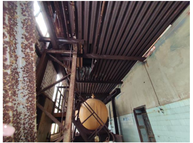
Фото 62. Пласти́нная коррозия металличе-ских балок покрытия. Полное разрушение профилированного листа. Язвенная и химическая коррозия всех элементов конструкций покрытия.
