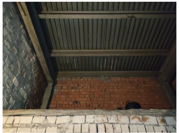
Фото 56. Вид на конструкции покрытия. Коррозия металлических элементов покрытия. Следы замачивания.
