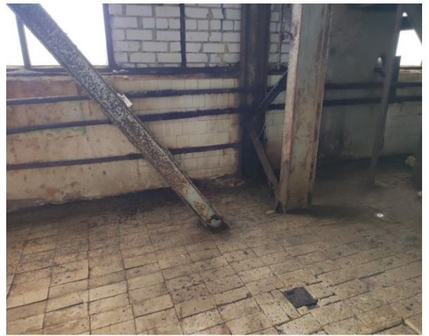
Фото 26. Химическая (газовая) коррозия элементов вертикальной связи с образованием коррозионного налета до 5 мм толщиной. Пластичная химическая (газовая) коррозия, что привело к потере сечения элементов решетки колонн до 40% и ветвей колонны до 30%.
