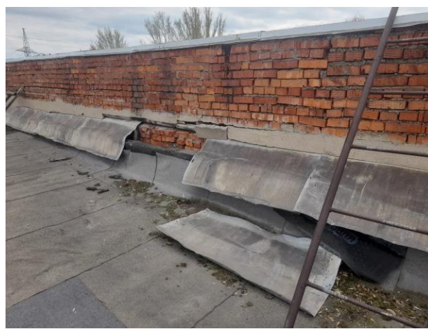
Фото 94. Отсутствие защитного листа от атмосферных осадков в месте устроенного деформационного шва.
