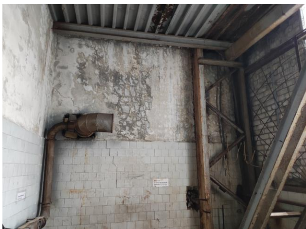
Фото 53. Вертикальная наклонная сквозная трещина по перегородке помещений.
