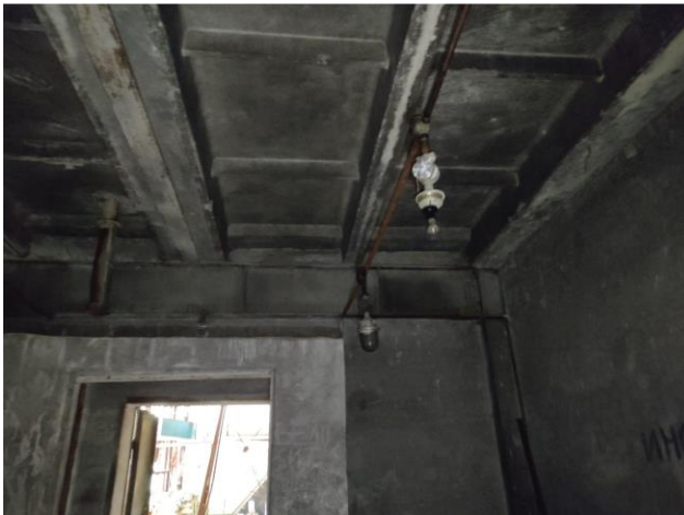
Фото 57. Вид на конструкции перекрытия. Коррозия металлических элементов перекрытия. Следы замачивания.
