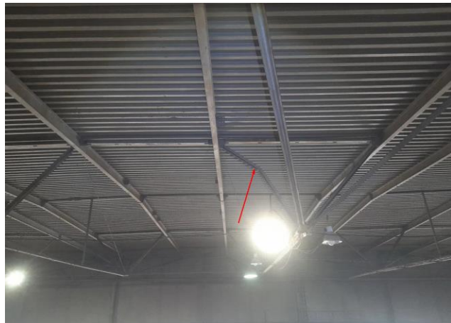
Фото 80. Деформация элемента решетки конструкции покрытия.
