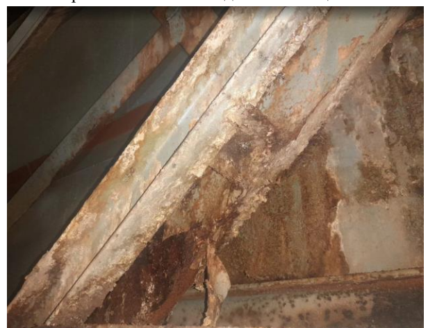
Фото 30. Продукты коррозии всех элементов вертикальных связей. Нарушение или отсутствие слоя антикоррозионной защиты всех элементов вертикальных связей.
