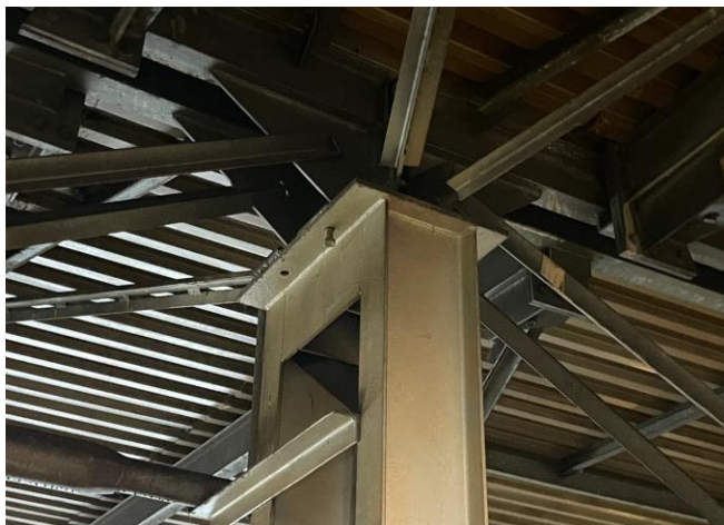
Фото 67. Узел опирания конструкций покрытия на оголовки колонны К2. Частичное отсутствие болтов. Ослабленное состояние болтов.
