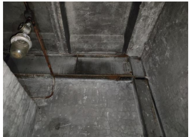
Фото 58. Вид на конструкции перекрытия. Коррозия металлических элементов перекрытия. Следы замачивания.
