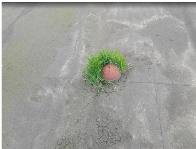
Фото 91. Произрастание растительности в месте устроенной водосточной воронки. Застой воды. Скопление промышленной пыли.
