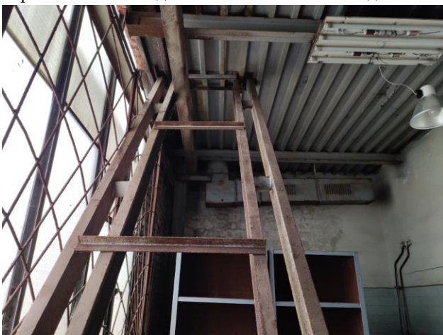
Фото 29. Продукты коррозии всех элементов вертикальных связей. Нарушение или отсутствие слоя антикоррозионной защиты всех элементов вертикальных связей.
