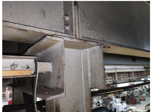
Фото 34. Узел опирания подкрановых балок на консоль колонн К-2 вдоль оси «» в осях XXXXX.
