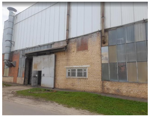
Фото 14. Отсутствие защитного фартука верха кирпичной части стены. Следы замачивания. Морозная деструкция элементов кирпичной кладки. Коррозия дверного блока включая перемычки.
