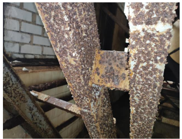
Фото 28. Химическая (газовая) коррозия элементов вертикальной связи с образованием коррозионного налета до 5 мм толщиной.
