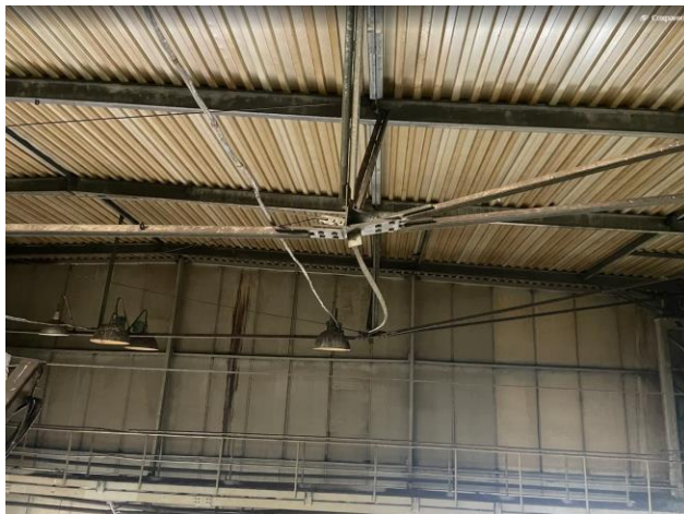
Фото 71. Выгиб элемента конструкции покрытия по нижнему поясу.
