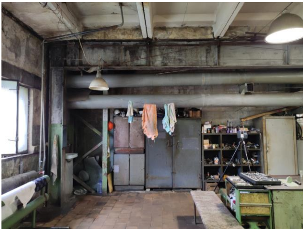
Фото 55. Вид на конструкции перекрытия. Коррозия металлических элементов перекрытия. Следы замачивания.
