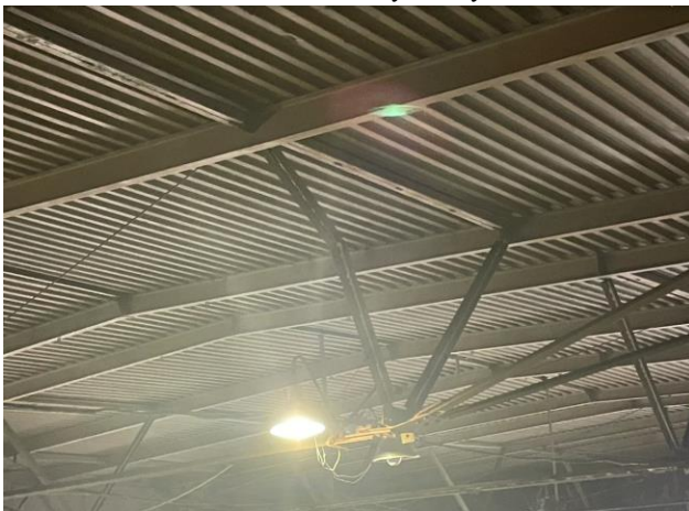
Фото 77. Деформация элемента решетки конструкции покрытия.
