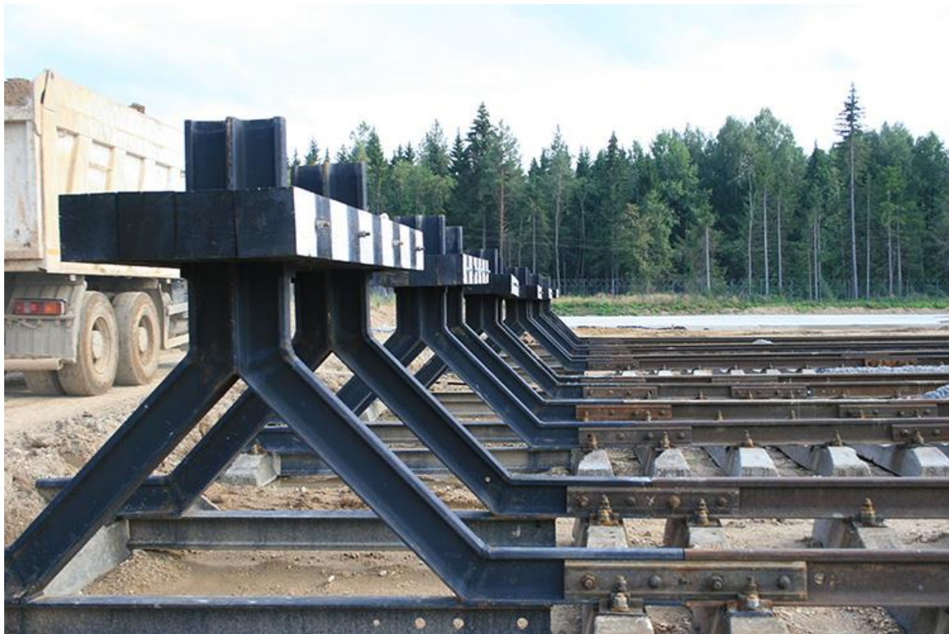
Рисунок 4.3.10.3 Фото железнодорожного тупикового упора.
