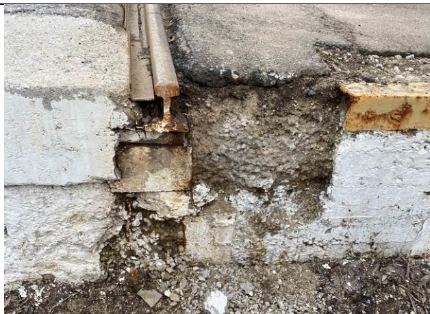
Фото 11. Частичное разрушение ж/б конструкции подпорной стены (дефект С-3)
