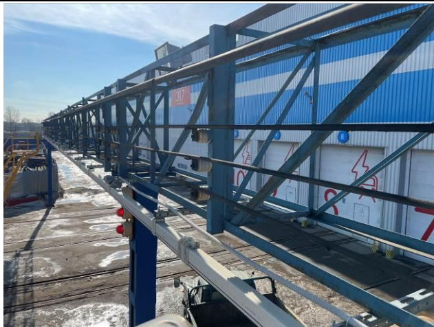
Фото 21. Общий вид траверсы троллея
