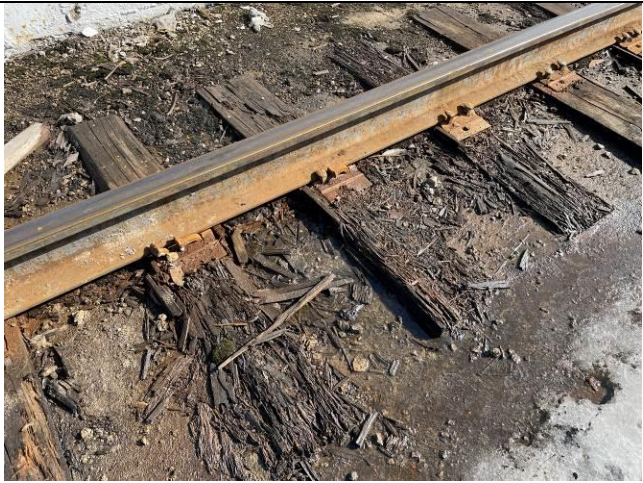
Фото 4. Поражение гнилью деревянных по- лушпал (дефект П-1)
