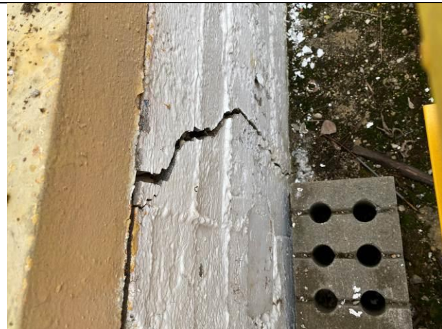
Фото 6. Сквозные трещины в ж/б конструкции подпорной стены шириной раскрытия до 10 мм (дефект С-1)
