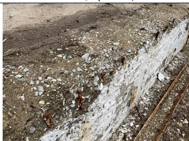
Фото 8. Разрушение защитного слоя бетона подпорной стены, оголение и коррозия арматурных стержней (дефект С-2)
