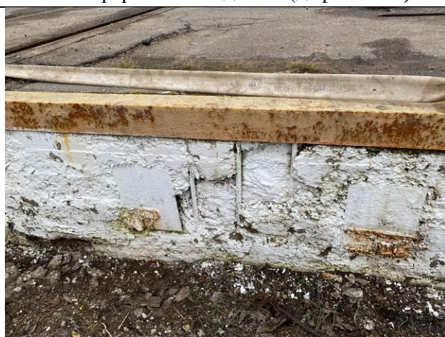
Фото 7. Разрушение защитного слоя бетона подпорной стены, оголение и коррозия арматурных стержней (дефект С-2)
