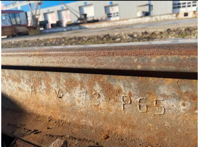
Фото 22. Маркировка рельсов, используемых в ж/д путях трансбордера
