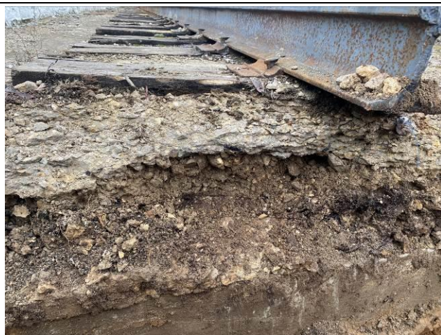
Фото 5. Следы промерзания и постоянного увлажнения монолитной бетонной подушки атмосферными осадками (дефект П-2)
