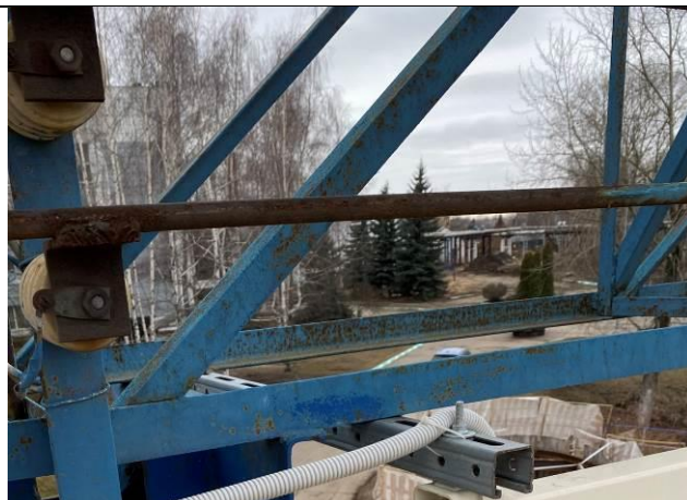
Фото 12. Отслоение лакокрасочного покрытия стальных конструкций траверсы, следы ржавчины (дефект Т-1)
