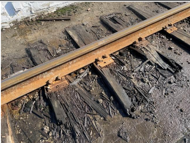
Фото 3. Поражение гнилью деревянных по- лушпал (дефект П-1)
