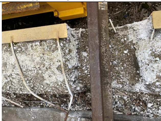
Фото 9. Частичное разрушение ж/б конструкции подпорной стены (дефект С-3)
