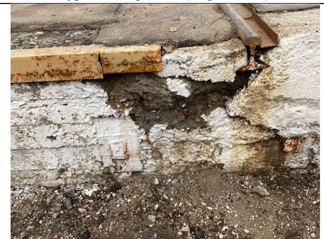
Фото 10. Частичное разрушение ж/б конструкции подпорной стены (дефект С-3)
