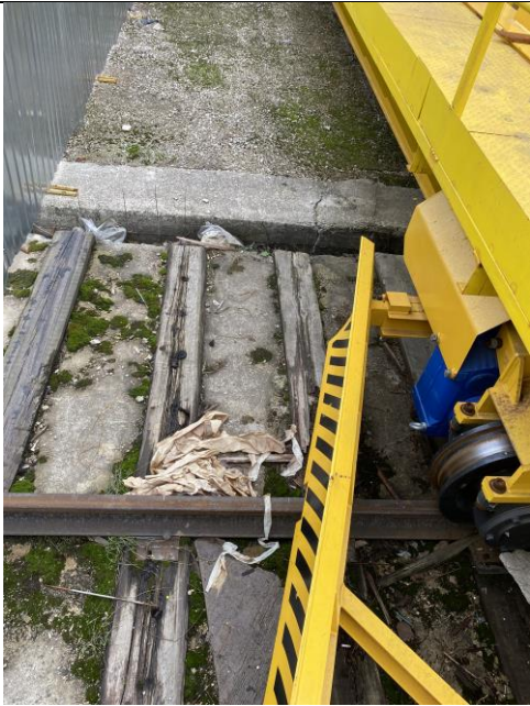
Фото 2. Трещины в ж/б конструкции плиты шириной раскрытия до 5 мм;
