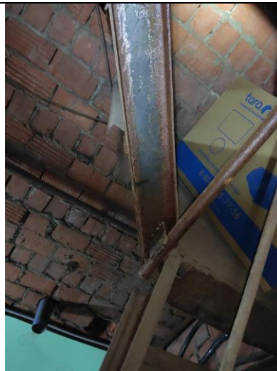
Фото 14. Коррозия металлических элементов лестниц и площадок в осях Г-Д/24-26.
