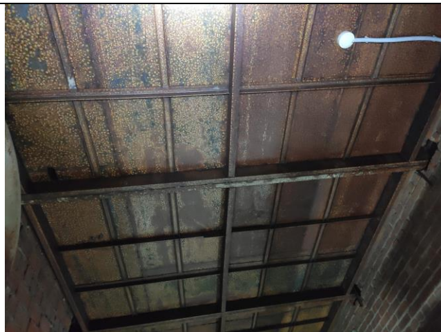
Фото 12. Коррозия металлических элементов лестниц и площадок в осях Г-Д/24-26.
