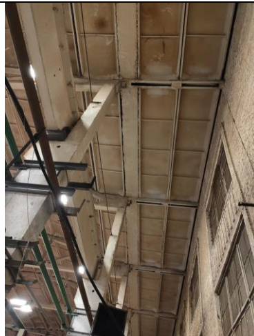
Фото 10. Следы замкания. Коррозия металлических балок покрытия. Разрушение защитного слоя бетона плит покрытия в осях Г-Д/12-14.
