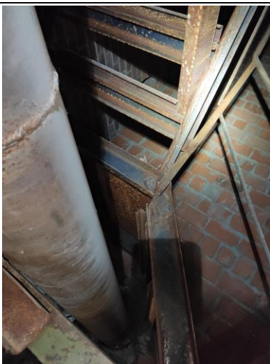
Фото 13. Коррозия металлических элементов лестниц и площадок в осях Г-Д/24-26.
