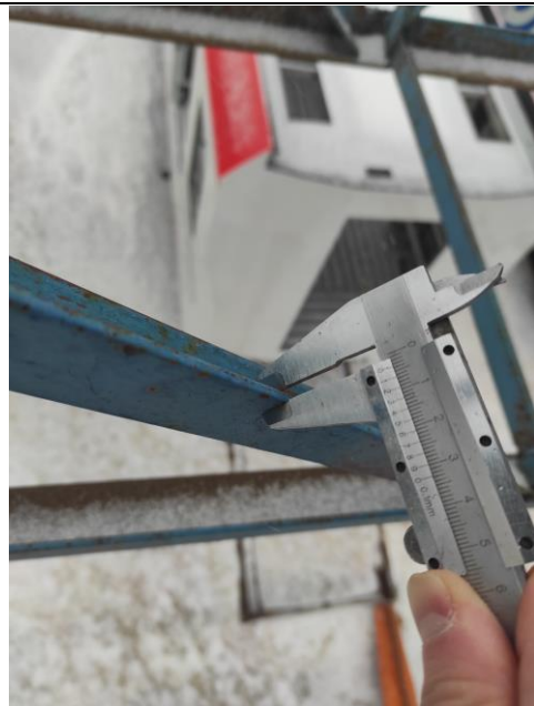
Фото 8. Измерение толщины уголка раскоса фермы.
