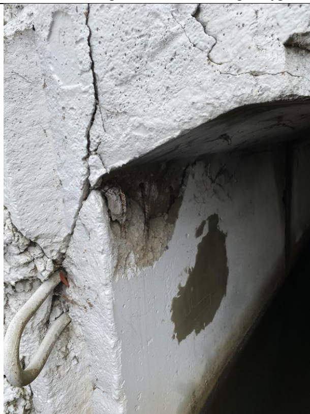
Фото 25. Трещины и разрушение бетона в узле примыкания стенки оголовочного звена коллектора.
