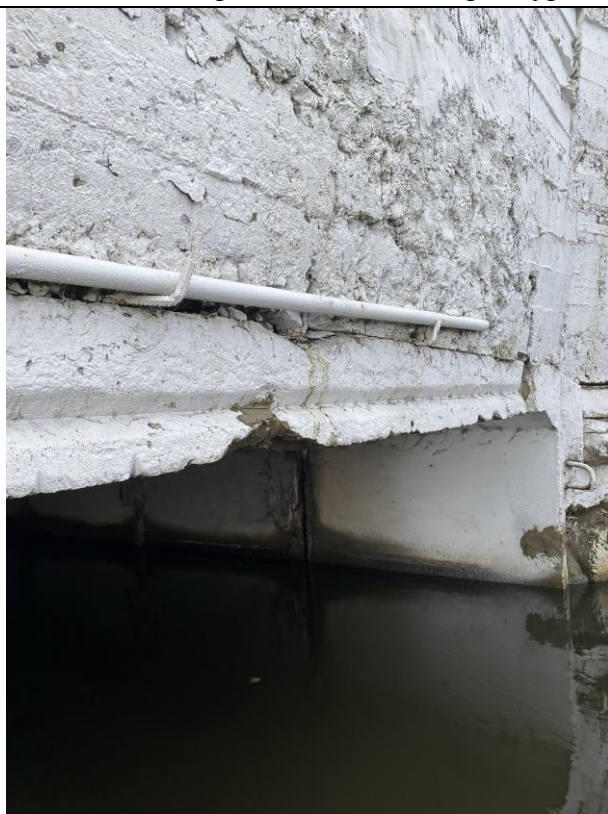
Фото 26. Разрушение защитного слоя бетона плиты перекрытия оголовочного звена коллектора.
