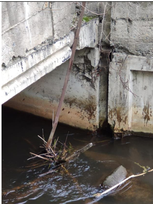
Фото 24. Разрушение защитного слоя бетона стен коллектора с обнажением арматуры.
