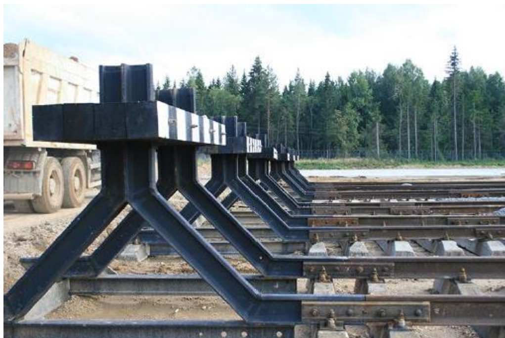
Рисунок 23. Фото железнодорожного тупикового упора.
