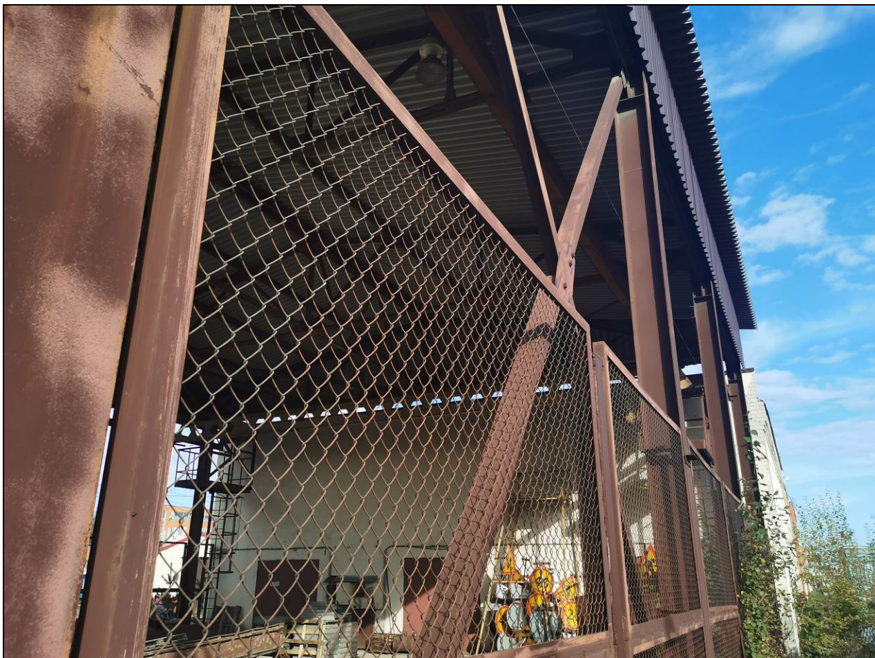
Фото 13. Литер Л1. Поверхностная коррозия стенового ограждения
