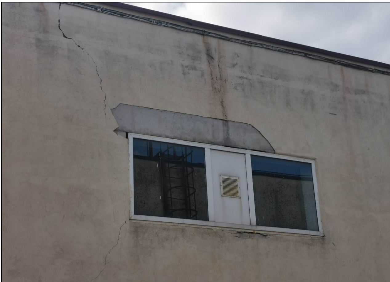
Фото 1. Литер Л. Трещины шириной раскрытия до 2-3мм в стене по оси 1, повреждение наружной отделки
