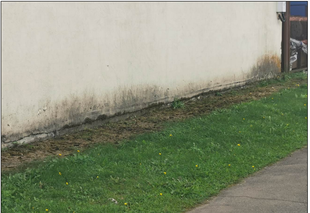
Фото 6. Литер Л. Характерные повреждения конструкций отмостки
