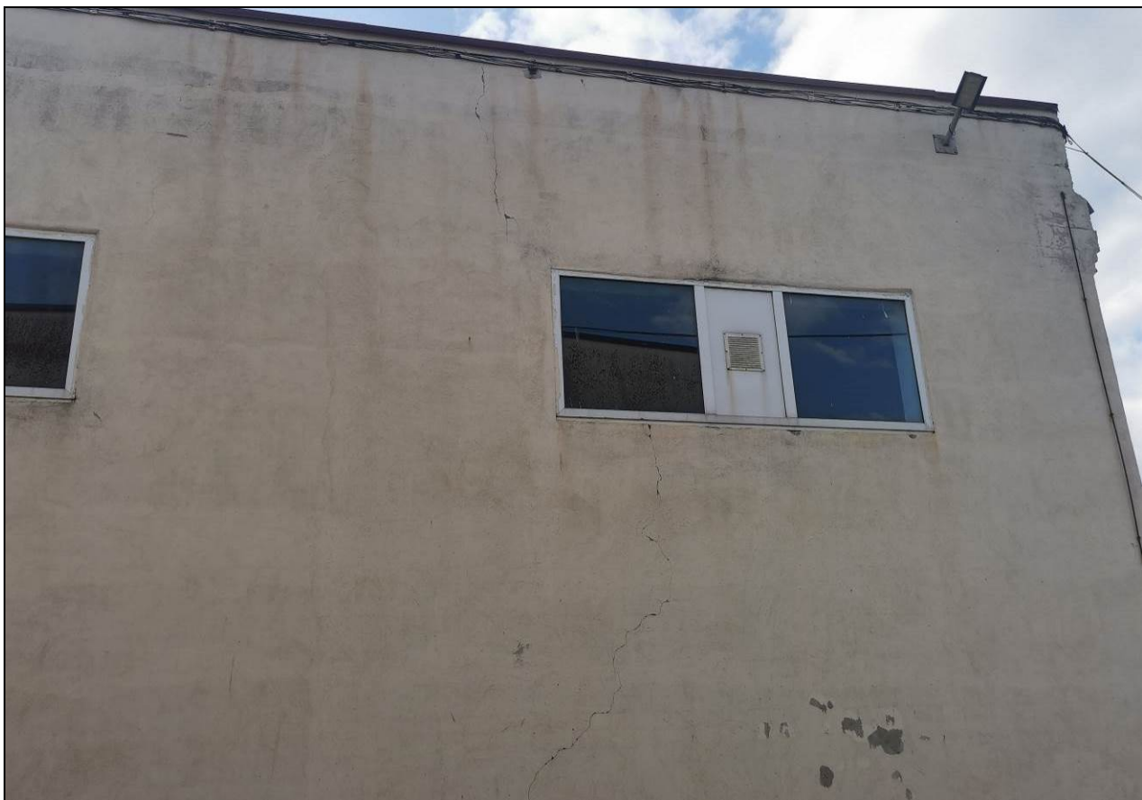
Фото 2. Литер Л. Трещины шириной раскрытия до 2-3мм в стене по оси 1
