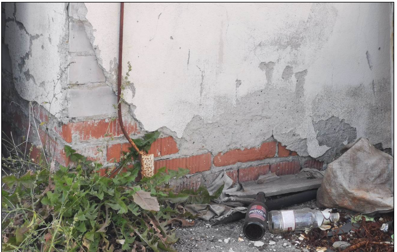
Фото 8. Литер Л. Характерные повреждения наружной отделки
