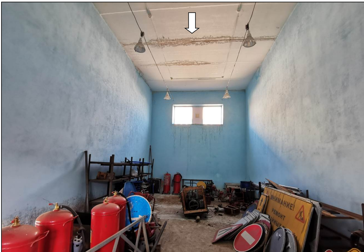
Фото 3. Литер Л. Следы увлажнения по нижней поверхности плит покрытия
