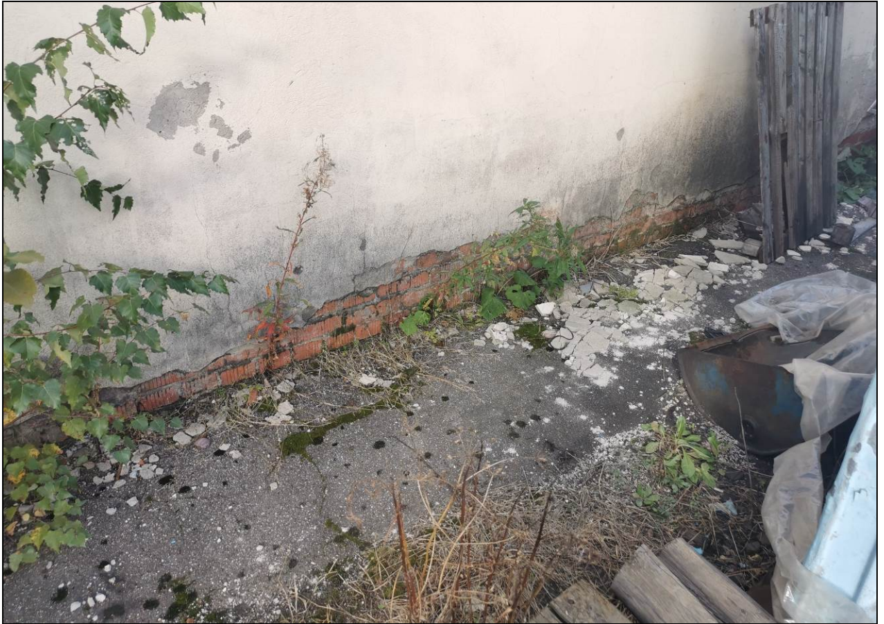
Фото 5. Литер Л. Характерные повреждения конструкций отмостки
