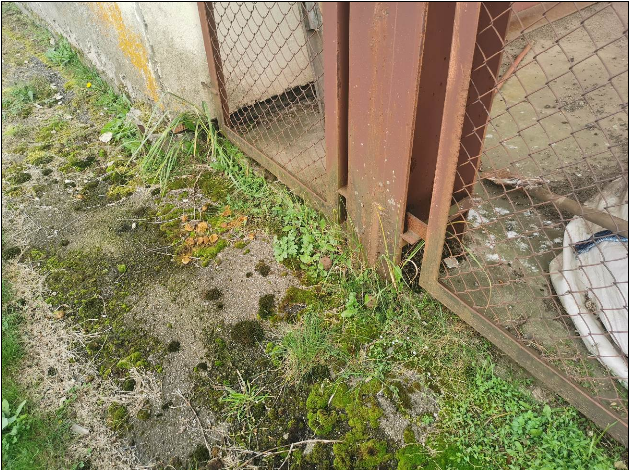
Фото 12. Литер Л1. Характерные повреждения конструкций отмостки
