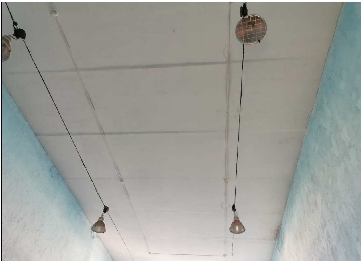
Фото 9. Литер Л. Вид осветительных приборов и датчиков пожарной сигнализации
