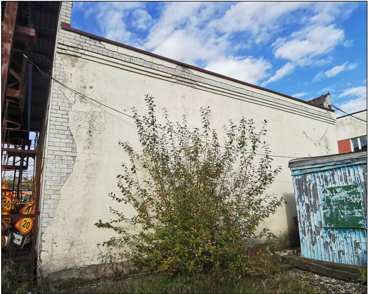
Фото 7. Литер Л. Характерные повреждения наружной отделки
