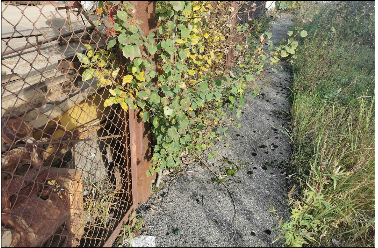
Фото 11. Литер Л1. Характерные повреждения конструкций отмостки
