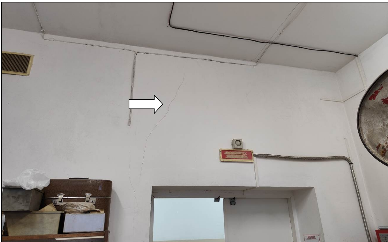
Фото 2. Литер М. Трещина шириной раскрытия 1-2мм в стене по оси Б/А в уровне 1-го этажа
