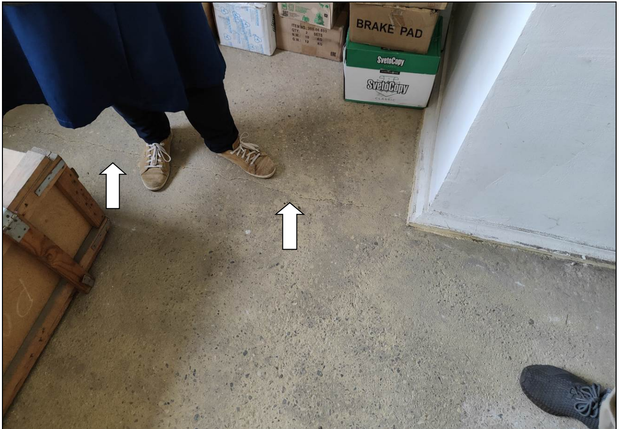
Фото 10. Литер М. Трещина по покрытию пола
