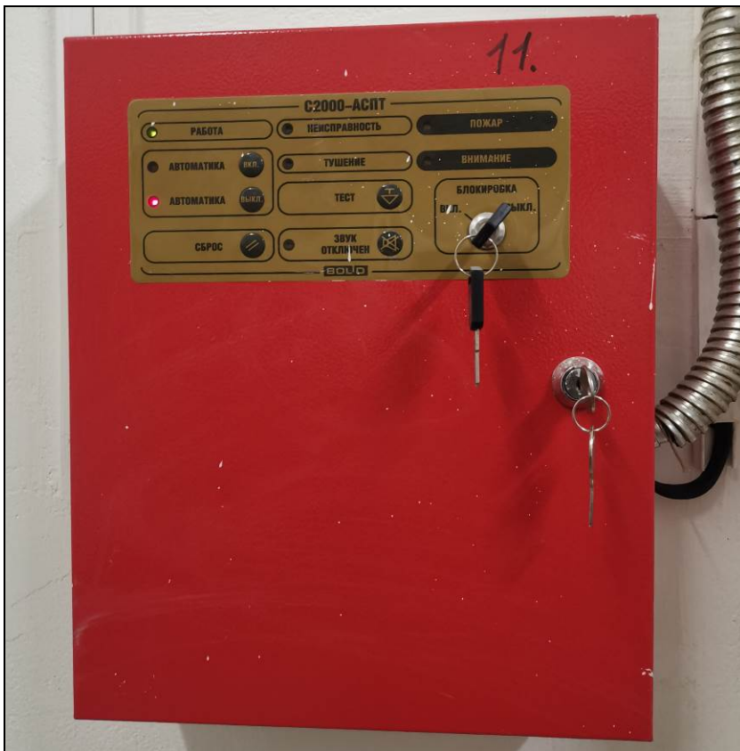
Фото 19. Литер М. Вид блока управления ПС
