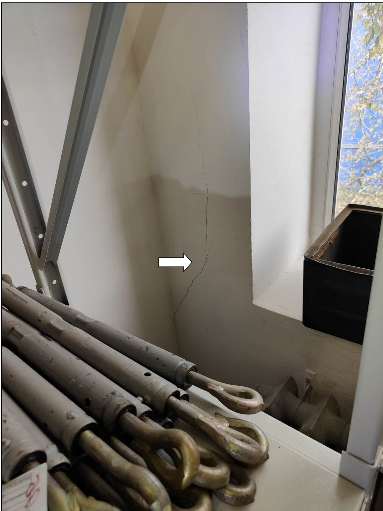
Фото 1. Литер М. Трещины шириной раскрытия 1-2мм в стене по оси А в уровне 1-го этажа
