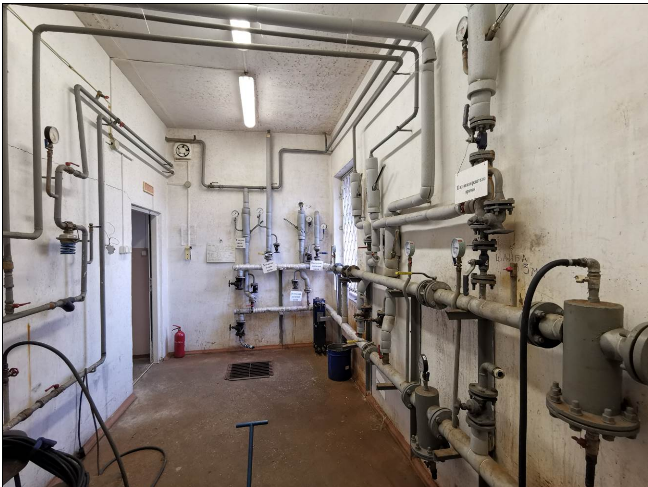
Фото 14. Литер М. Вид оборудования ИТП
