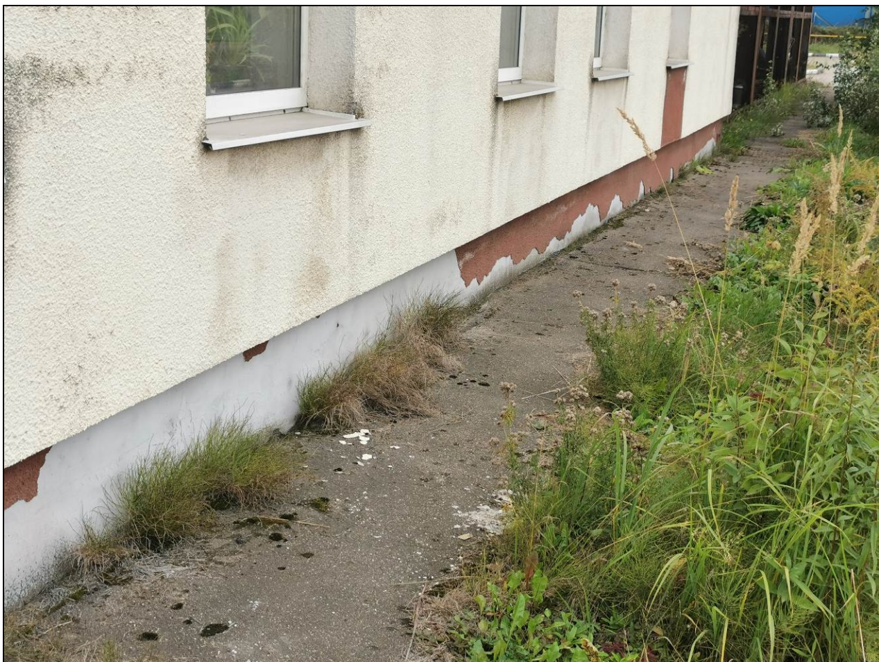
Фото 9. Литер М. Характерные повреждения конструкций отмостки (по оси А)
