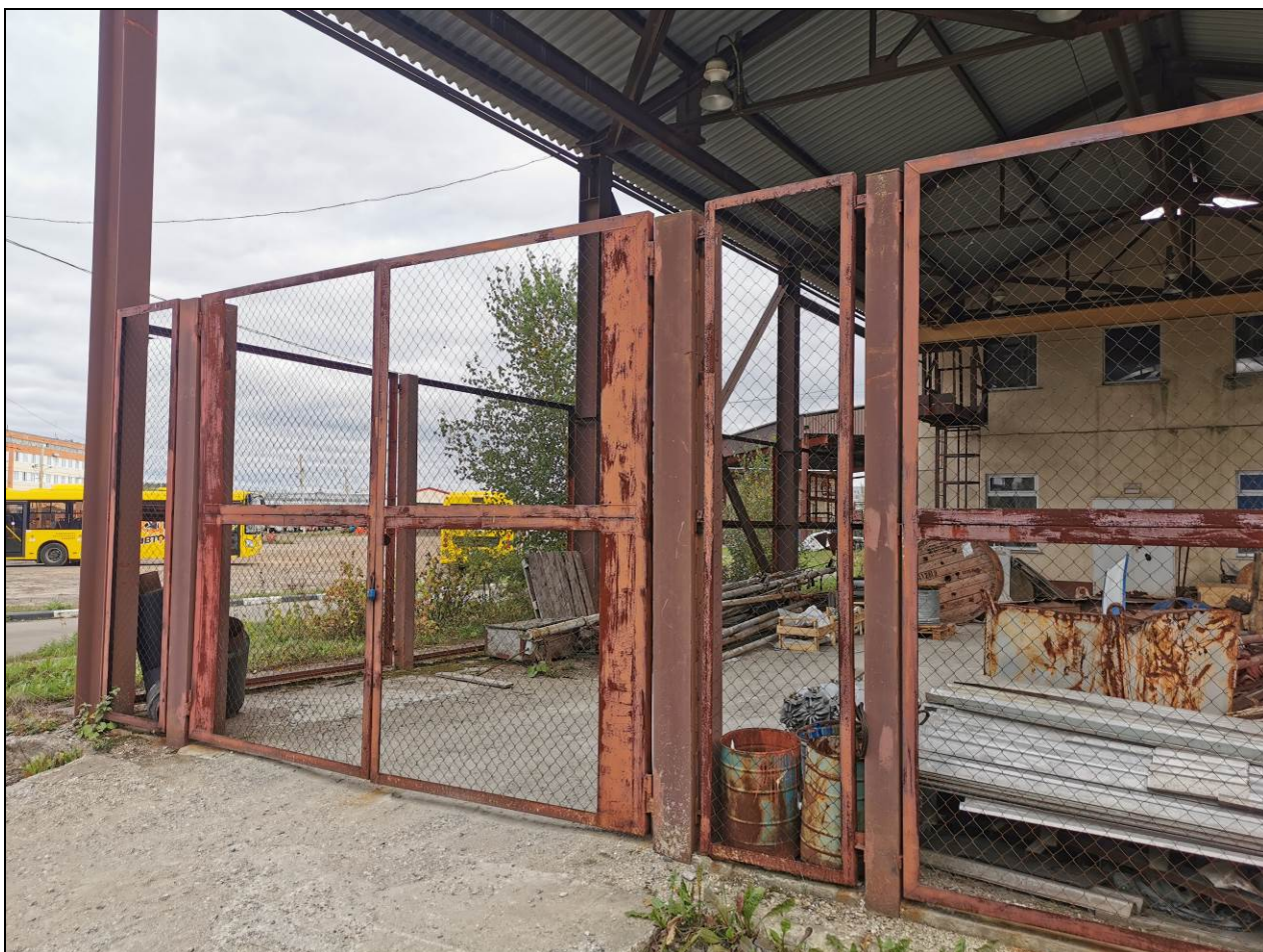
Фото 24. Литер М1. Поверхностная коррозия стенового ограждения
