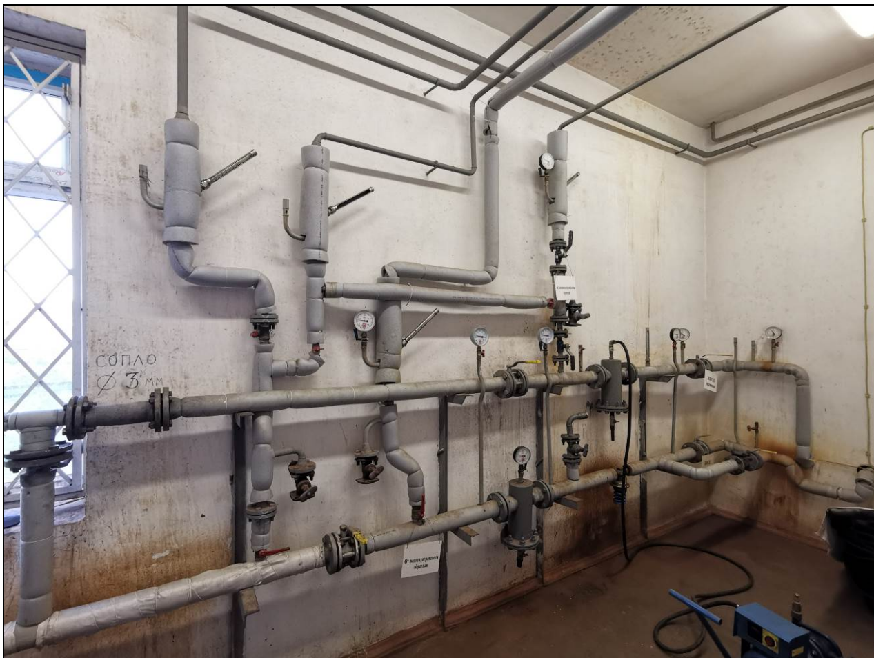
Фото 13. Литер М. Вид оборудования ИТП
