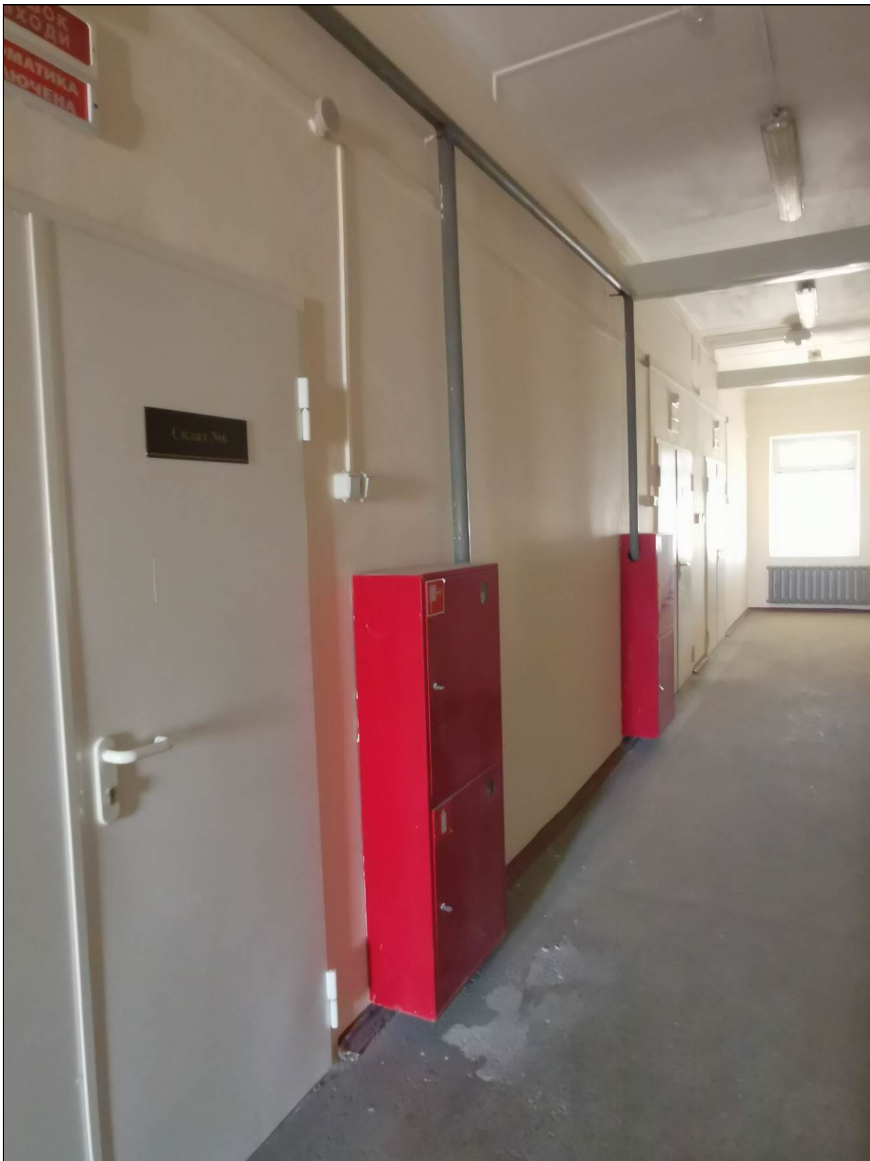
Фото 16. Литер М. Вид пожарных шкафов
