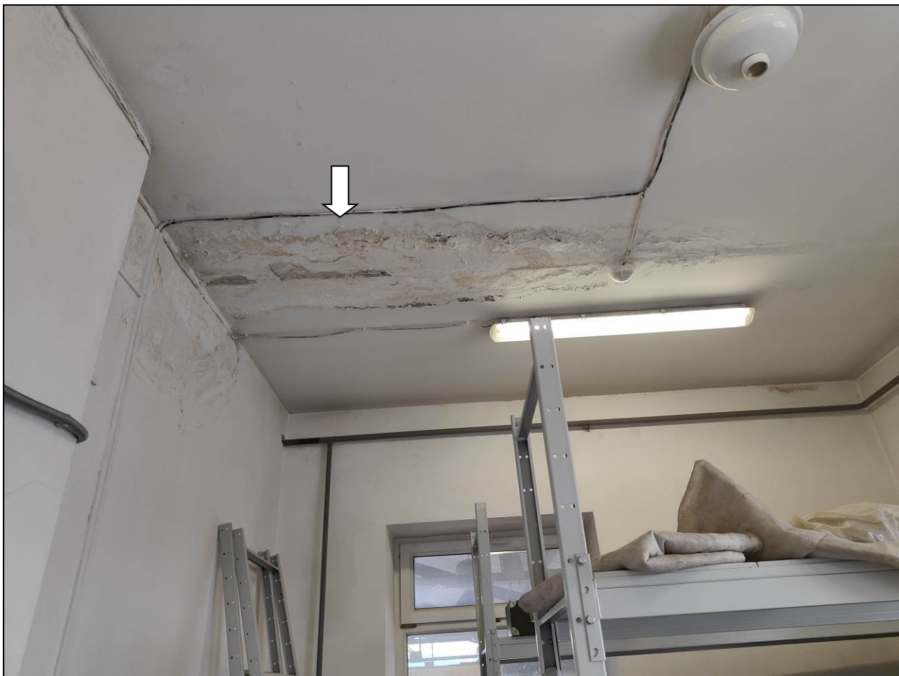
Фото 6. Литер М. Следы увлажнения по нижней поверхности плит покрытия
