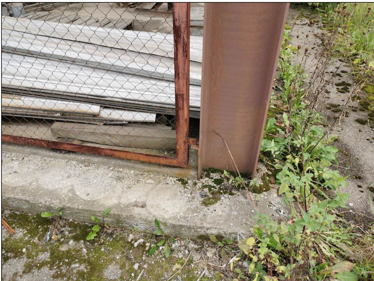
Фото 22. Литер М1. Характерные повреждения конструкций отмостки
