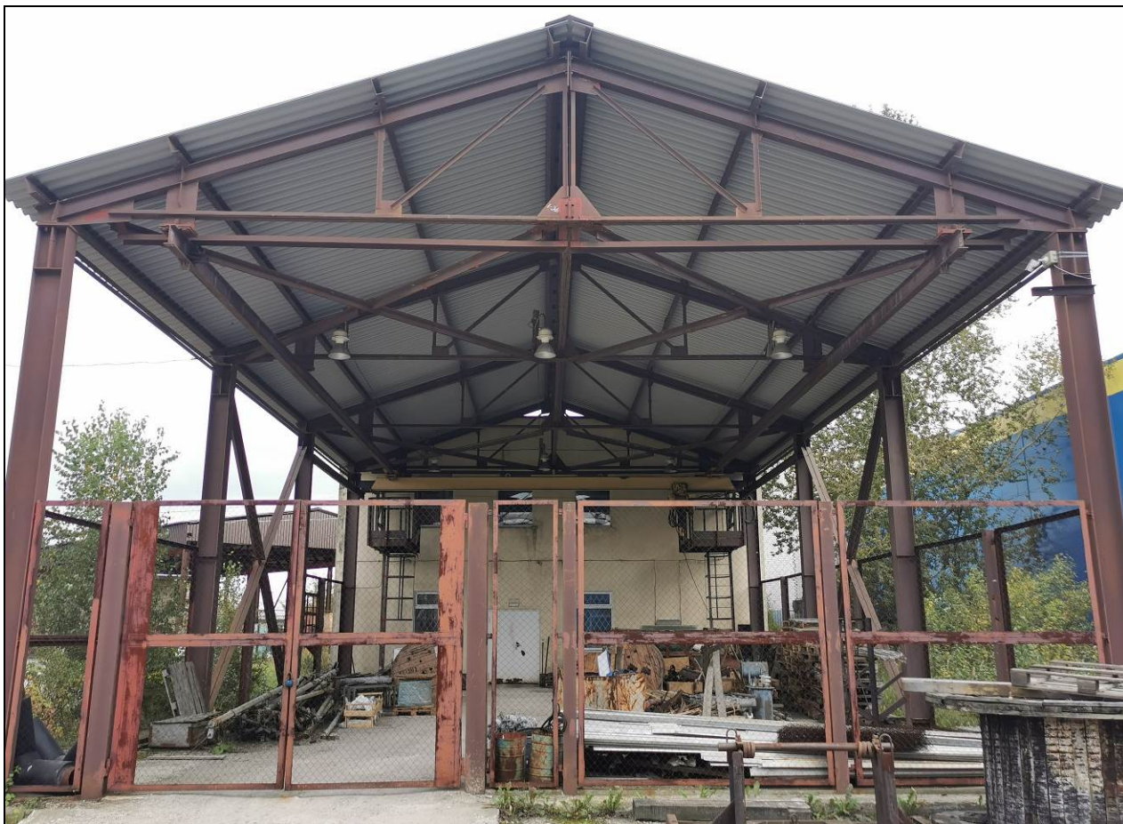
Фото 20. Литер М1. Поверхностная коррозия колонн каркаса, ферм покрытия, связей по каркасу и покрытию, ограждения
