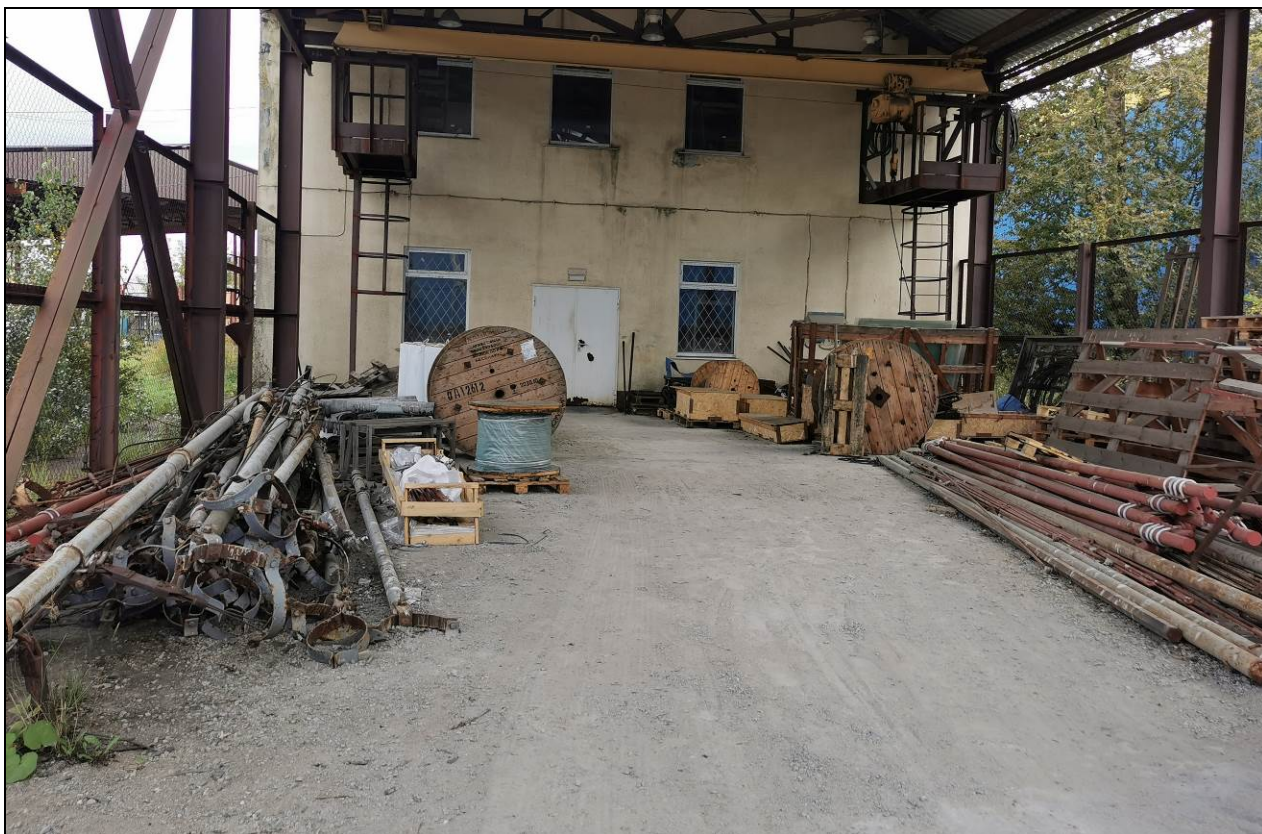
Фото 23. Литер М1. Характерные повреждения покрытия полов (размораживание верхнего слоя на глубину до 10-15мм)
