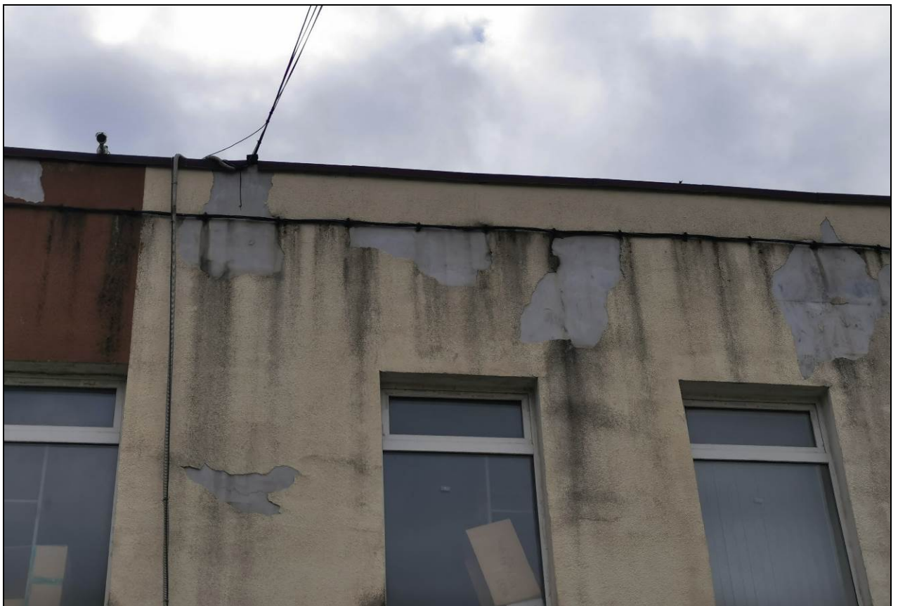
Фото 11. Литер М. Характерные повреждения наружной отделки
