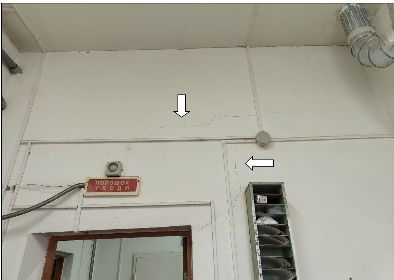
Фото 5. Литер М. Трещины по перегородкам в уровне 1-го этажа
