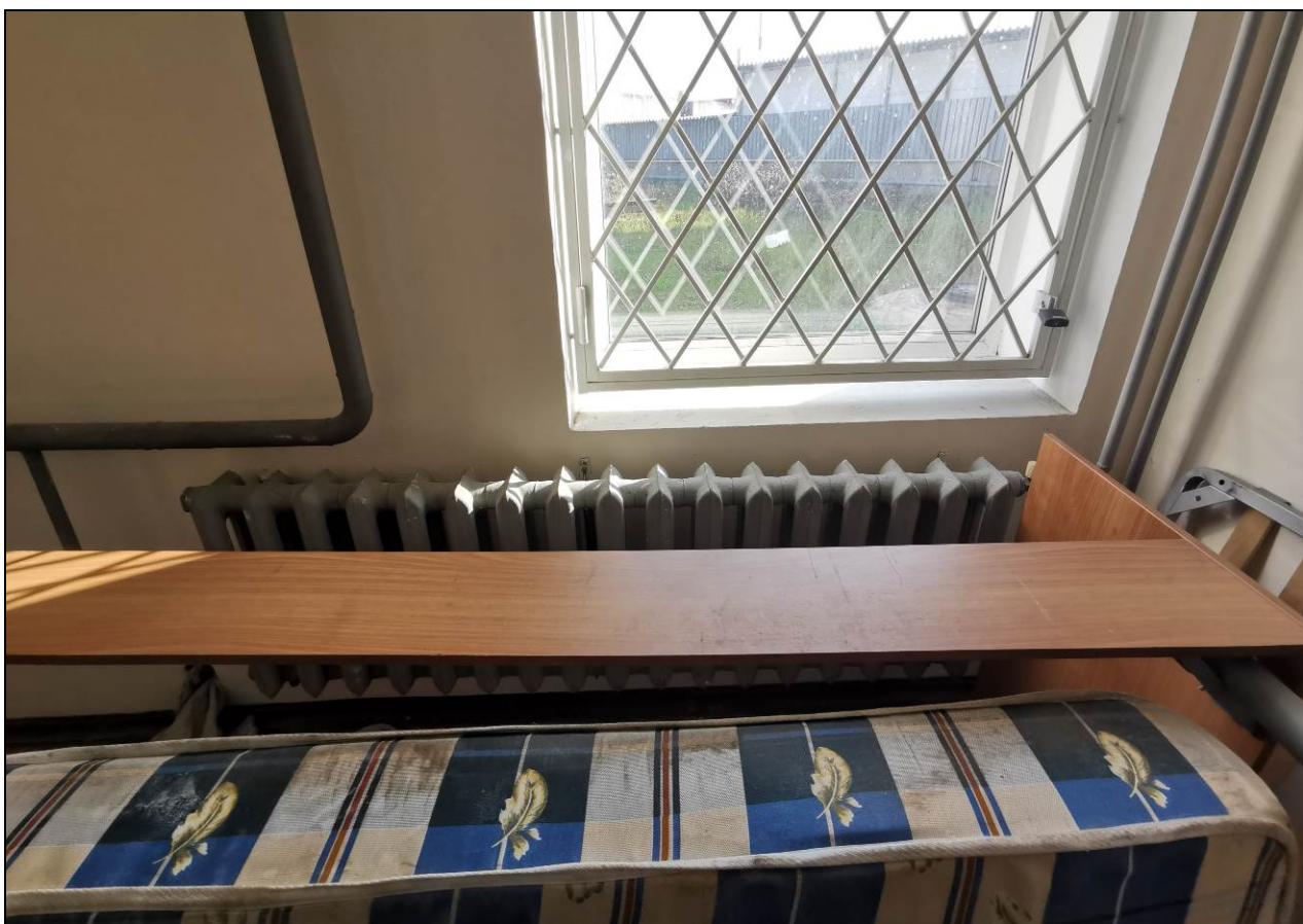
Фото 15. Литер М. Вид радиаторов системы отопления
