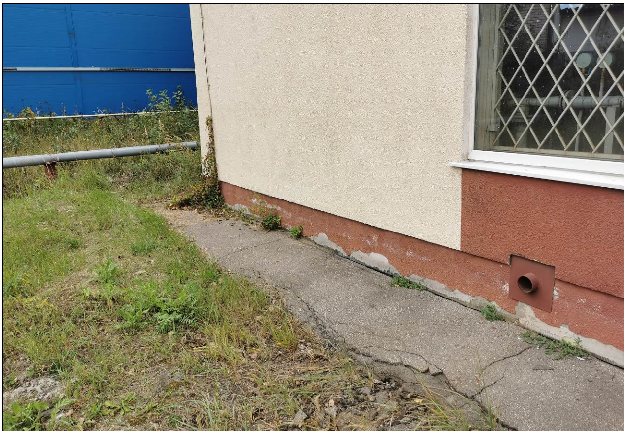
Фото 8. Литер М. Характерные повреждения конструкций отмостки (по оси 1)
