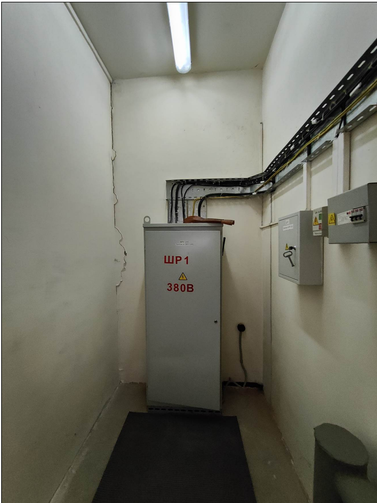
Фото 17. Литер М. Вид помещения электрощитовой
