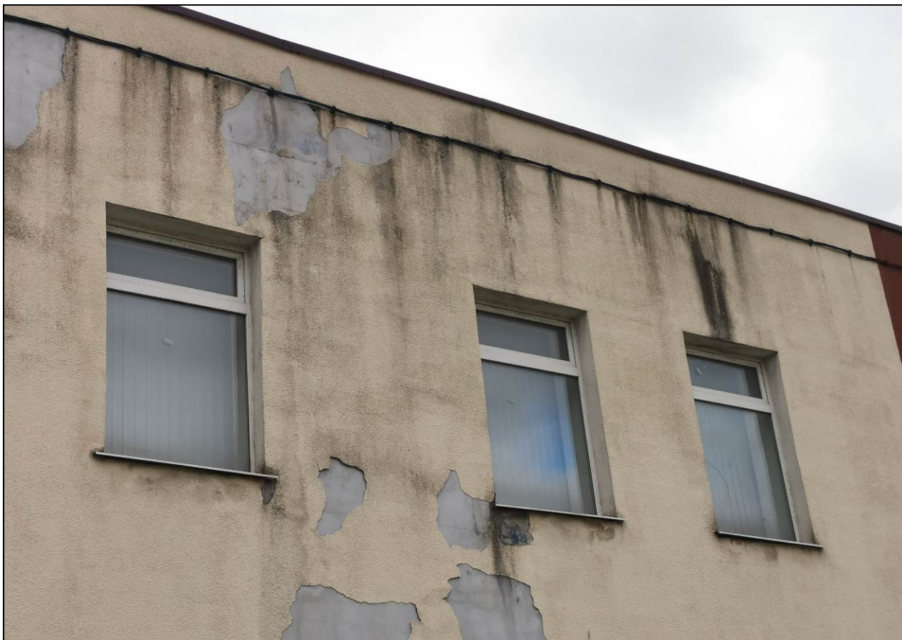
Фото 12. Литер М. Характерные повреждения наружной отделки
