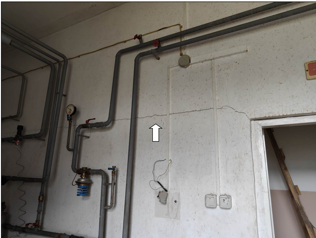
Фото 4. Литер М. Трещины по перегородкам в уровне 1-го этажа (помещение теплового пункта)
