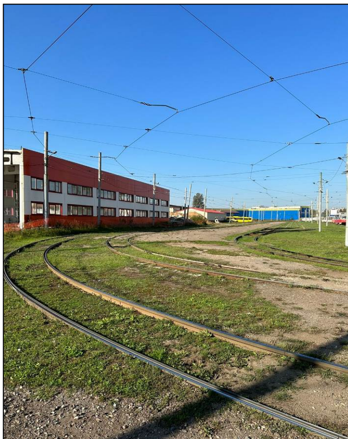
Фото 1. Общий вид трамвайного пути и контактной сети на территории депо. Участки поворотов
