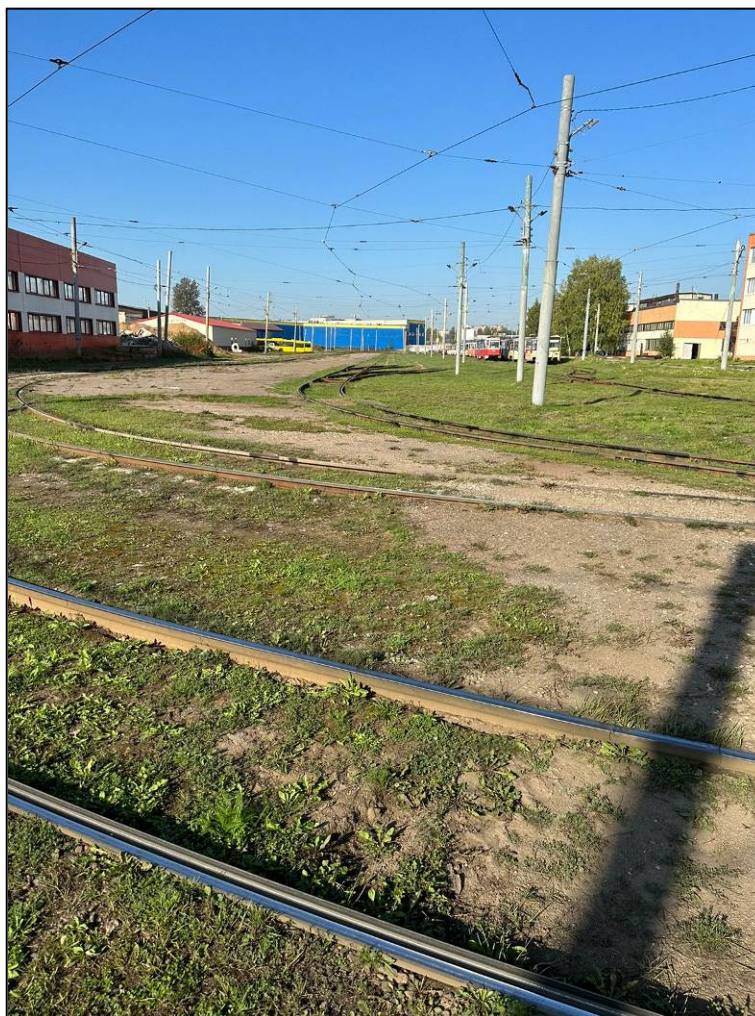
Фото 5. Общий вид трамвайного пути и контактной сети на территории депо. Визуально отмечаемые крены опор контактной сети
