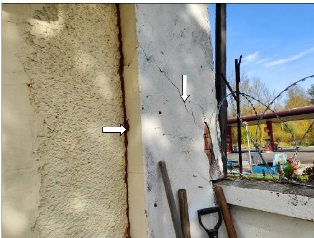
Фото 2.4. Наклонная трещина в колонне Ах2, раскрытие шва между стеновой панелью и кирпичной колонной (шов заполнен монтажной пеной)
