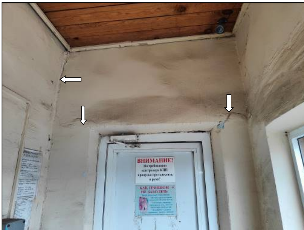
Фото 1.5. Вертикальные и наклонные трещины в стене по оси 2
