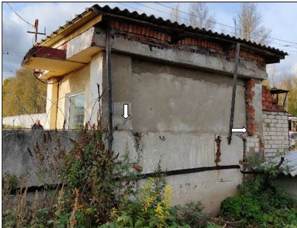
Фото 2.2. Общий вид фасада А-Б, колонны по оси 2 частично опираются на панели ограждения территории и имеют повреждения в виде трещин вследствие неравномерных осадок конструкций
