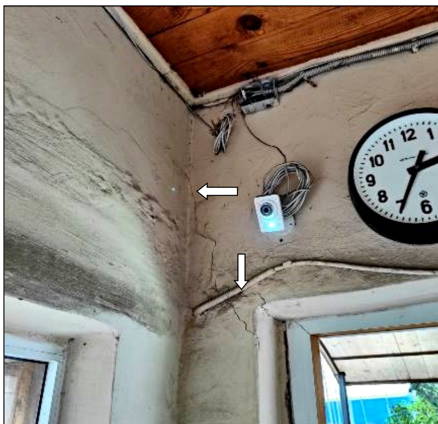
Фото 1.6. Вертикальные и наклонные трещины в стене по оси 1
