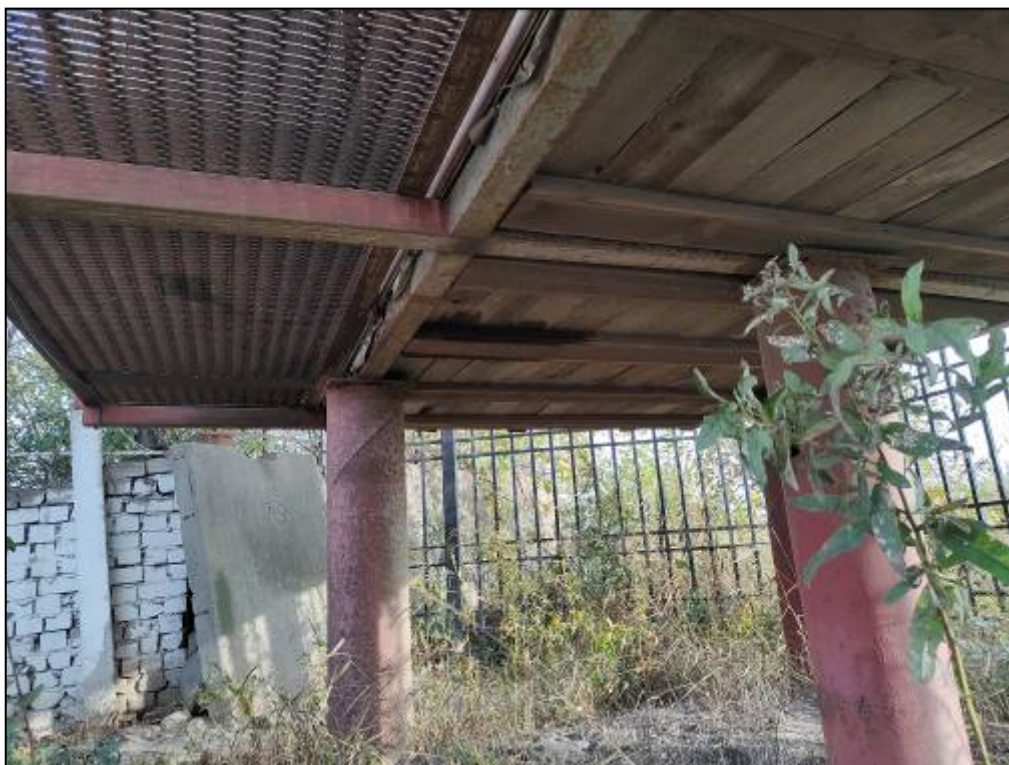
Фото 3.3 Общий вид конструкций стоек несущего основания здания. Отмечена поверхностная коррозия стоек, металлического ростверка и элементов площадки
