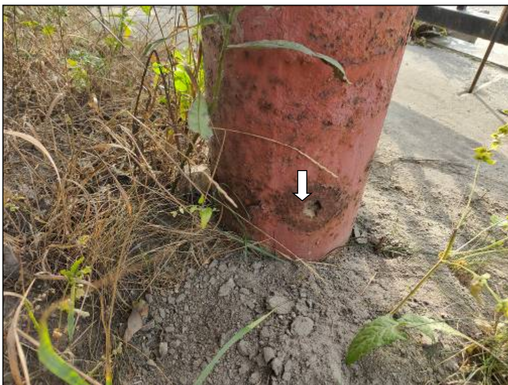
Фото 3.4. Участок сквозной слоистой коррозии металла стойки несущего основания здания
