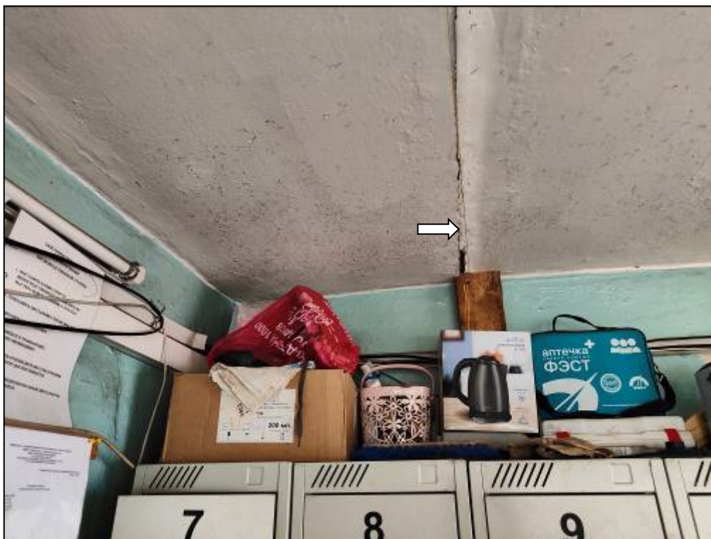
Фото 1.7. Раскрытие швов между плитами покрытия,высыпание раствора из швов
