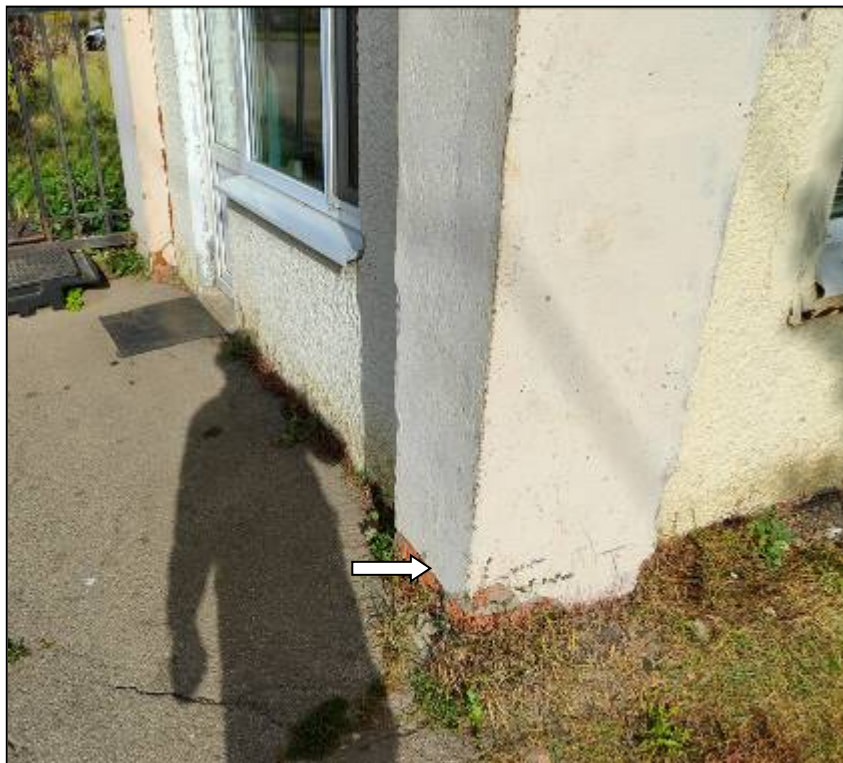
Фото 2.5. Разрушение кирпичной кладки в зоне систематического ее увлажнения
