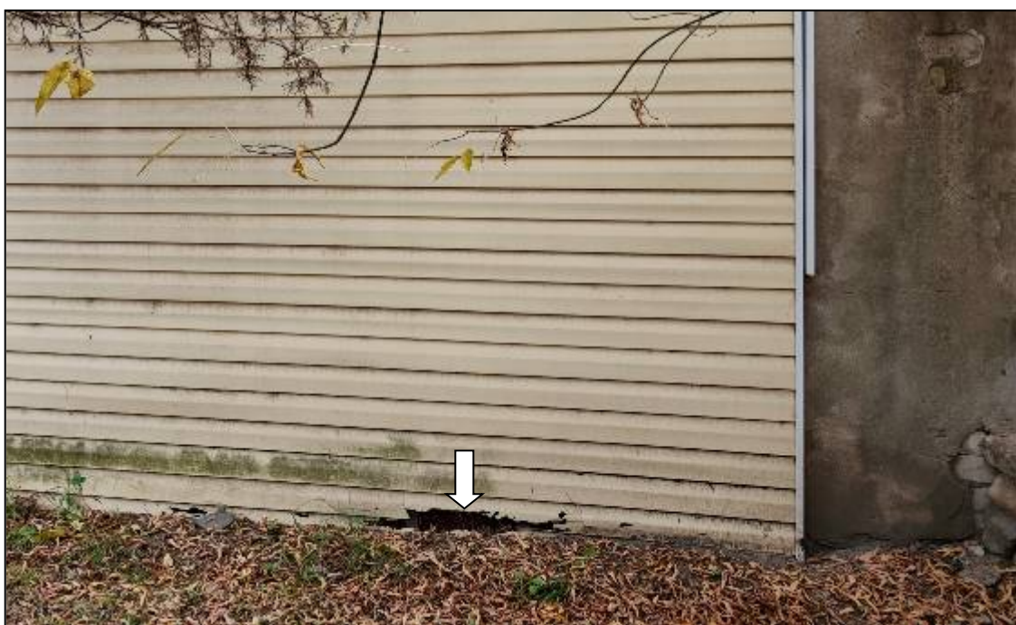
Фото 1.8. Повреждение панели обшивки фасада, участок систематического увлажнения стены по оси Б вследствие контруклона и скопления влаги у стены
