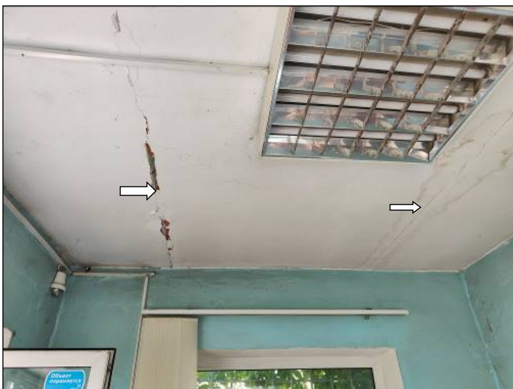
Фото 2.6. Раскрытие шва между плитами покрытия, высыпание раствора из шва, участок систематического увлажнения поверхности плиты вследствие течи кровли
