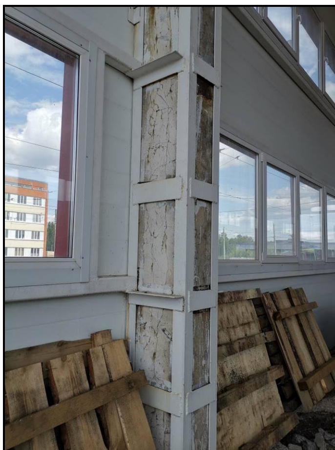
Фото 6.3.6. Трещины шириной раскрытия до 1мм вдоль рабочей арматуры
