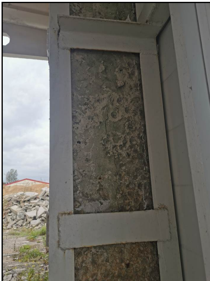
Фото 6.3.5. Трещина шириной раскрытия до 1мм вдоль рабочей арматуры
