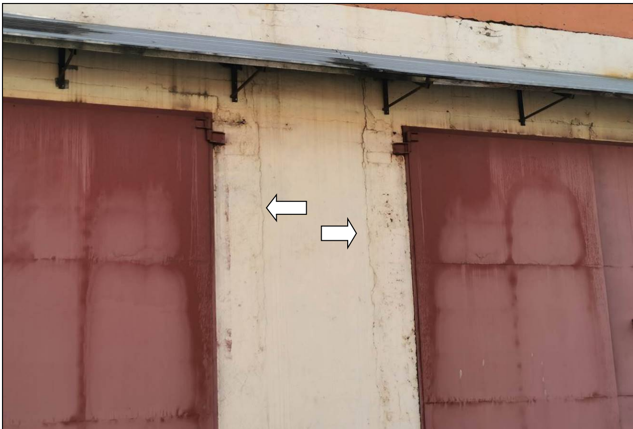
Фото 9. Трещины шириной раскрытия 1-2мм по стыку стеновой панели и участков кирпичной кладки по периметру ворот
