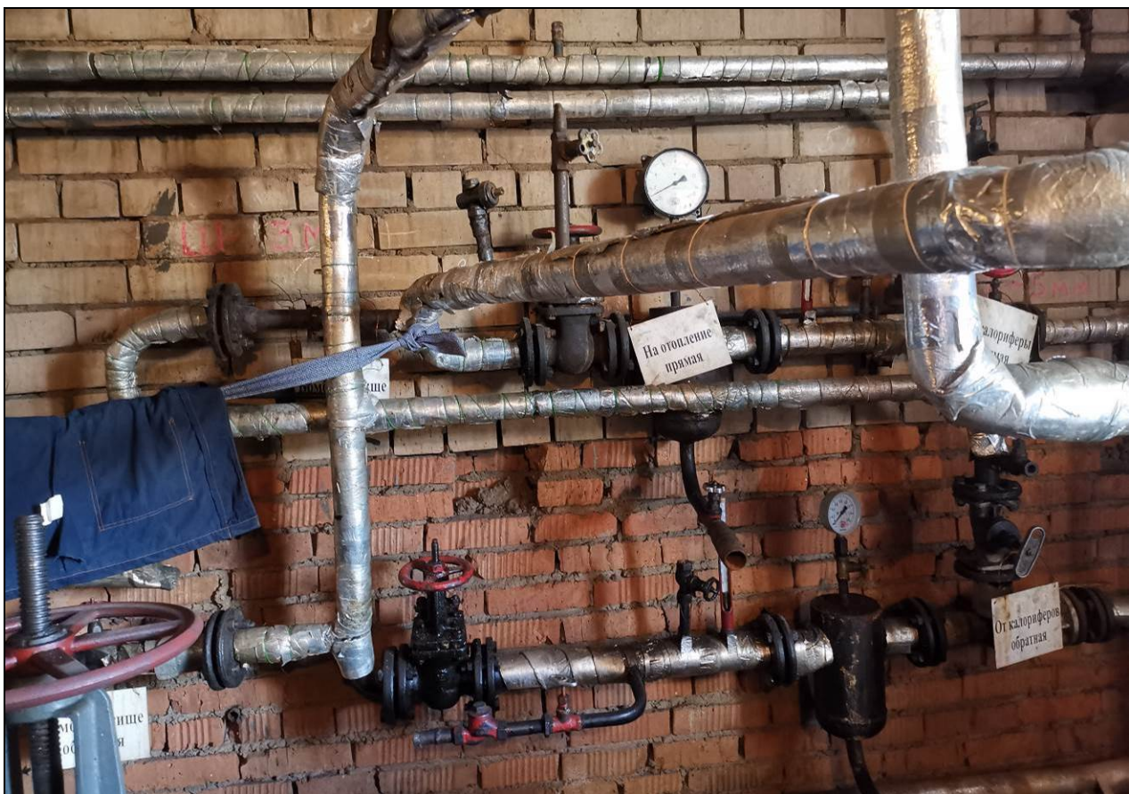
Фото 33. Вид оборудования теплового пункта
