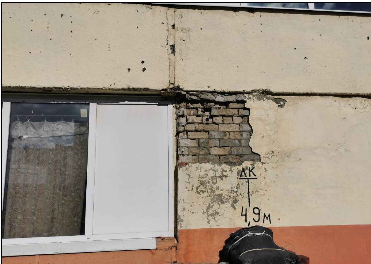
Фото 10. Локальный участок деструкции кирпичной кладки по оси В/3-2
