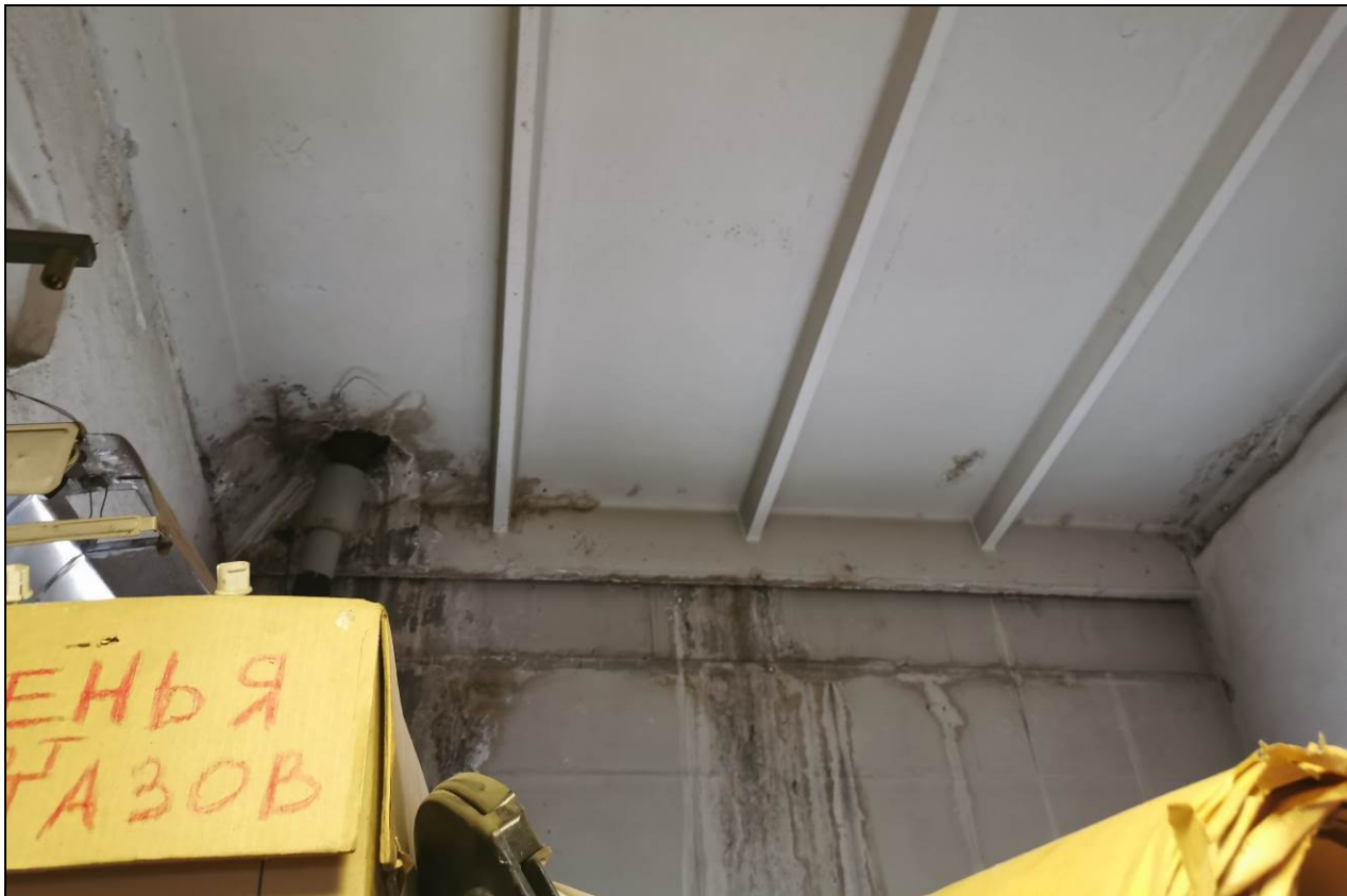
Фото 21. Локальные участки повреждения внутренней отделки
