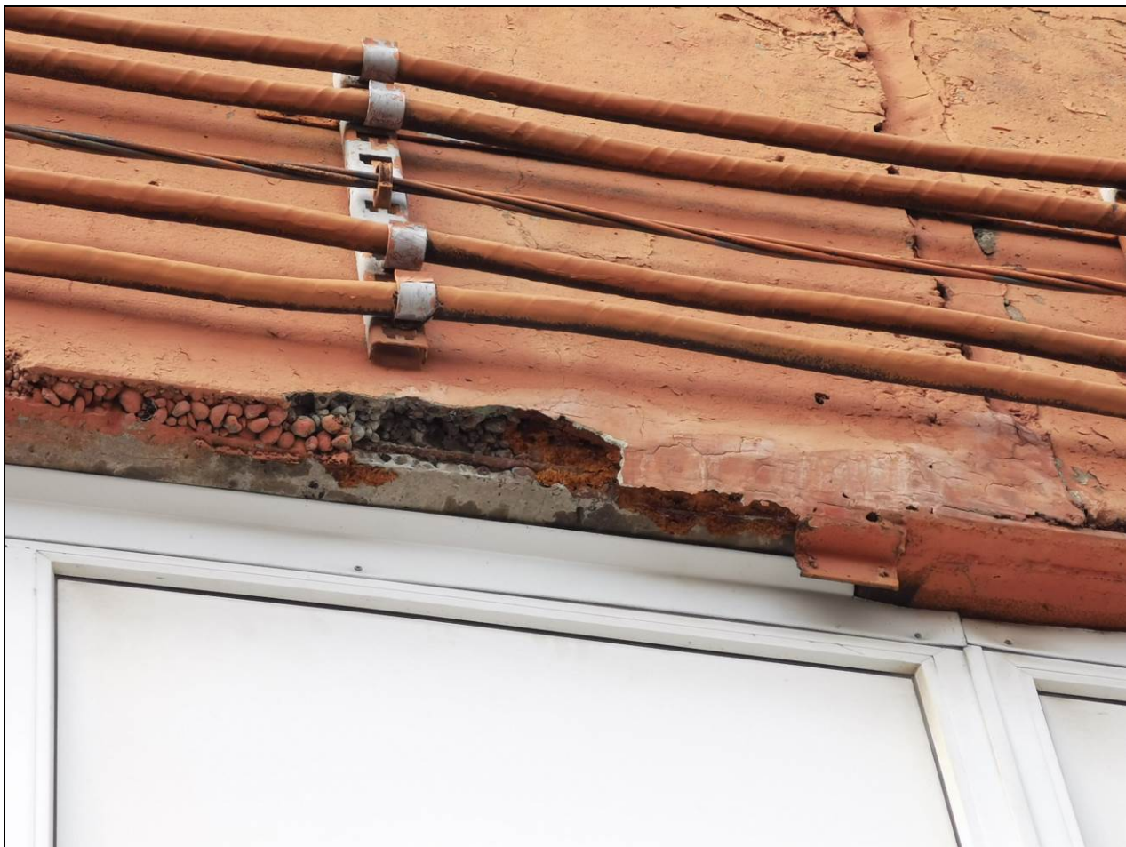
Фото 5. Повреждение защитного слоя бетона стеновой панели по оси 1/Б-В (над оконным проемом)
