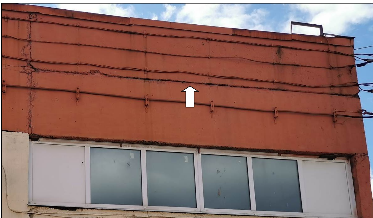
Фото 8. Повреждения заполнения межпанельных швов
