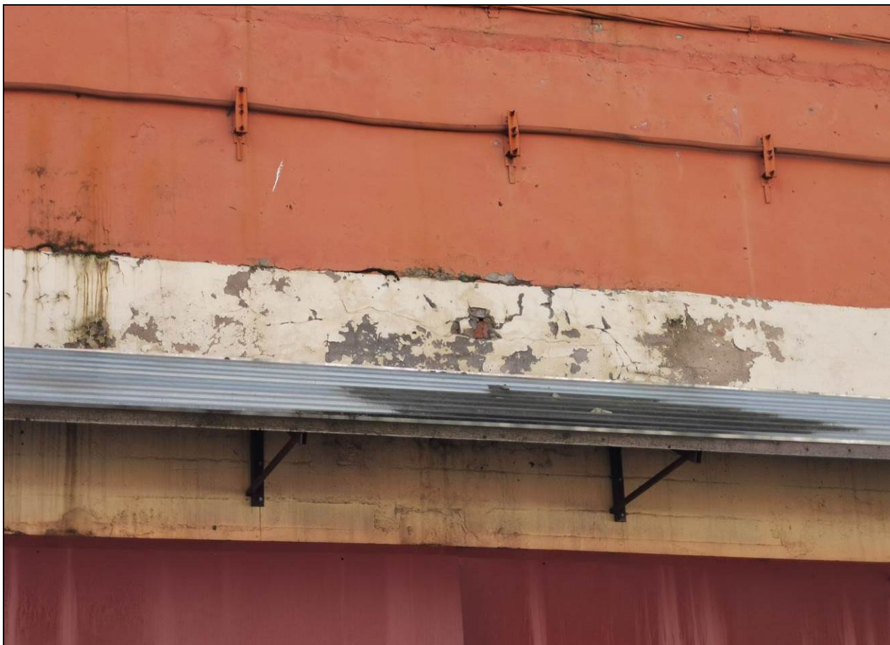
Фото 22. Локальные участки повреждения наружной отделки
