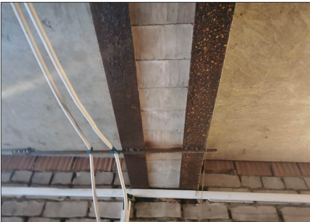
Фото 4. Поверхностная коррозия балок перекрытия в осях (2/3-3)/(А-В)
