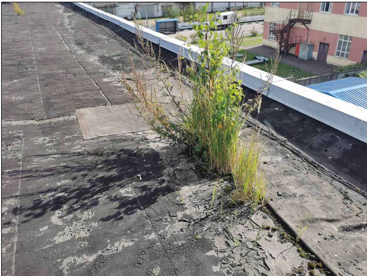
Фото 14. Характерные повреждения кровельного ковра
