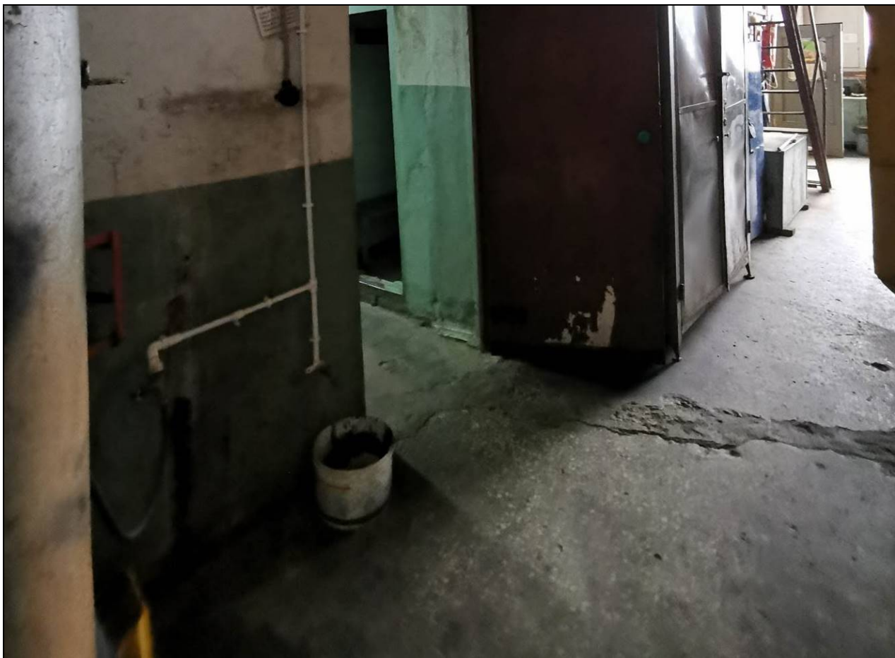
Фото 18. Повреждения покрытия полов
