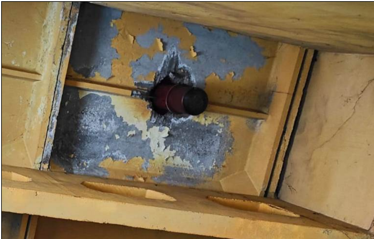
Фото 2. Плита покрытия в осях А-Б/2-3. Повреждение поперечного ребра при устройстве вентиляции
