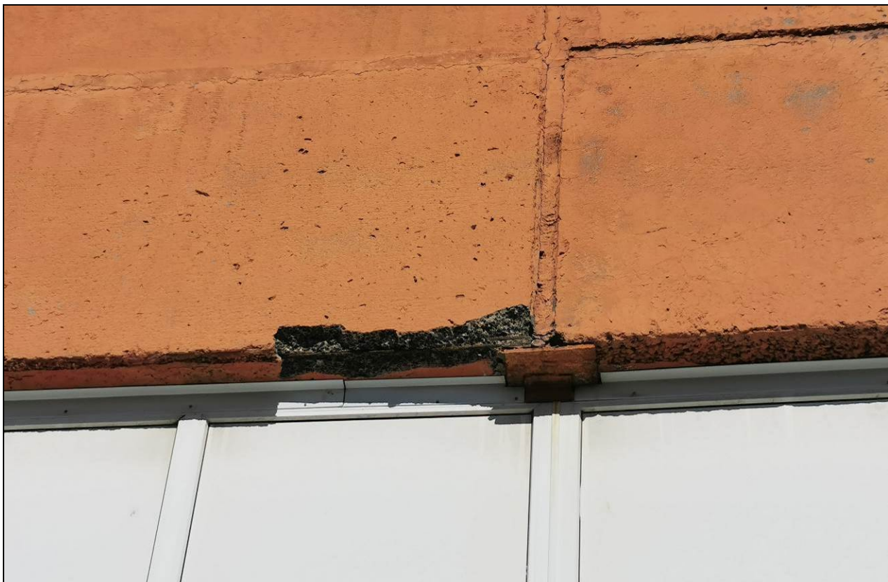
Фото 6. Повреждение защитного слоя бетона стеновой панели по оси В/3-2 (над оконным проемом)
