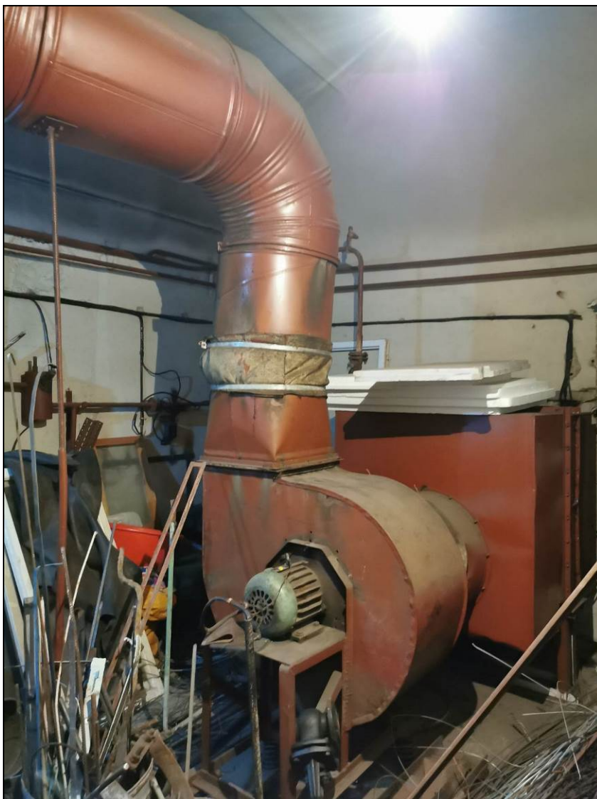
Фото 35. Вид вентиляционного оборудования венткамеры
