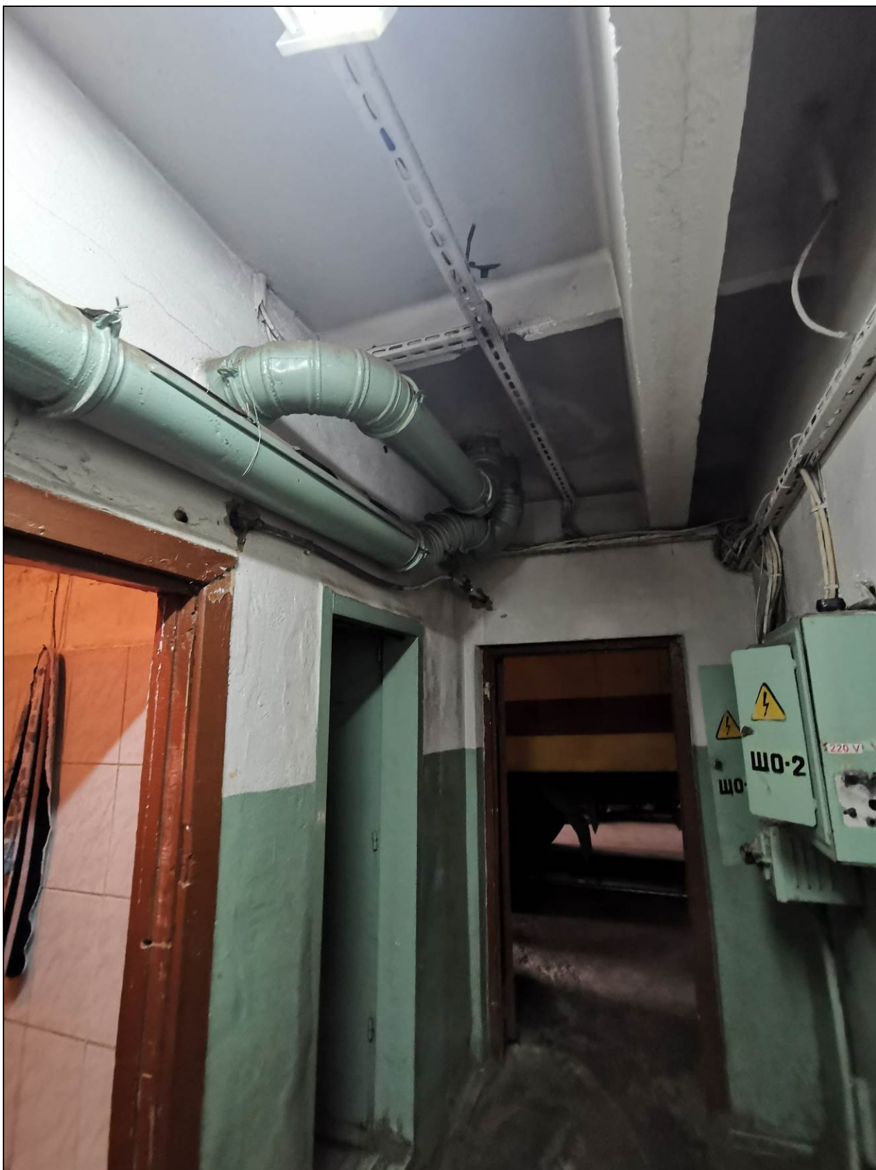
Фото 36. Вид воздуховодов системы вентиляции встроенных помещений
