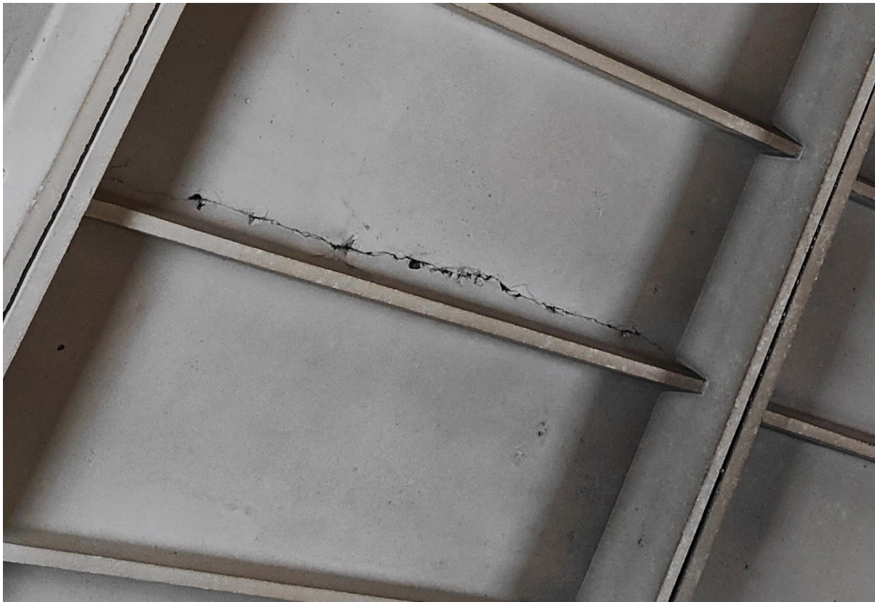
Фото 3. Плита покрытия в осях Б-В/8-9. Трещина по полке шириной раскрытия 5-10мм
