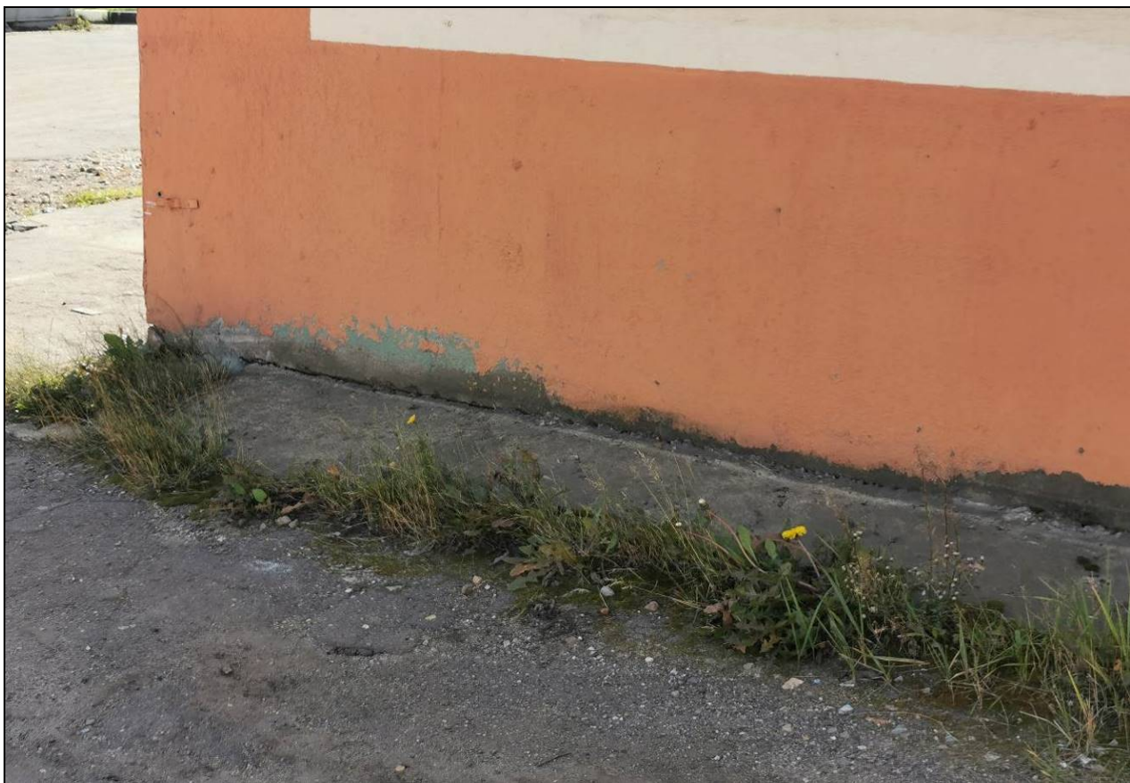
Фото 17. Характерные повреждения отмостки
