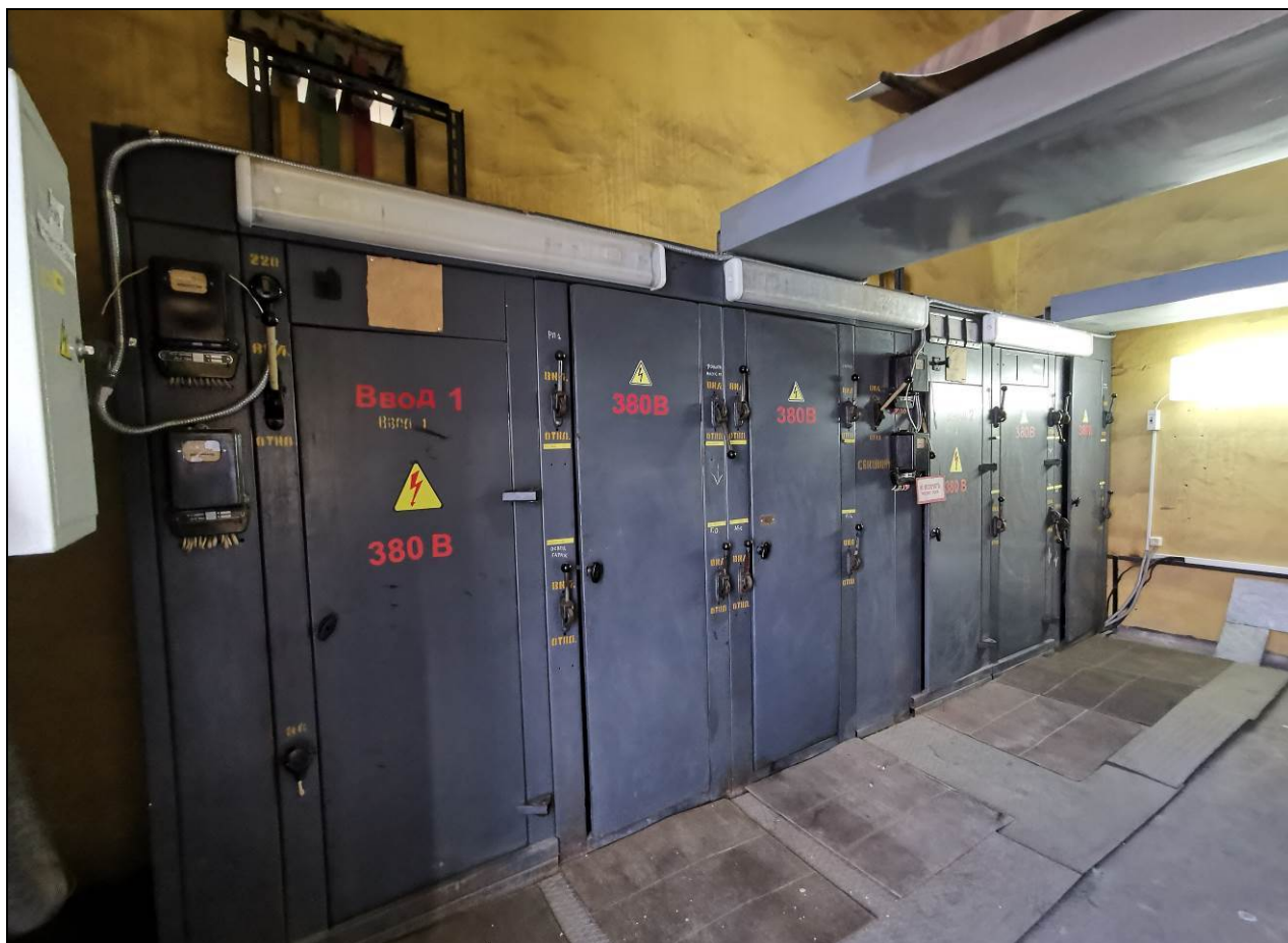
Фото 30. Вид оборудования Ру-0,4кВ
