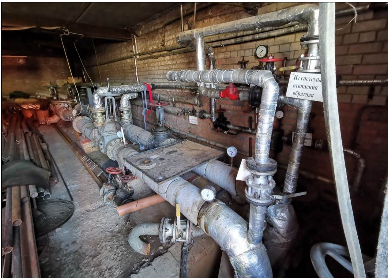
Фото 32. Вид оборудования теплового пункта
