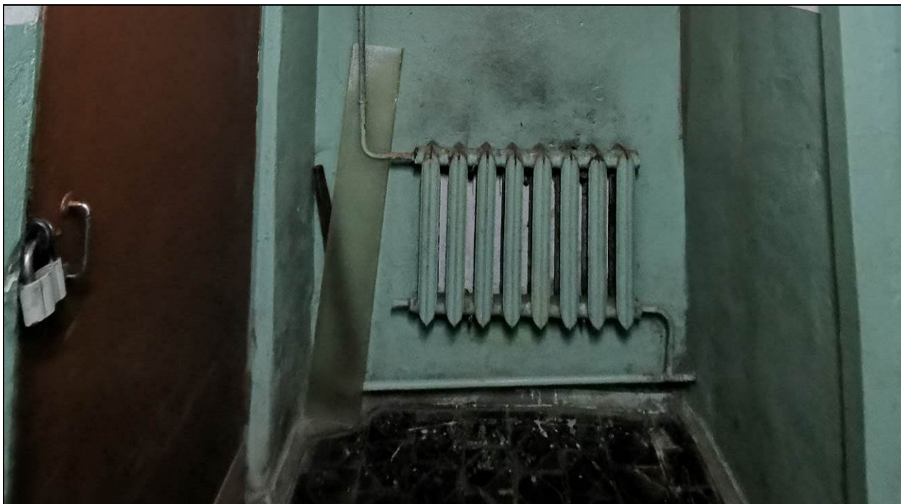
Фото 34. Вид радиаторов системы отопления
