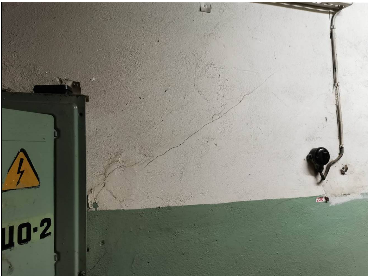
Фото 16. Трещина шириной раскрытия 1-2мм по перегородке в осях 3-4/А-Б, 1 этаж
