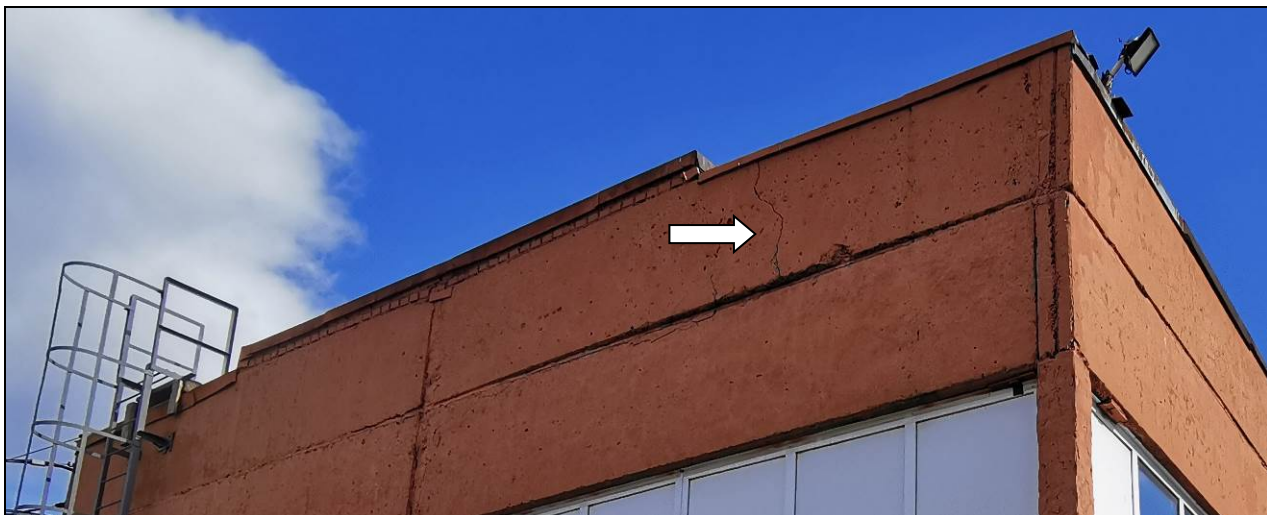
Фото 7. Трещина шириной раскрытия 2-4мм по стеновой панели по оси 9/Б-В
