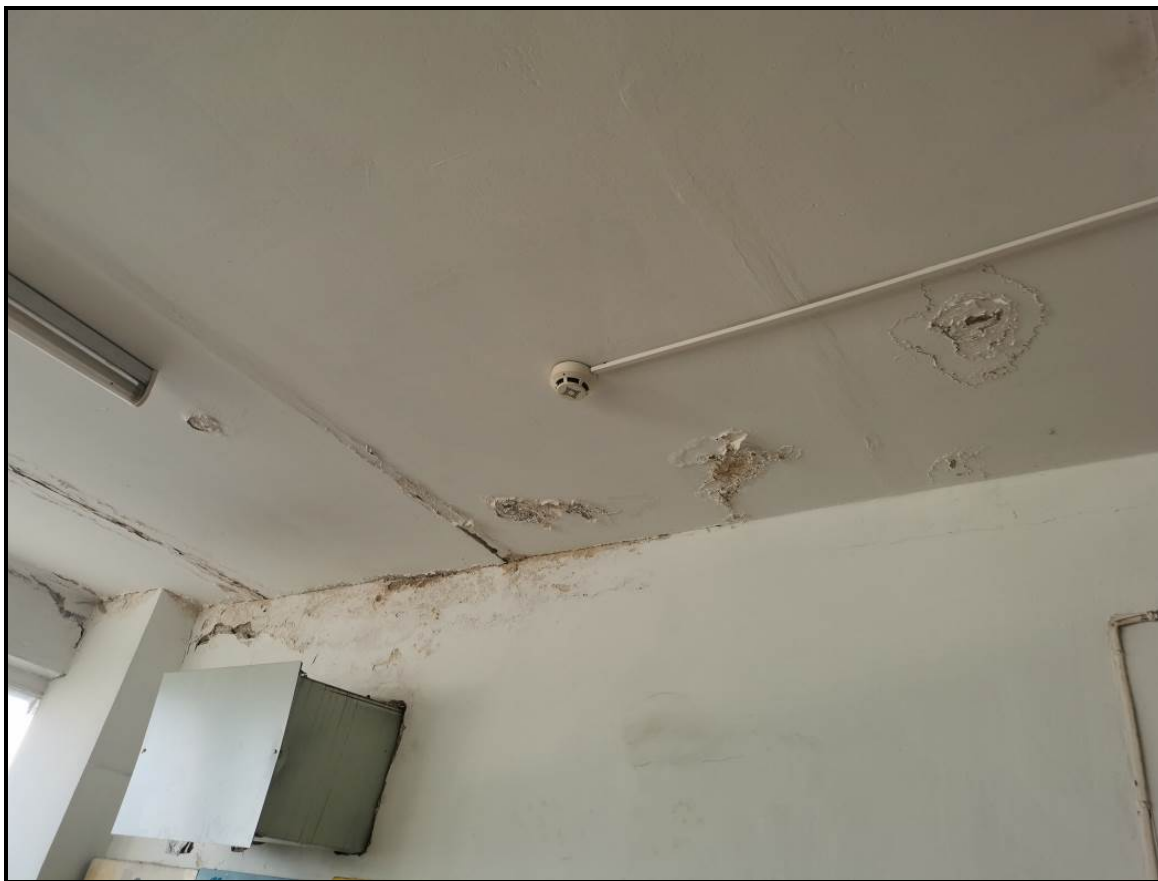
Фото 6.5.6. Увлажнение плит покрытия в результате течей кровли
