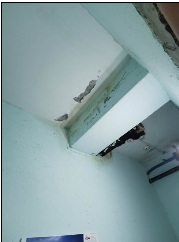
Фото 6.4.3. Увлажнение ригелей и плит перекрытий в результате течей кровли и коммуникаций
