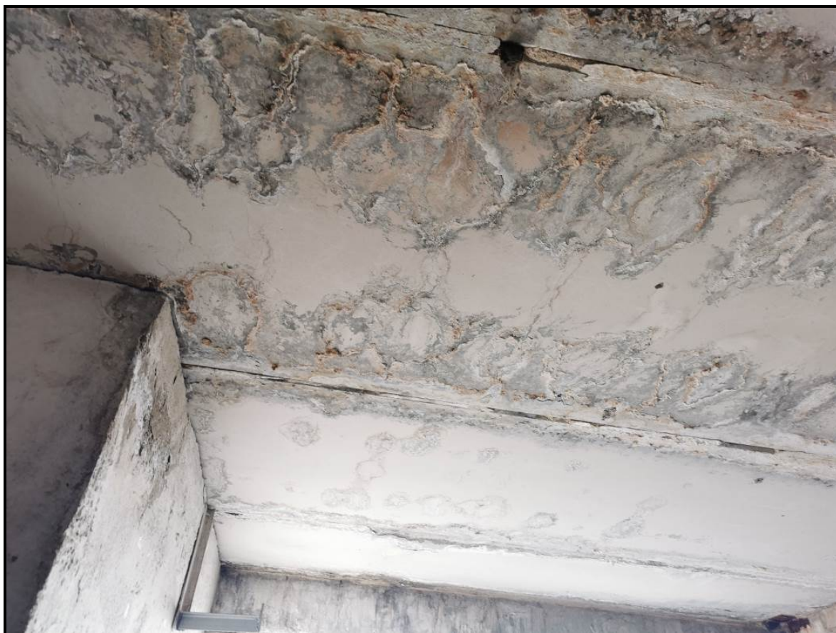
Фото 6.5.9. Увлажнение ригелей и плит покрытия в результате течей кровли
