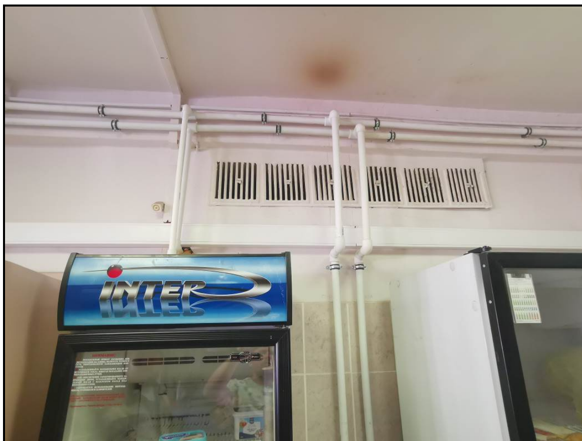
Фото 6.9.6. Общий вид вентиляции
