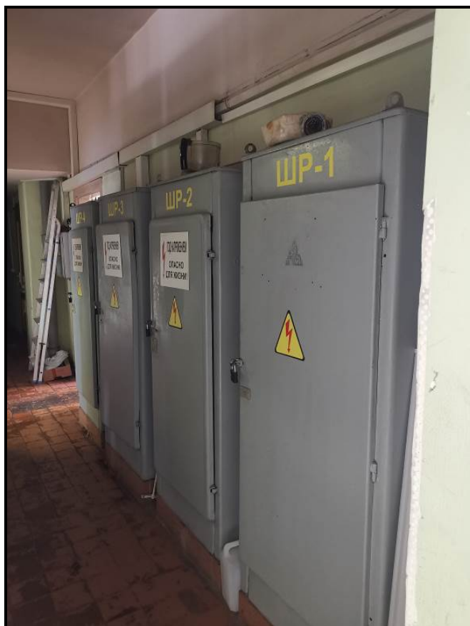
Фото 6.9.4. Общий вид распределительных шкафов
