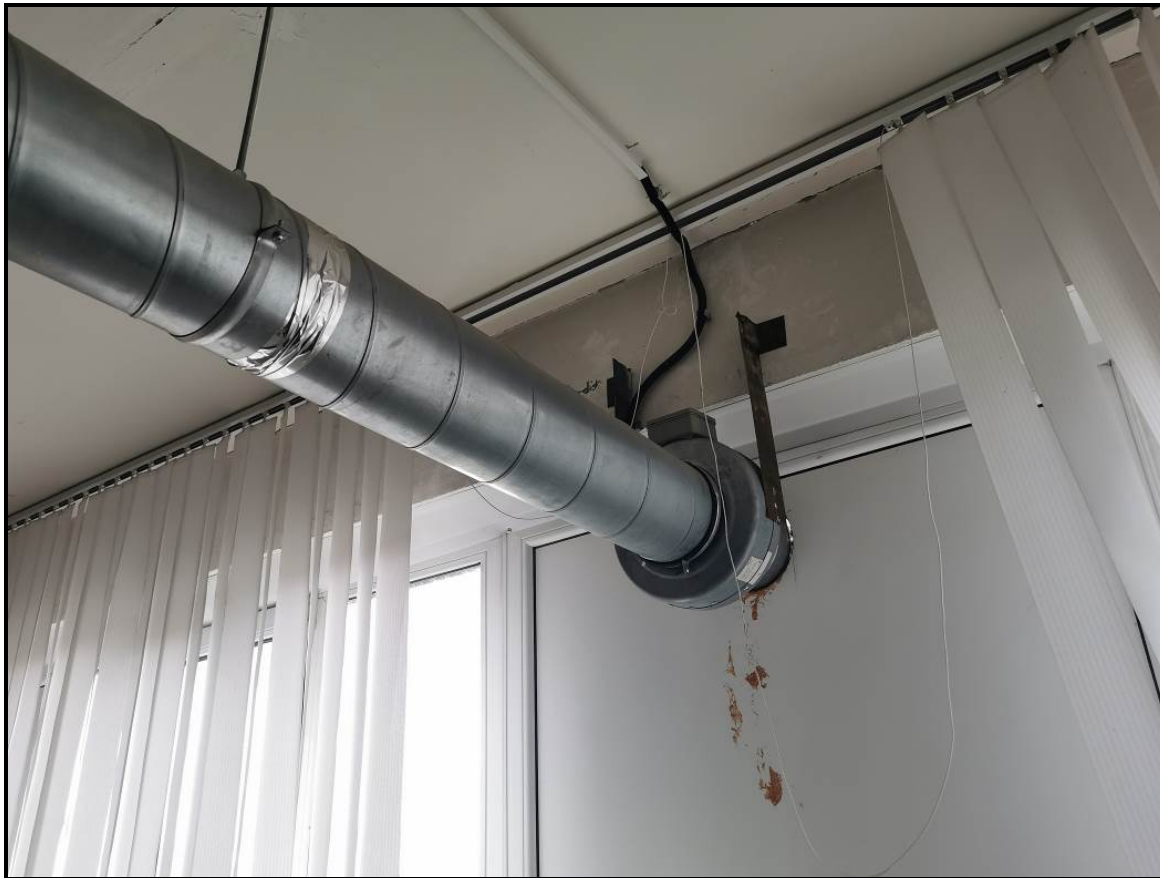
Фото 6.9.3. Общий вид труб вентиляции
