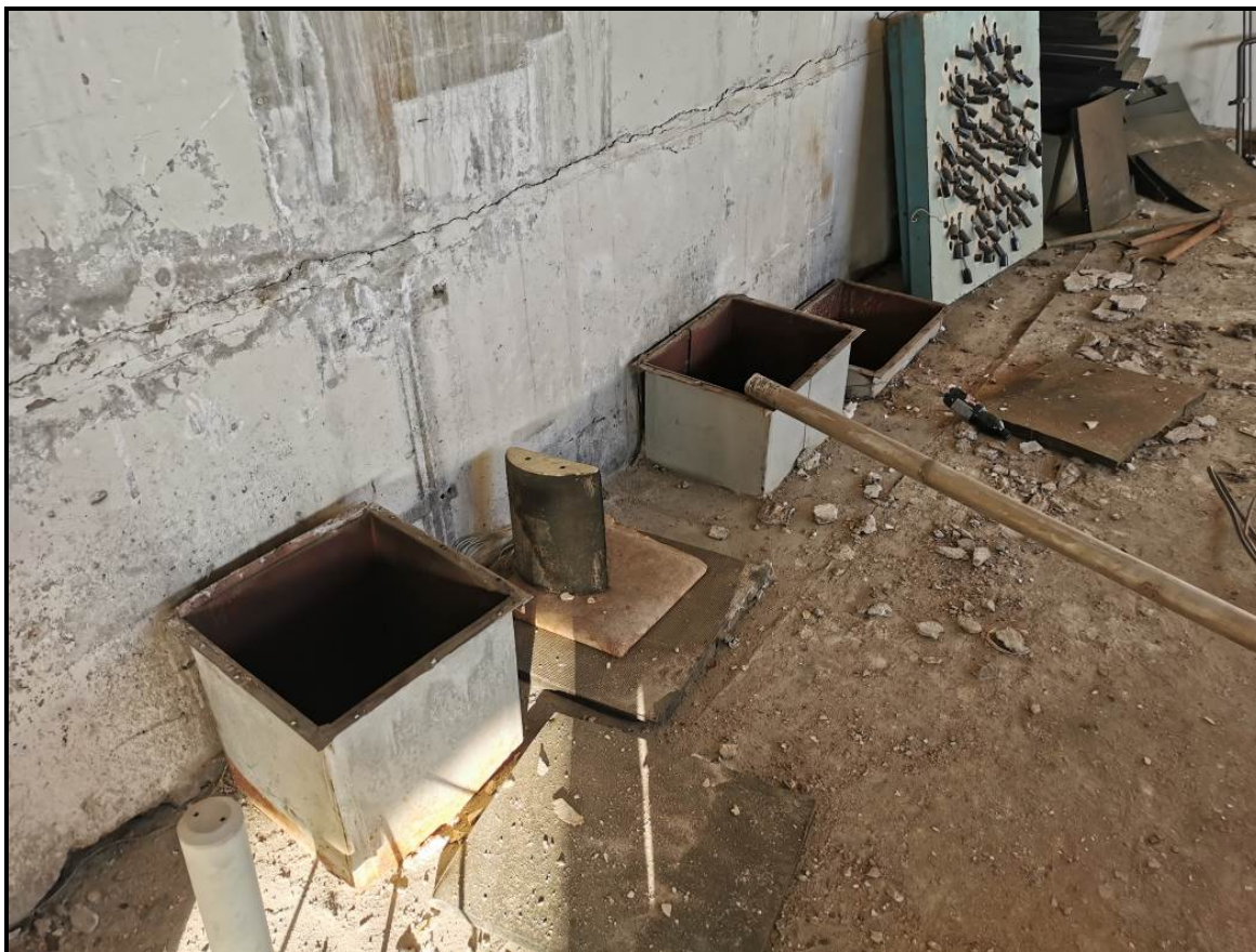
Фото 6.9.8. В уровне пятого этажа коробка вентиляции обрезаны
