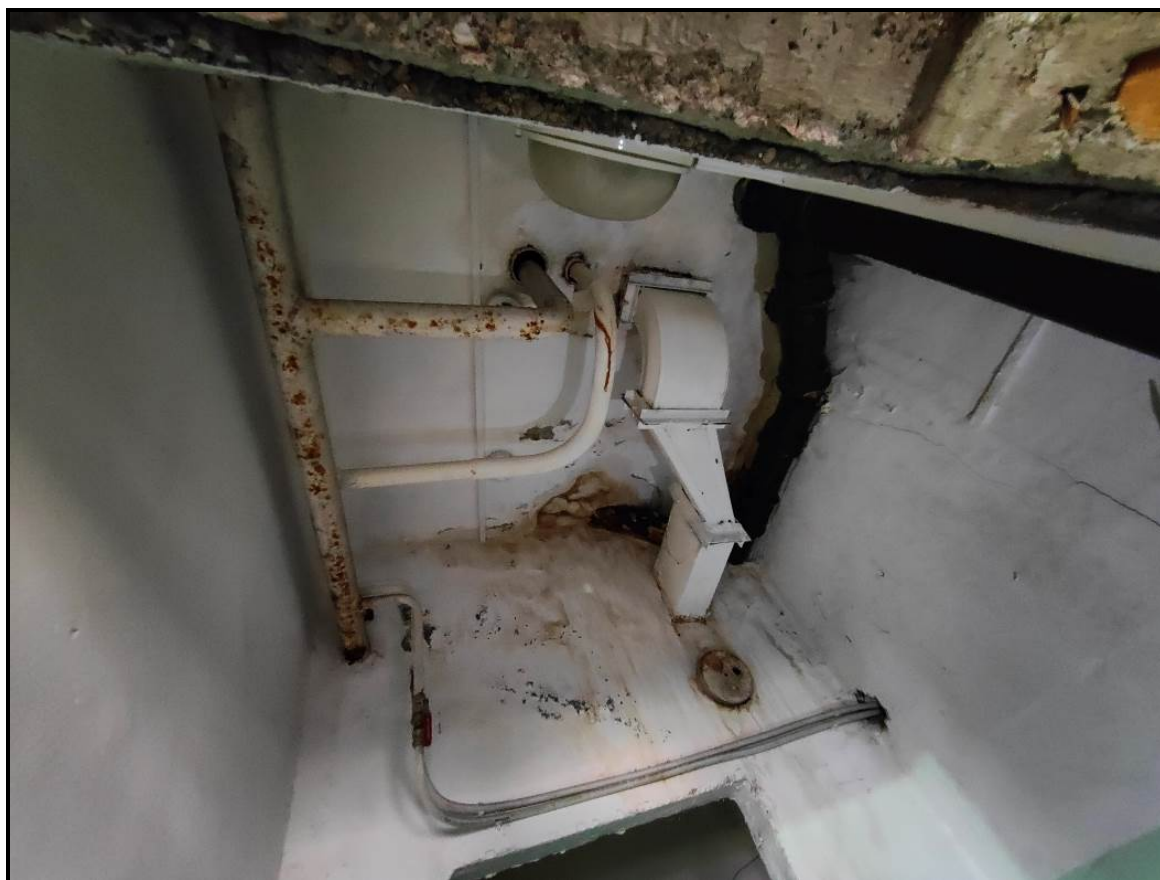
Фото 6.9.2. Общий вид труб водоотведения
