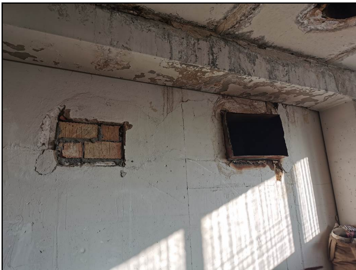
Фото 6.5.7. Увлажнение ригелей и плит покрытия в результате течей кровли
