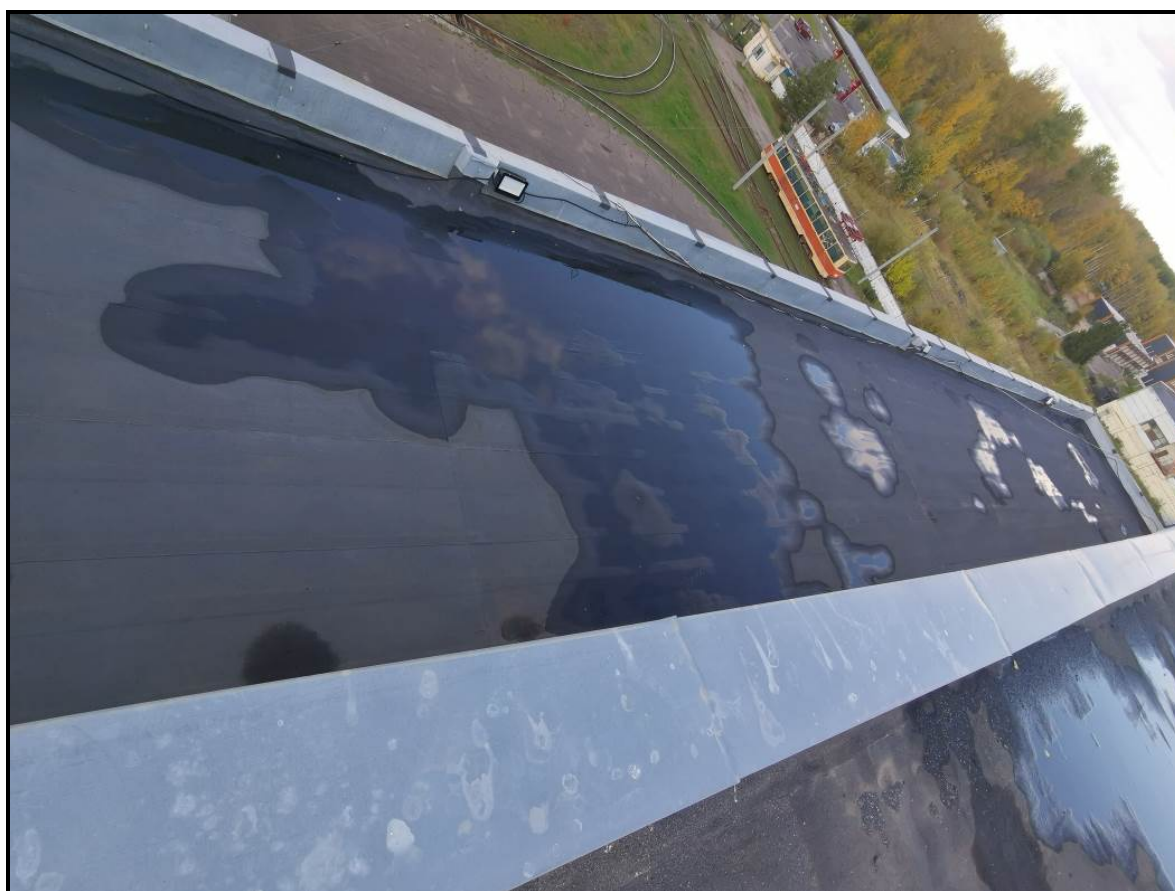
Фото 6.5.13. Скопление атмосферных осадков на конструкциях кровли
