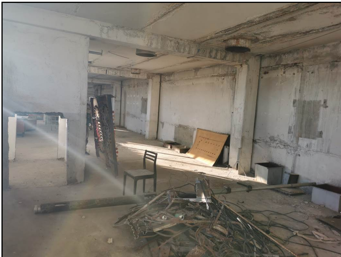
Фото 6.5.8. Увлажнение ригелей и плит покрытия в результате течей кровли
