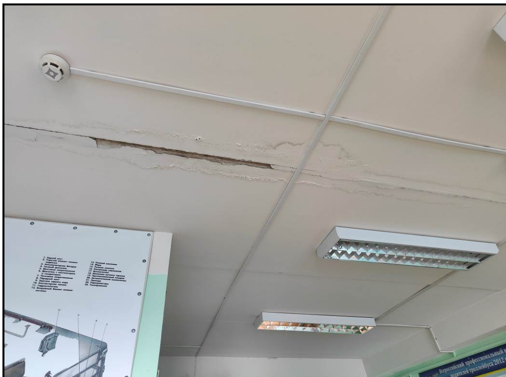
Фото 6.5.5. Увлажнение плит покрытия в результате течей кровли
