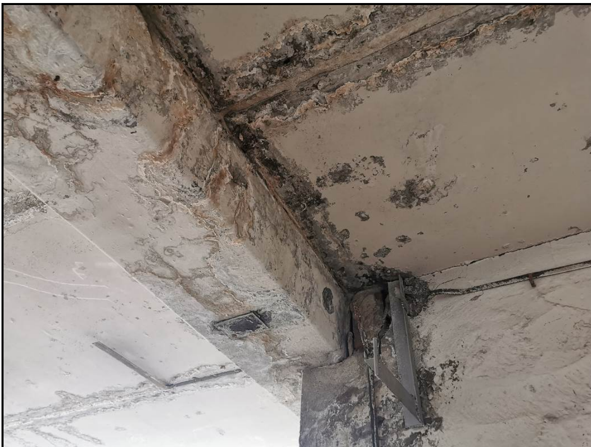
Фото 6.5.10. Увлажнение ригелей и плит покрытия в результате течей кровли
