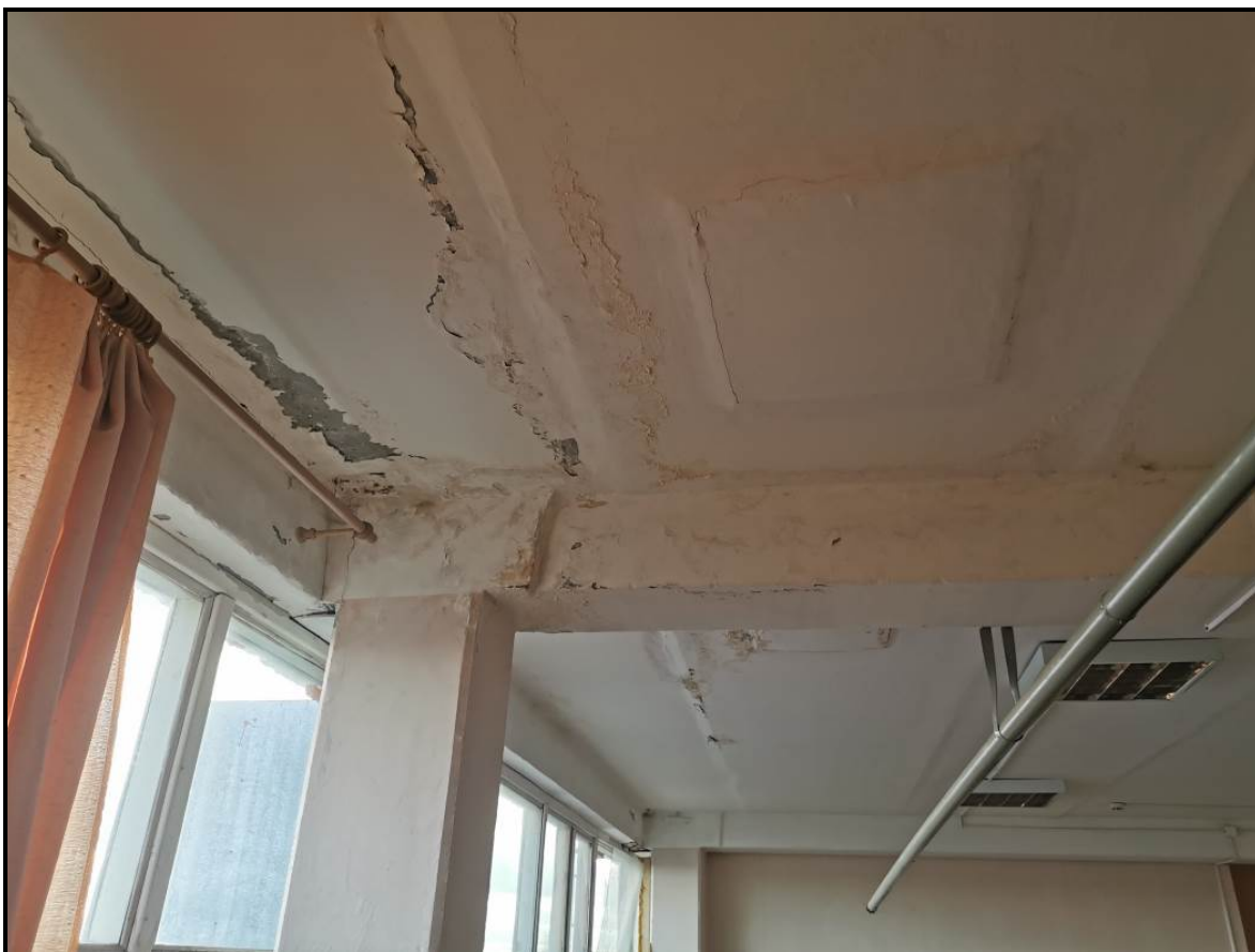
Фото 6.5.11. Увлажнение ригелей и плит покрытия в результате течей кровли
