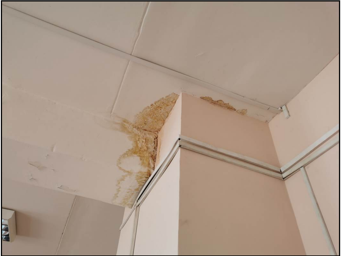
Фото 6.4.5. Увлажнение ригелей и плит перекрытий в результате течей кровли и коммуникаций
