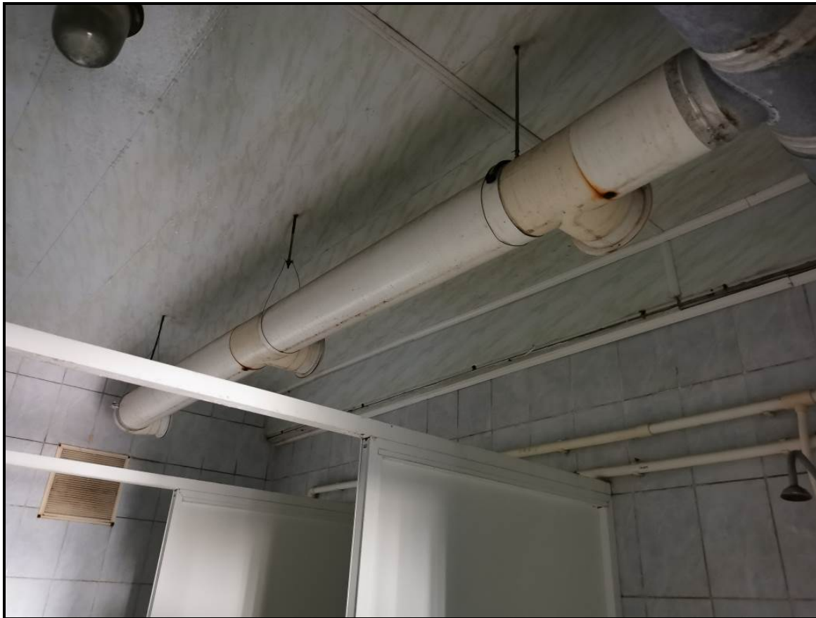
Фото 6.9.7. Общий вид вентиляции
