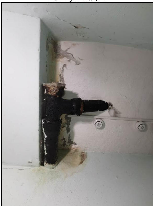
Фото 6.4.4. Увлажнение ригелей и плит перекрытий в результате течей кровли и коммуникаций
