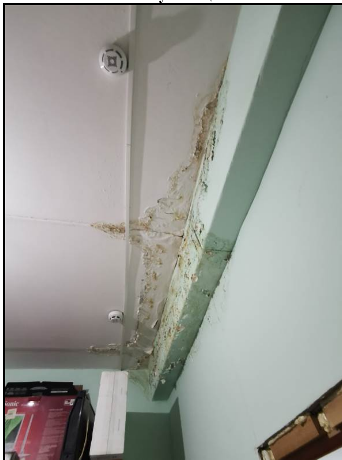
Фото 6.4.6. Увлажнение ригелей и плит перекрытий в результате течей кровли и коммуникаций
