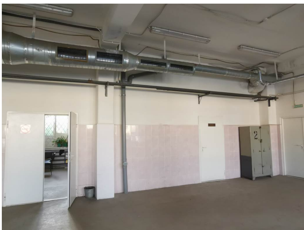
Фото 14. Общий вид системы вентиляции
