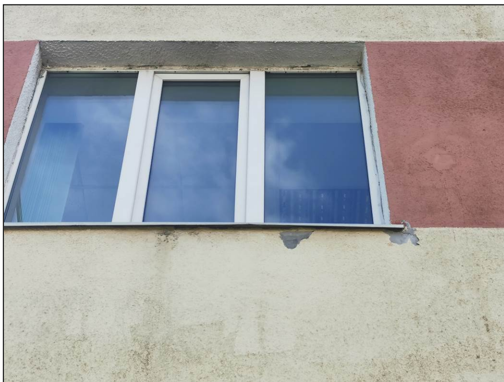
Фото 1. Участки отслаивания окрасочного слоя фасада здания
