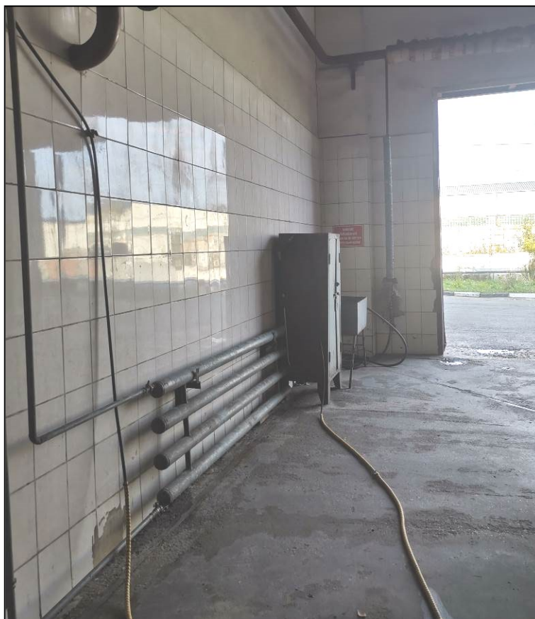
Фото 13. Общий вид регистров системы отопления, выявлены локальные разрушения антикоррозийного покрытия и поверхностная коррозия металла
