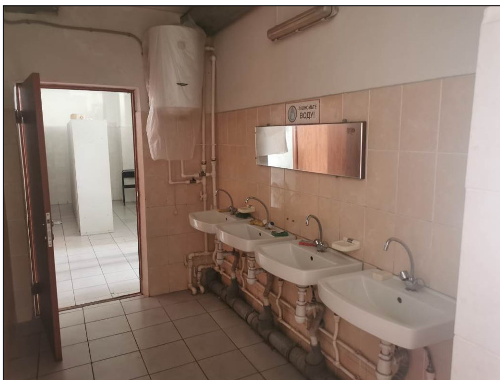
Фото 12. Общий вид сантехнических устройств, разводящих сетей водоснабжения и водоотведения. Водонагреватель находится в нерабочем состоянии
