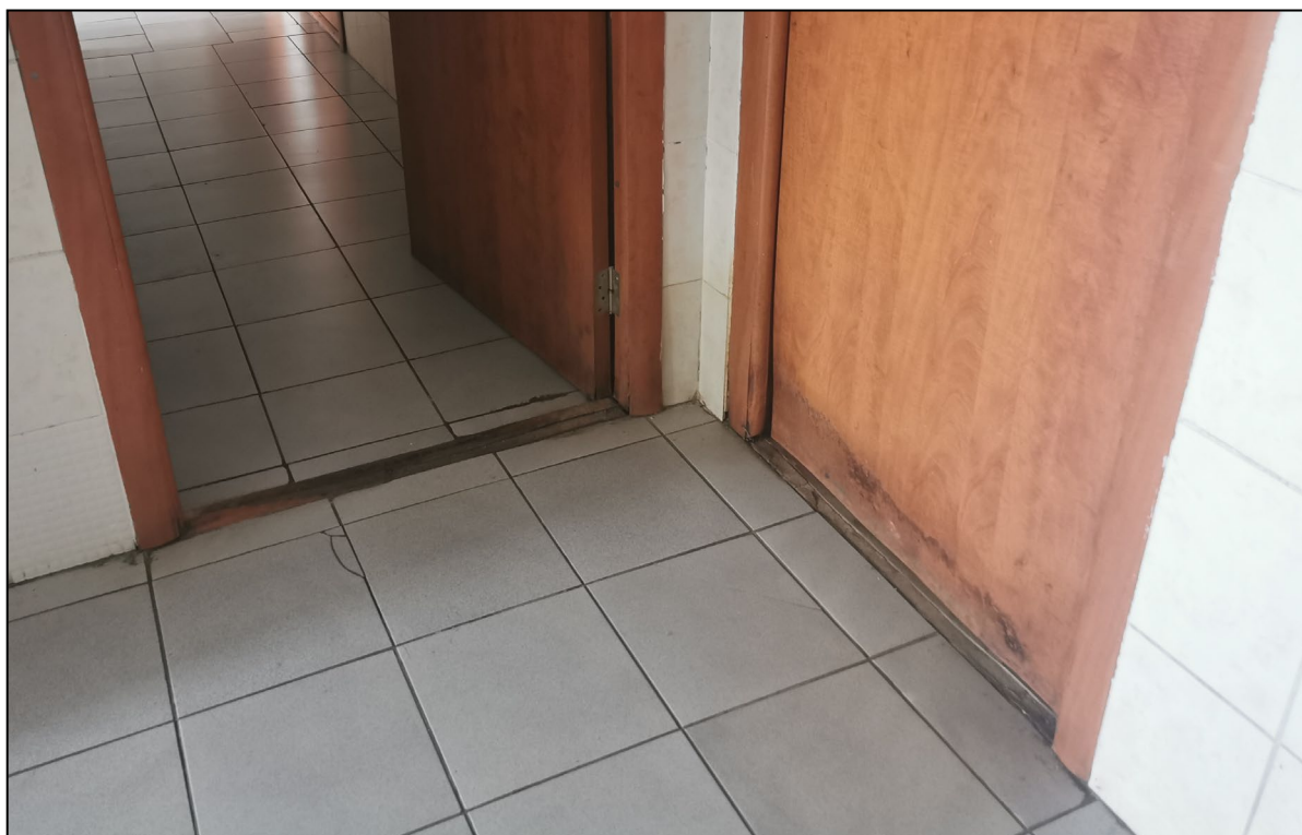
Фото 10. Увлажнение и растрескивание нижней поверхности деревянной двери
