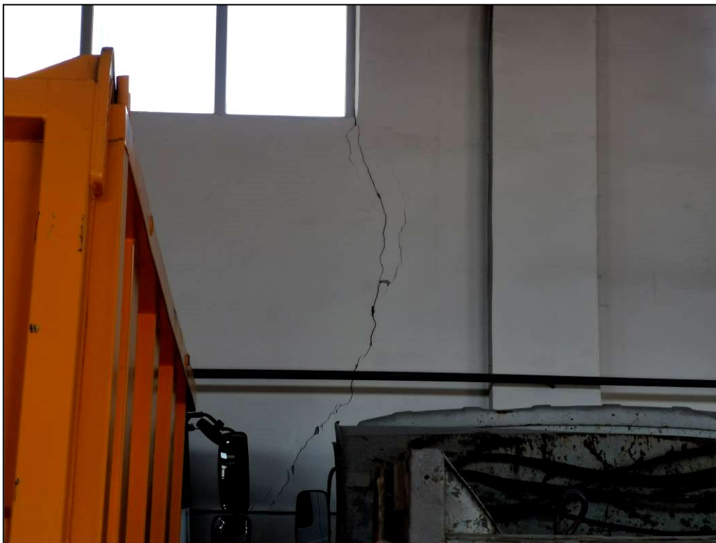
Фото 3. Вертикальная трещина шириной раскрытия 5 мм в стене по оси А
