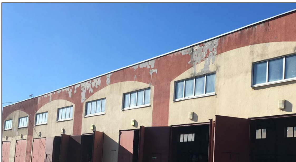
Фото 2. Участки отслаивания окрасочного слоя фасада здания
