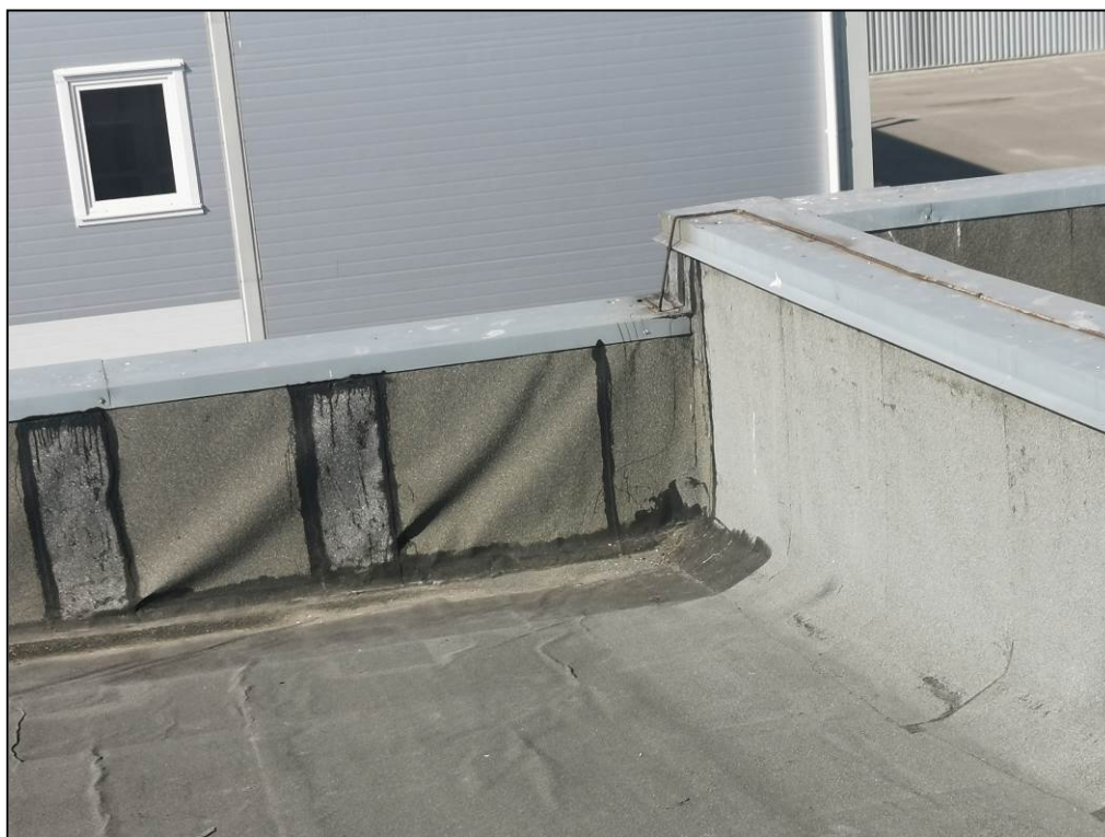
Фото 8. Отслаивание гидроизоляционного ковра от парапета
