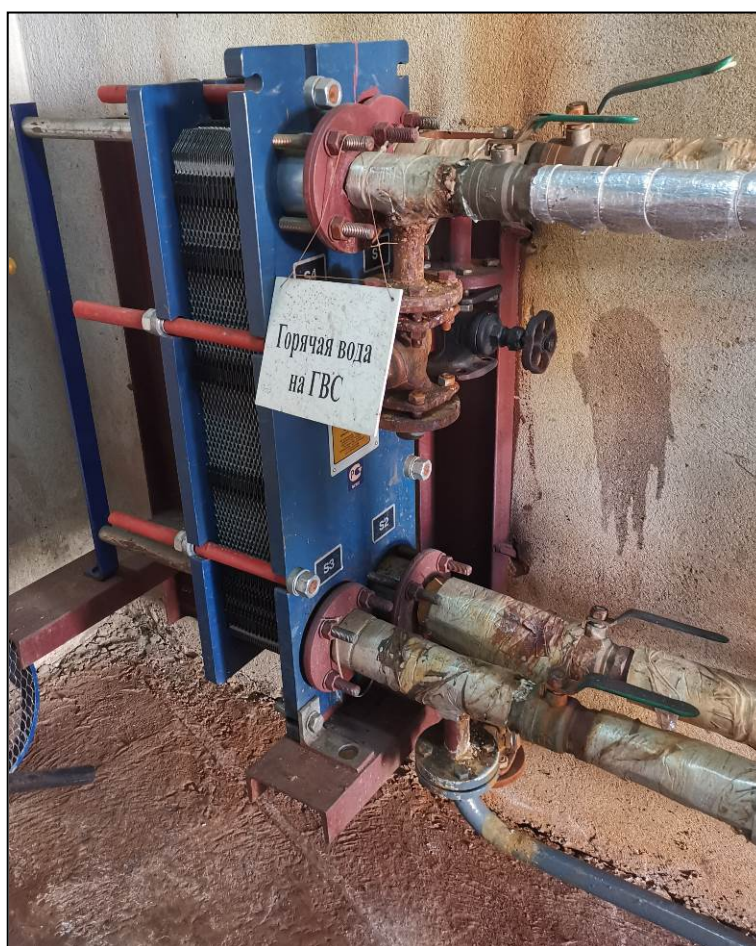
Фото 16. Течи и коррозия запорной арматуры и фланцев трубопроводов в тепловом пункте
