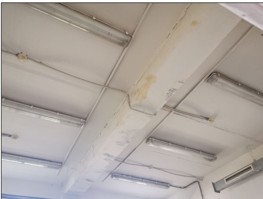
Фото 6. Участок увлажнения ригеля покрытия
