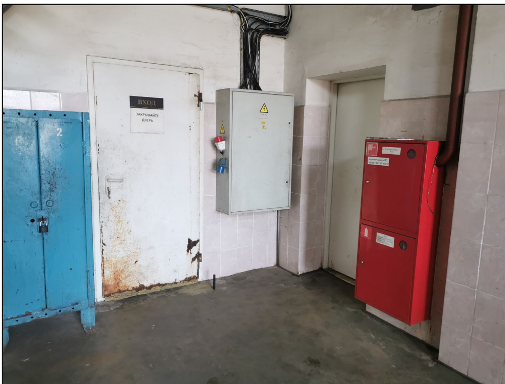
Фото 9. Разрушение защитного антикоррозийного покрытия металлической двери
