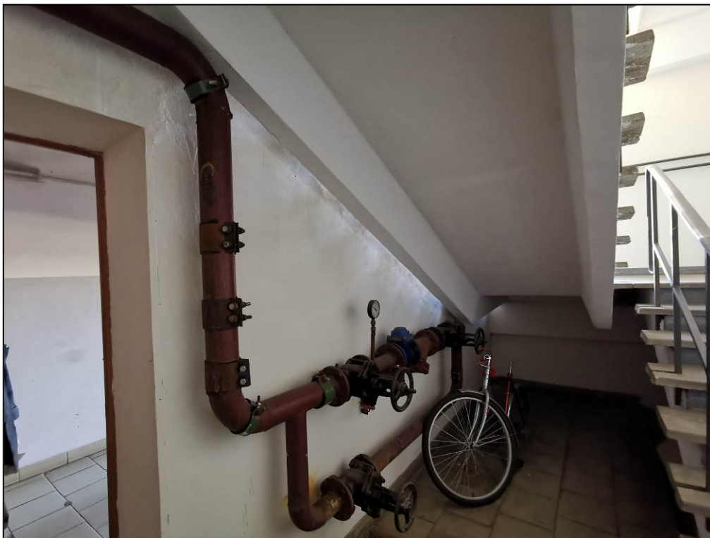
Фото 17. Узел ввода холодного водоснабжения, многочисленные ремонтные хомуты на трубопроводе
