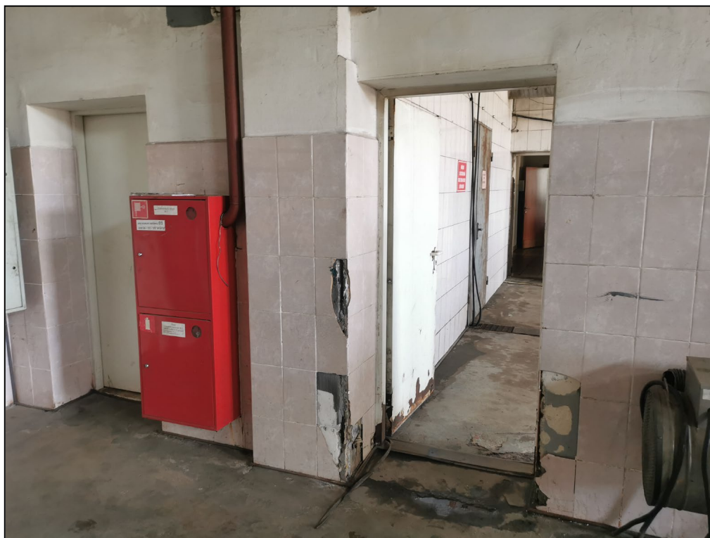
Фото 11. Механическое разрушение облицовочного слоя внутренней отделки стен здания
