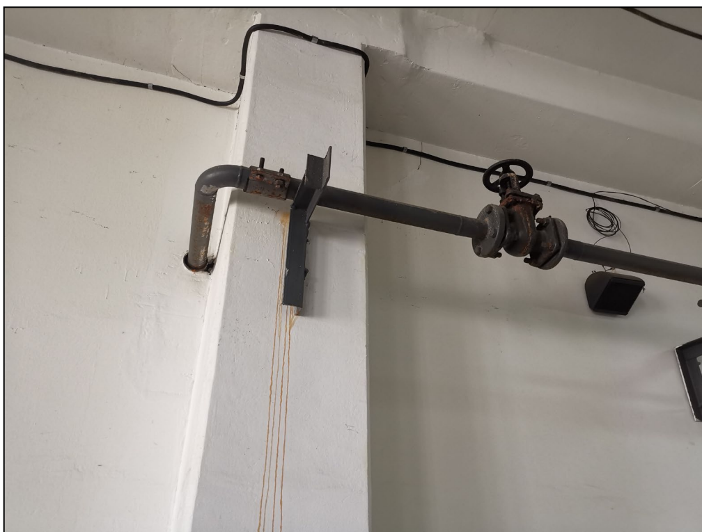
Фото 18. Установлен ремонтный хомут на трубопроводе холодного водоснабжения, поверхностная коррозия трубопровода и запорной арматуры
