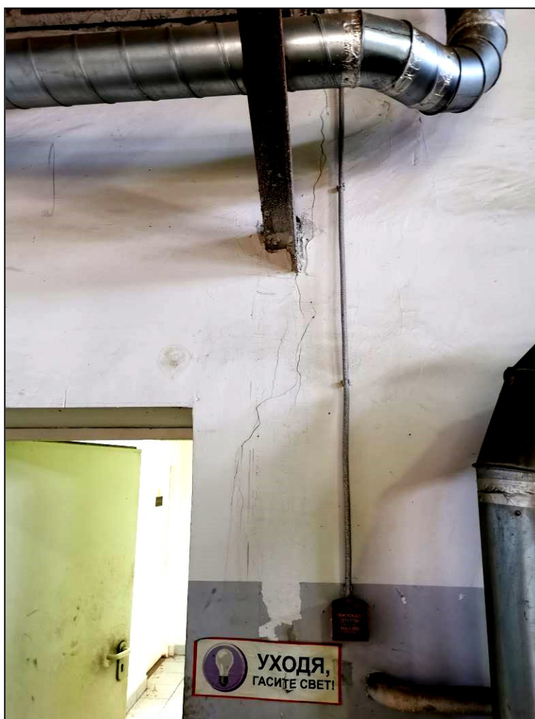
Фото 4. Наклонная трещина шириной раскрытия 1 мм в стене по оси 5
