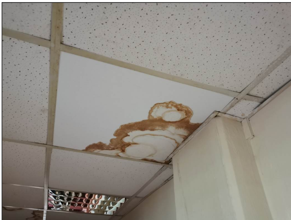
Фото 7. Увлажнение панели подвесного потолка
