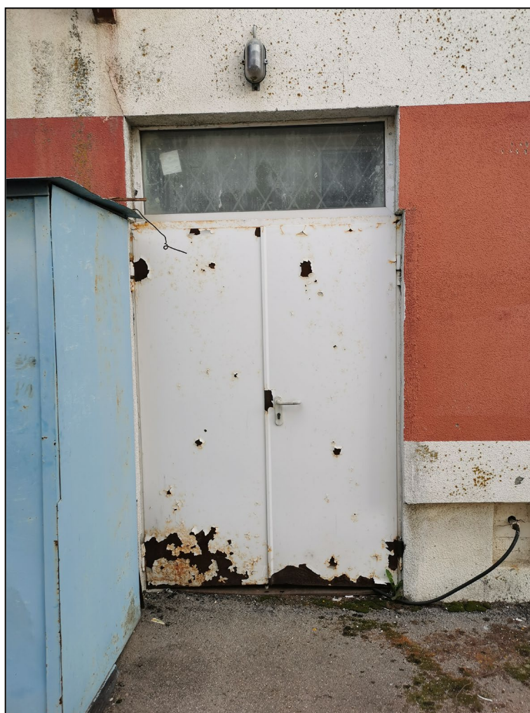
Фото 6. Поверхностная коррозия металлической двери, разрушение окрасочного слоя дверного полотна
