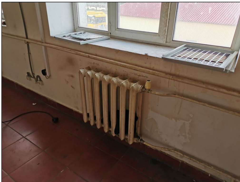
Фото 9. Общий вид радиатора отопления. Отмечены участки поверхностной коррозии металла трубопроводов по месту нарушенного окрасочного слоя
