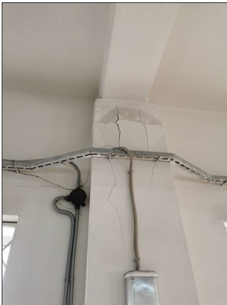
Фото 5. Вертикальные трещины и вспучивание штукатурного слоя пилястры в осях Гх8 в уровне первого этажа, вблизи опорной зоны ригеля
