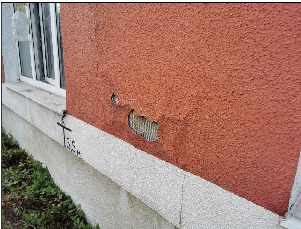
Фото 3. Отслаивание штукатурного слоя фасада
