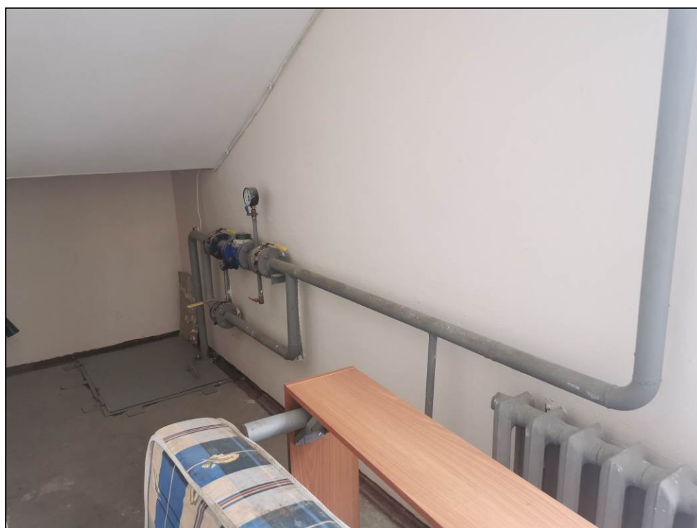
Фото 10. Общий вид узла ввода холодного водоснабжения
