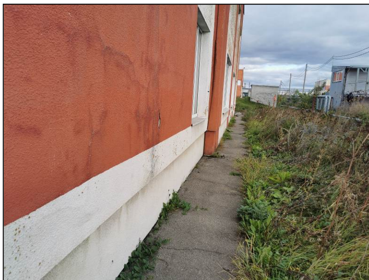
Фото 13. Общий вид отмостки и фрагмент фасада. Трещины в асфальтобетонном покрытии, биологическое поражение отмостки (растительность). По фасаду отмечены хаотичные трещины и вздутие (отслаивание) штукатурного слоя
