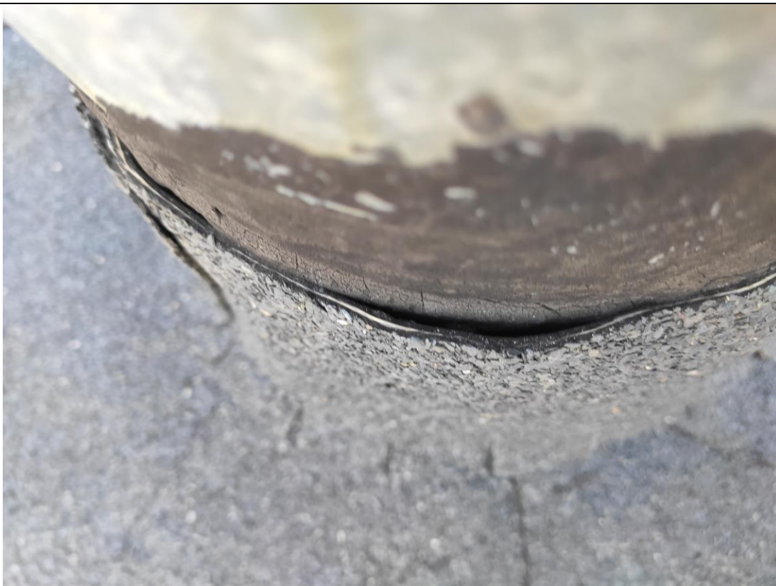
Фото 46. Негерметичное примыкание гидроизоляционного ковра к вентиляционной трубе в осях А/23-24.
