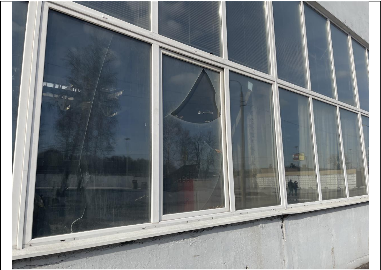
Фото 49. Нарушение целостности остекления оконного блока.
