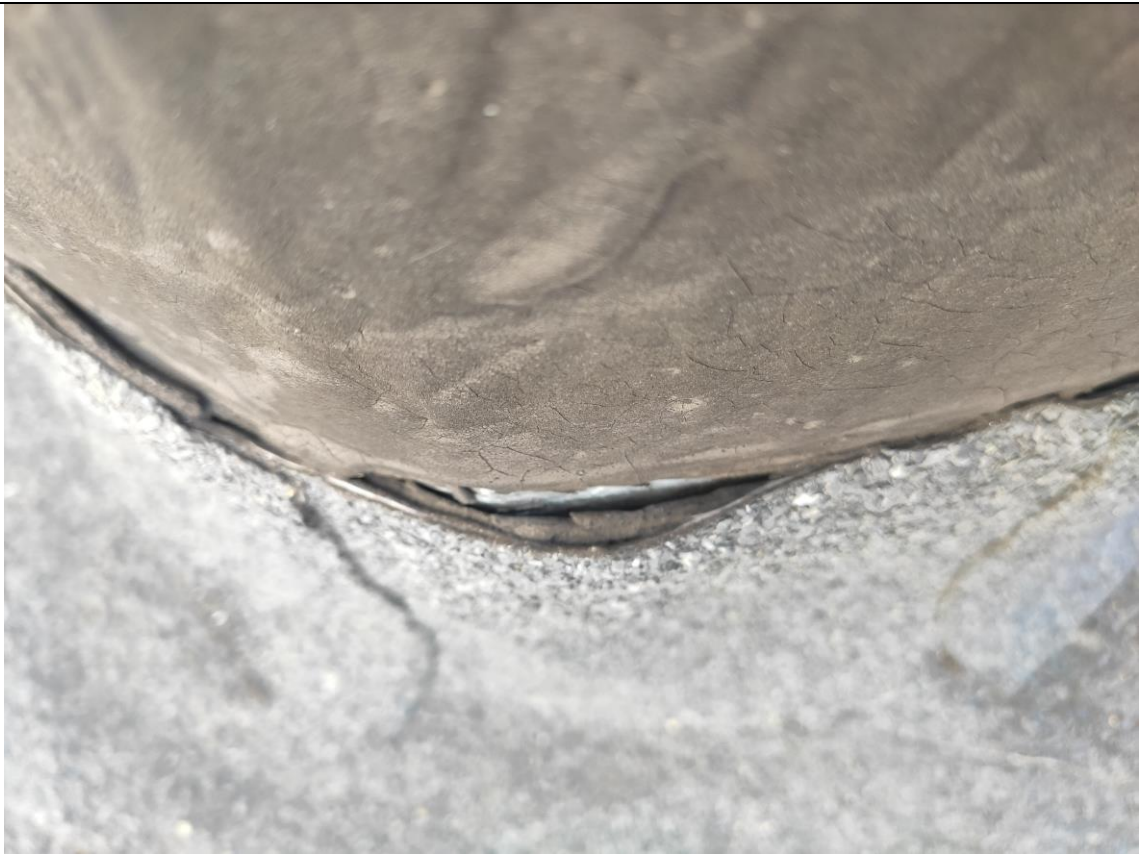
Фото 42. Негерметичное примыкание гидроизоляционного ковра к вентиляционной трубе в осях В/16-17.
