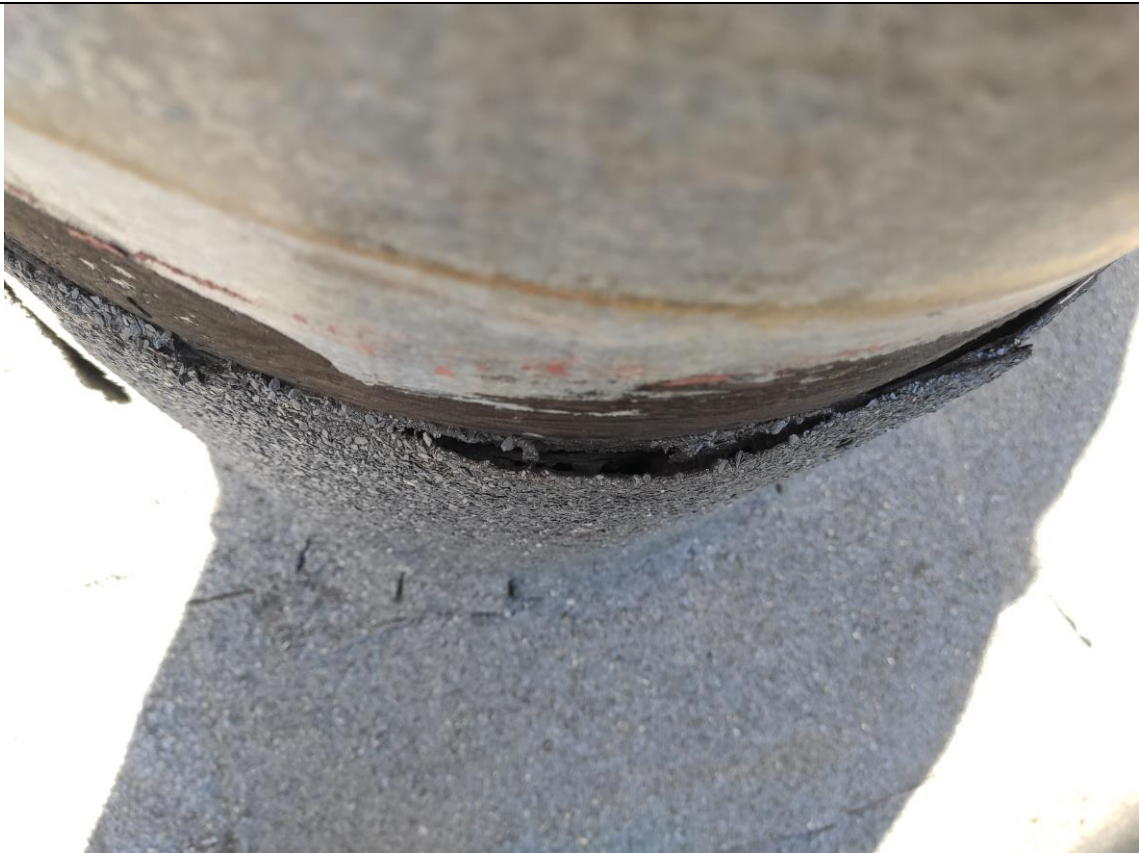
Фото 44. Негерметичное примыкание гидроизоляционного ковра к вентиляционной трубе в осях В/26-27.
