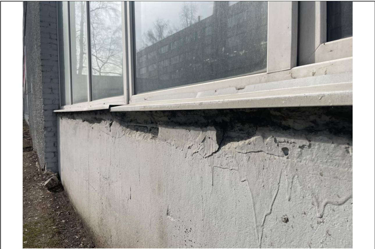
Фото 34. Разрушение защитного слоя бетона стеновых панелей
