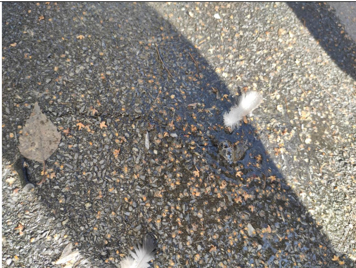
Фото 48. Нарушение целостности гидроизоляционного ковра в осях В/28-29.
