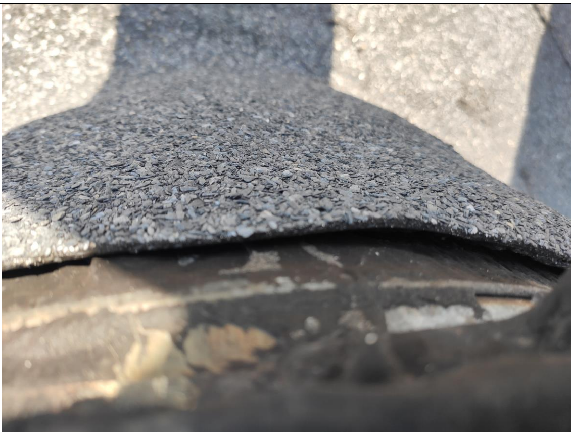
Фото 45. Негерметичное примыкание гидроизоляционного ковра к вентиляционной трубе в осях Б/29-30.
