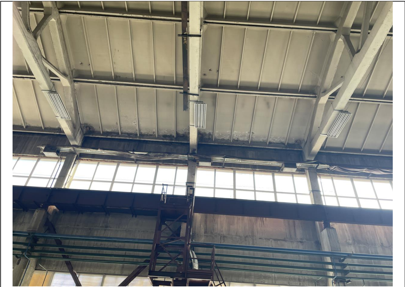
Фото 36. Следы замокания плит покрытия
