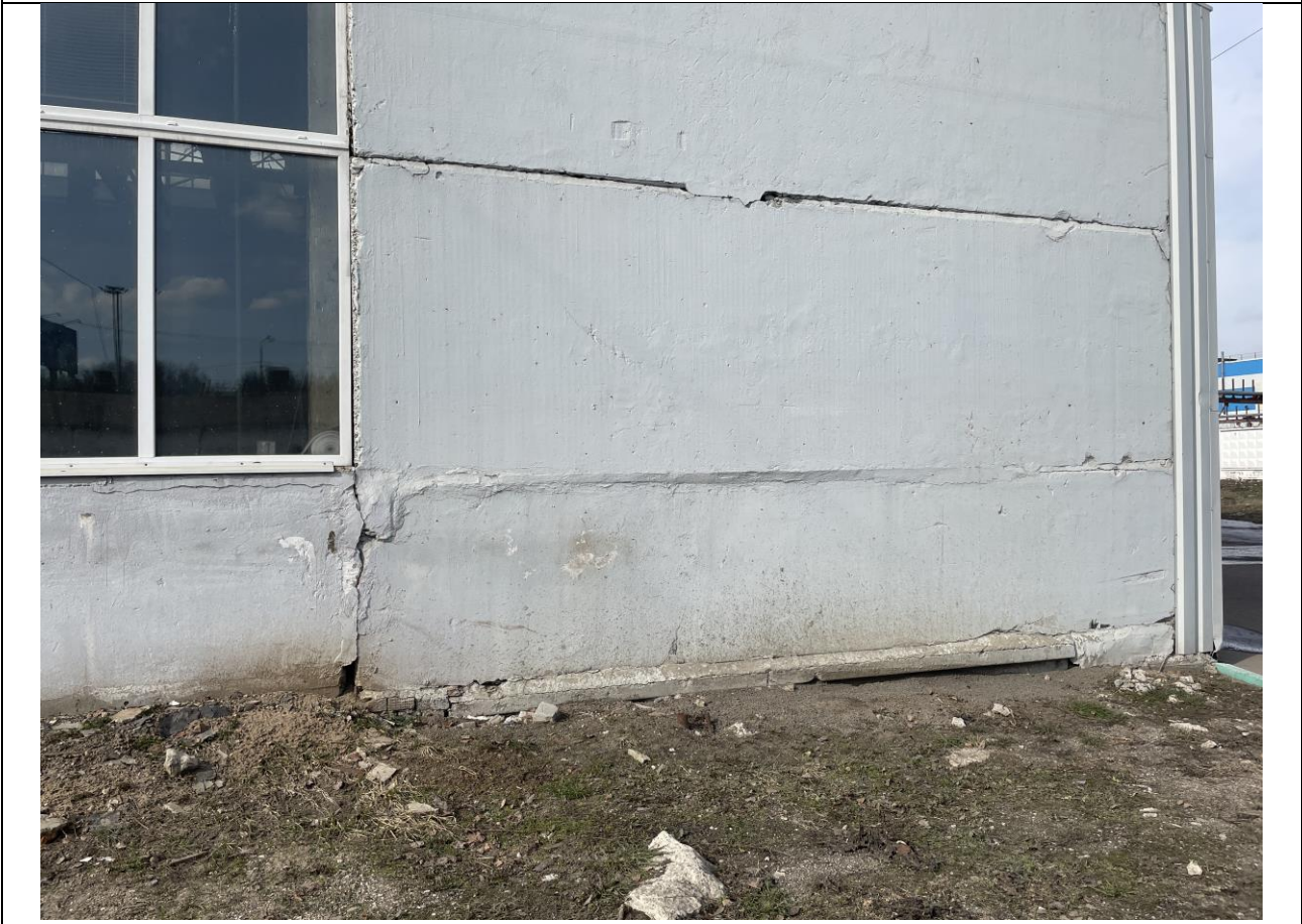
Фото 35. Разрушение заполнения межпанельных швов
