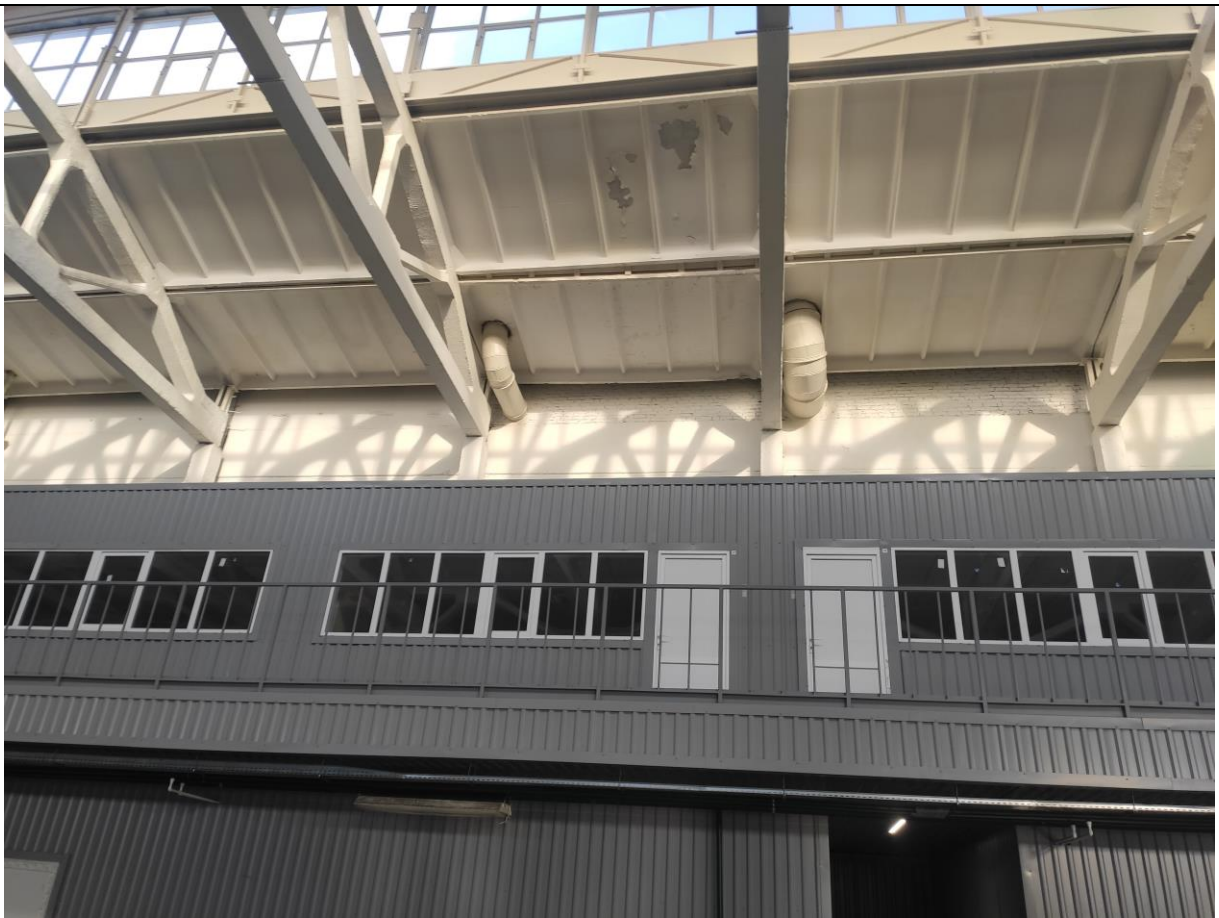
Фото 21. Воздуховоды системы вентиляции выходящие из венткамеры на кровлю.
