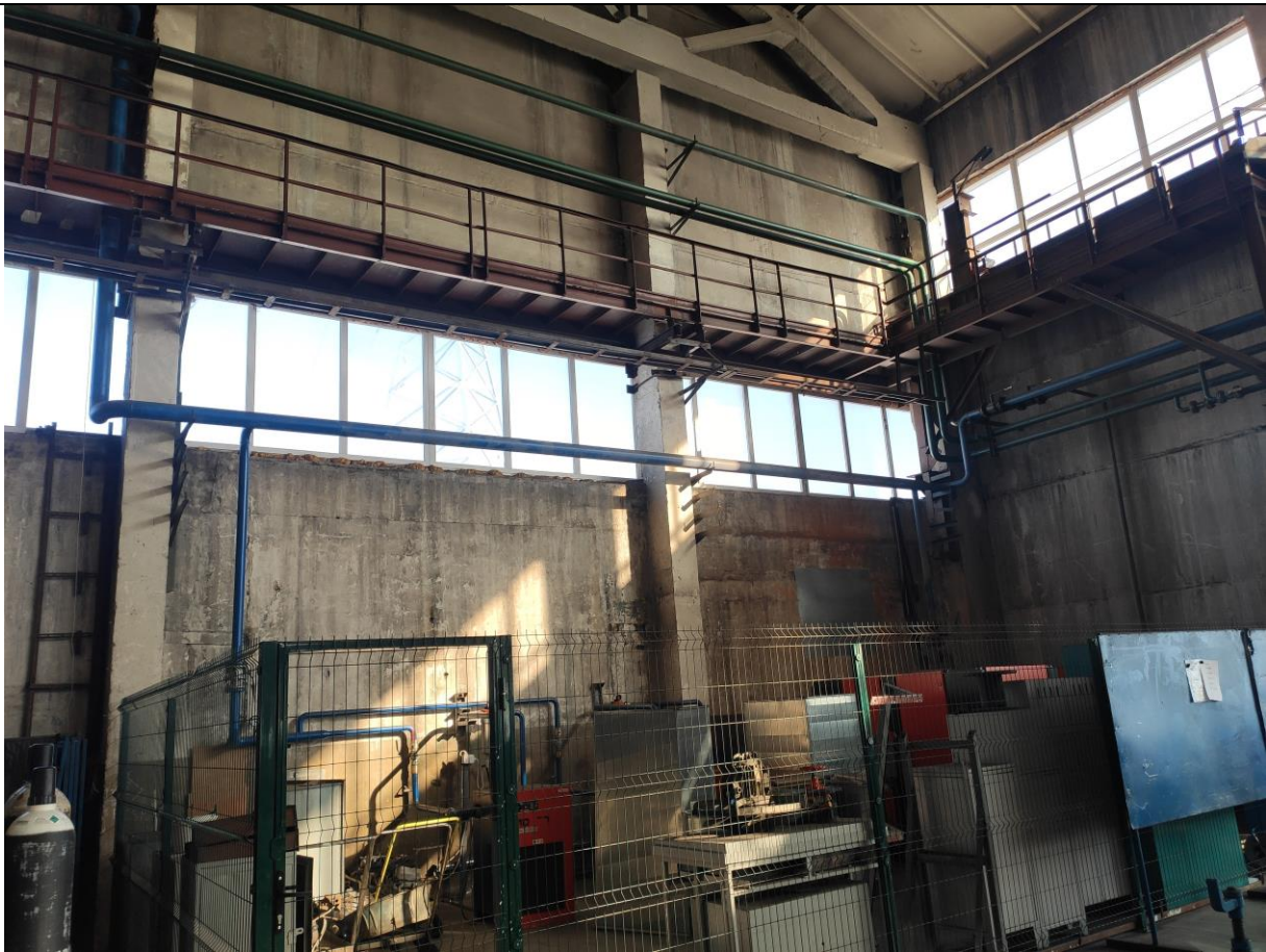
Фото 23. Трубопроводы сжатого воздуха в помещении компрессорной.
