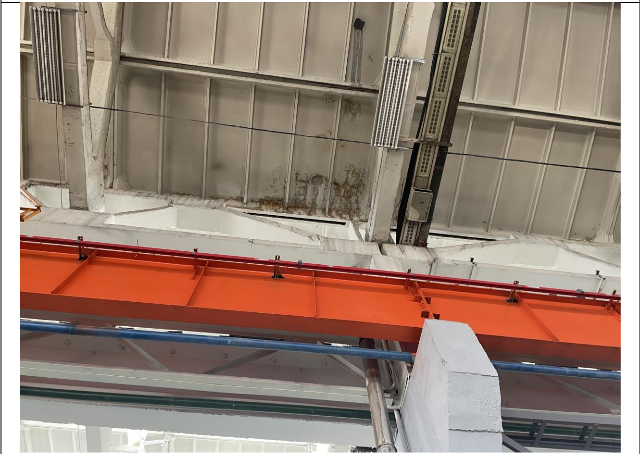
Фото 37. Следы замокания плит покрытия
