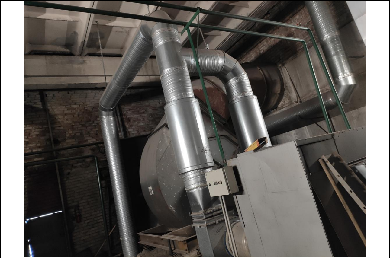
Фото 50. Вентиляционное оборудование установленное в венткамере примыкающей к цеху №8 по оси В.
