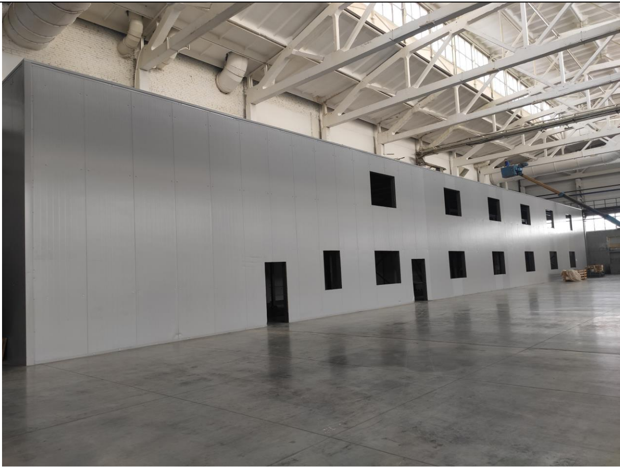
Фото 10. Общий вид недостроенной части АБК в осях Б-В/24-33.
