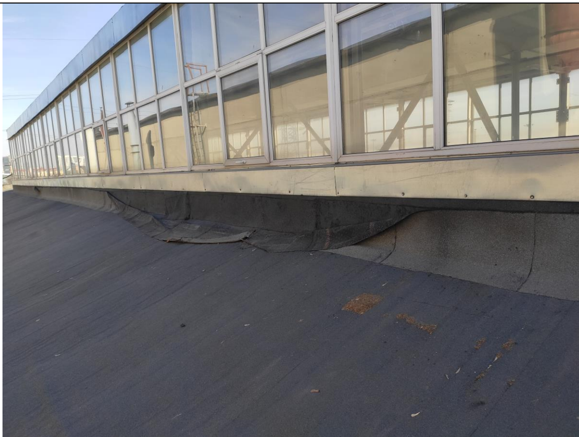
Фото 47. Негерметичное примыкание гидроизоляционного ковра к вертикальным поверхностям светоаэрационного фонаря в осях В/26-30.
