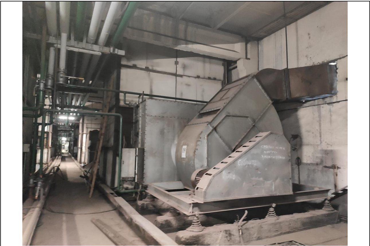
Фото 51. Общий вид венткамеры примыкающей к цеху №8 по оси В.
