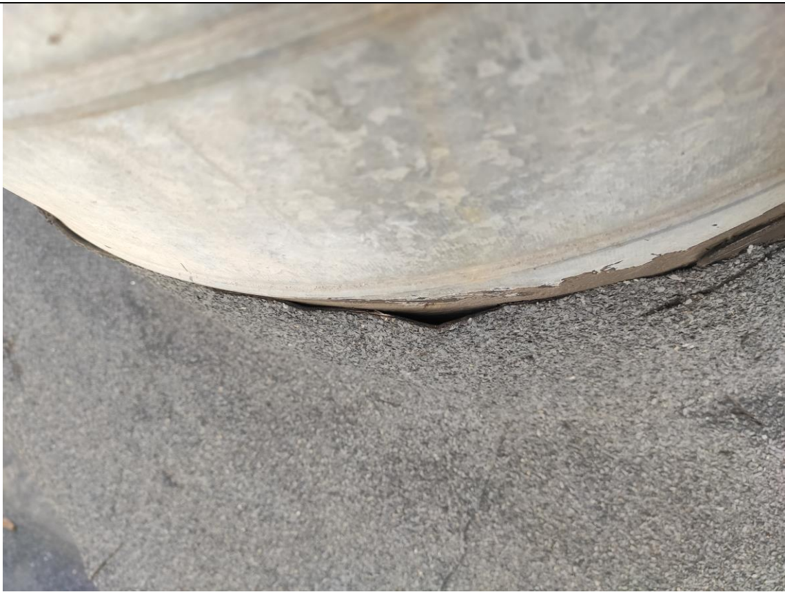
Фото 43. Негерметичное примыкание гидроизоляционного ковра к вентиляционной трубе в осях В/25-26.
