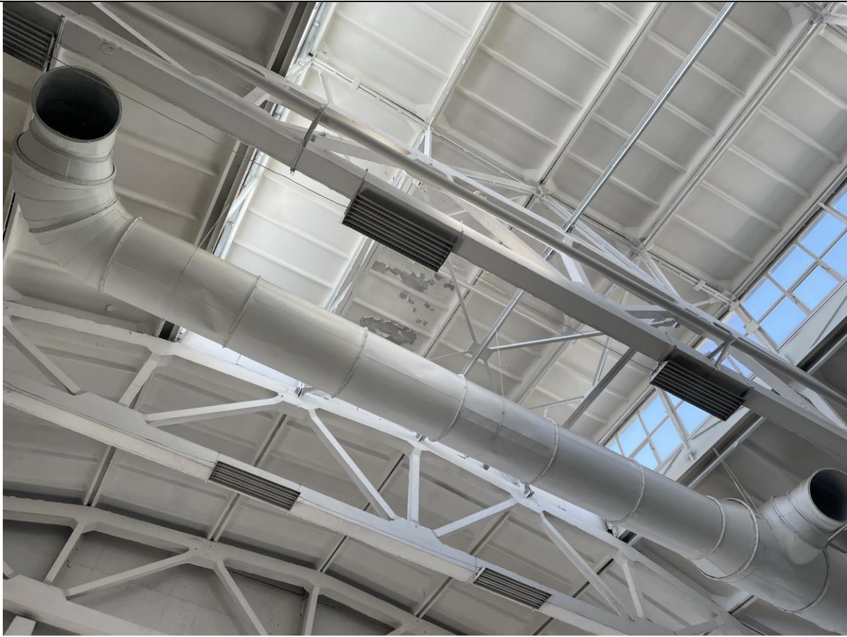
Фото 19. Воздуховоды системы вентиляции.
