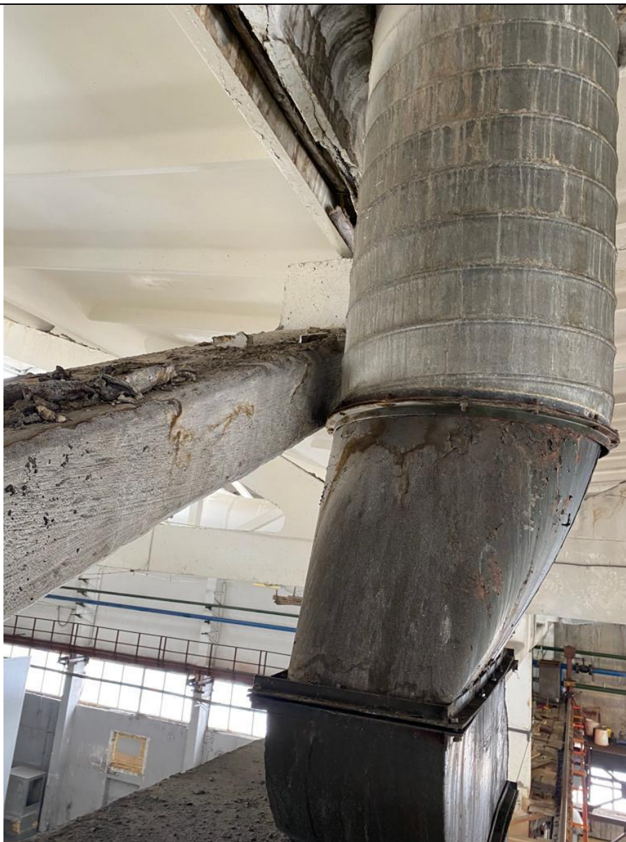
Фото 40. Разрушение защитного слоя бетона ребра плиты покрытия. поверхностная коррозия обнажившейся арматуры.
