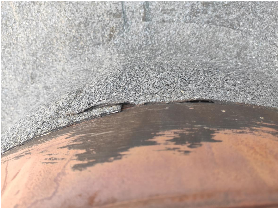
Фото 41. Негерметичное примыкание гидроизоляционного ковра к вентиляционной трубе в осях В/15-16.
