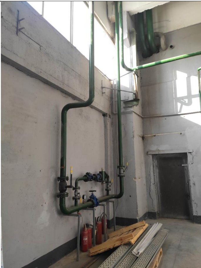
Фото 18. Ввод трубопроводов отопления.
