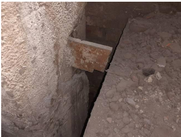
Фото 61. Нарушение крепления верхнего пояса подкрановой балки с конструкцией колонны (разрыв сварного шва).
