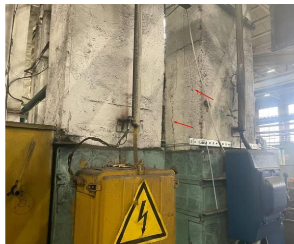
Фото 40. Вертикальные трещины в теле бетона колонны.
