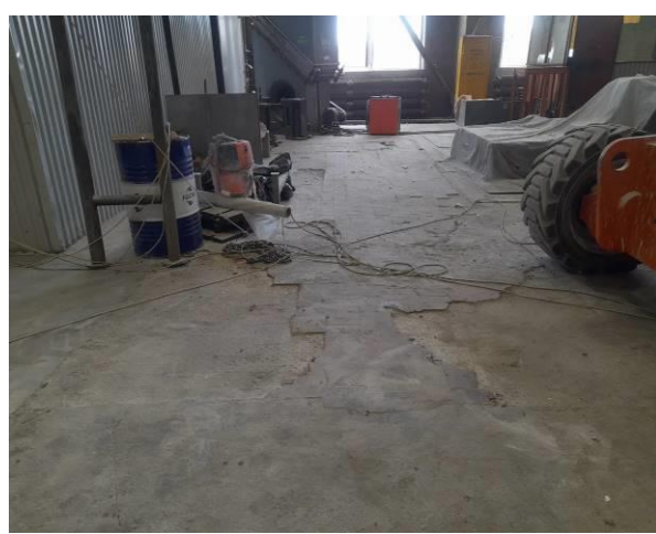
Фото 22. Разрушение напольного покрытия (керамической плитки)
