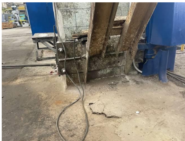
Фото 17. Разрушение напольного покрытия.
