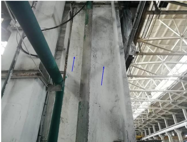
Фото 45. Горизонтальные трещины в теле бетона.
