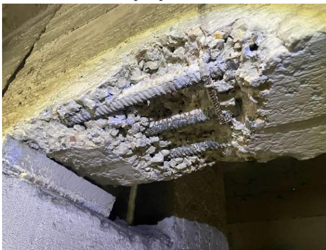
Фото 75. Вскрытие несущей конструкции с целью определения геометрических характеристик и армирования.
