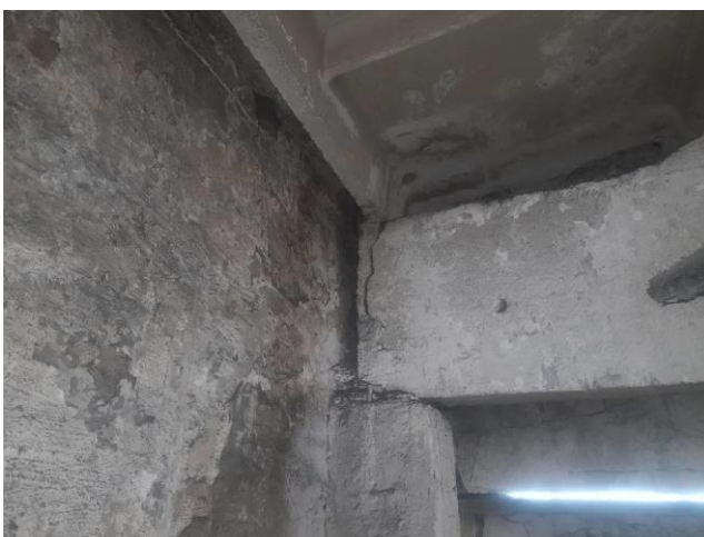
Фото 63. Вертикальная трещина в теле бетона в месте опирания одного продольного ребра плиты покрытия (ширина раскрытия до 10 мм).
