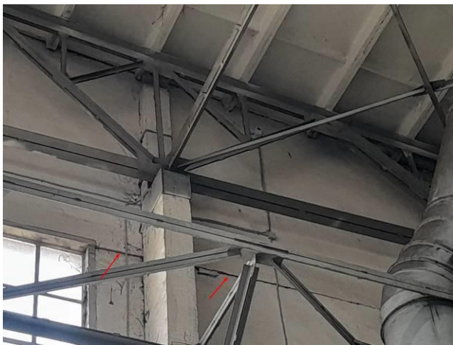
Фото 37. Выход из вертикальной плоскости части стены с образованием зазора с обвязочной балкой 40 мм.
