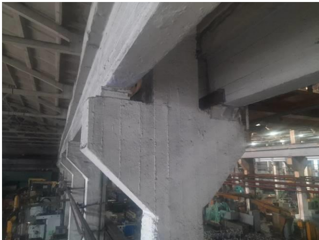
Фото 47. Вина на опирание подкрановых балок на консоли колонны.
