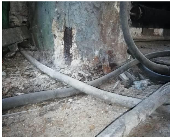
Фото 42. Разрушение защитного слоя бетона с оголением и коррозией арматуры.
