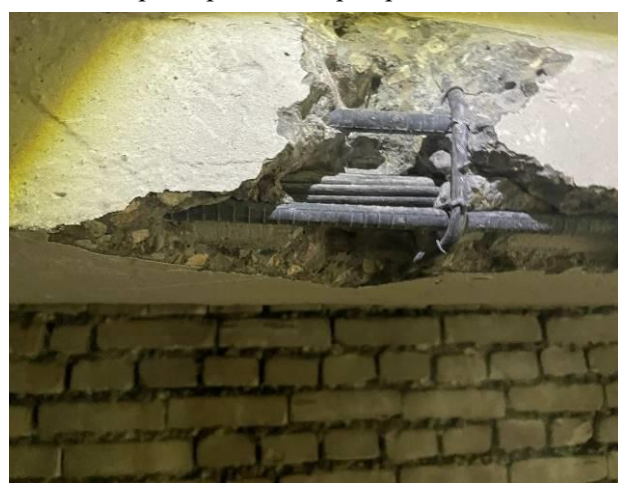
Фото 76. Вскрытие несущей конструкции с целью определения геометрических характеристик и армирования.
