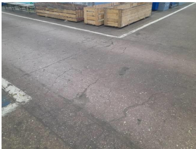
Фото 19. Трещины по напольному покрытию.
