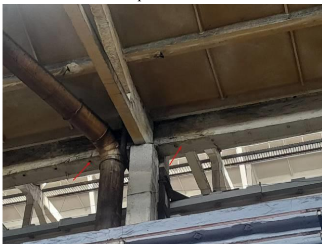
Фото 33. Сколы бетона (без обрушения), не превышающие величину защитного слоя бетона в приопорных зонах обвязочных балок
