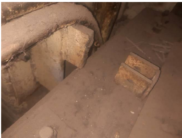
Фото 55. Нарушение крепления верхнего пояса подкрановой балки с конструкцией колонны (разрыв сварного шва).
