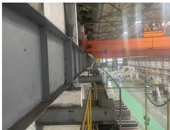
Фото 58. Отсутствие болтов в месте крепления подкрановых балок между собой. Деформация нижнего пояса подкрановой балки.
