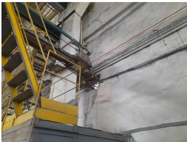
Фото 31. Неорганизованное технологическое отверстие в стене.
