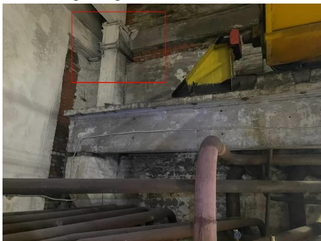
Фото 35. Вид на металлическую обойму в зоне опирания фермы на колонну.
