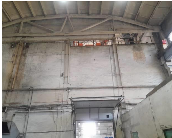
Фото 26. Следы замачивания, высолы. Трещины по отделочному слою. Вид на Обвязочную балку и консоли.
