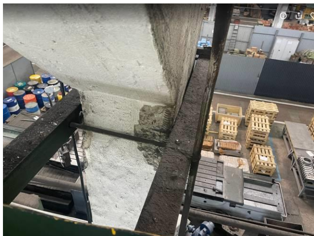
Фото 39. Разрушение защитного слоя бетона с оголением и коррозией арматуры.
