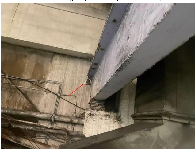
Фото 57. Скол бетона подкрановой балки (свисает на арматурном стержне).
