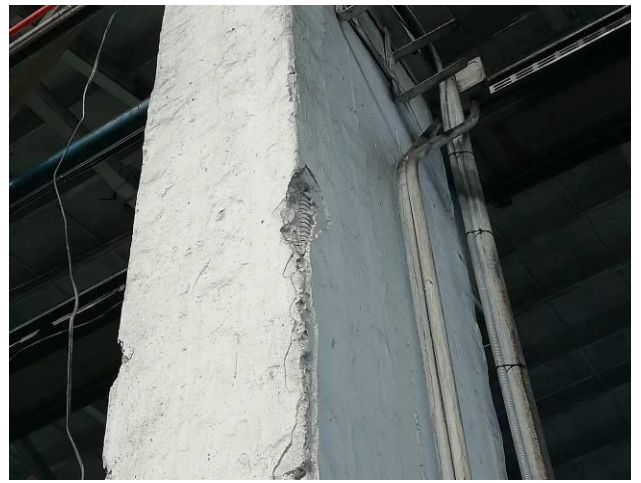
Фото 44. Разрушение защитного слоя бетона с оголением и коррозией арматуры.
