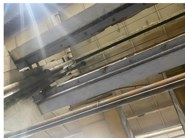
Фото 54. Разрушение защитного слоя бетона с оголением и коррозией арматуры конструкции подкрановой балки.
