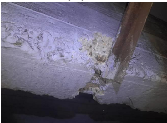
Фото 77. Вскрытие несущей конструкции с целью определения геометрических характеристик и армирования.
