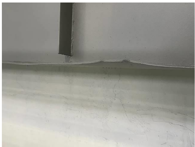
Фото 52. Деформация нижнего пояса подкрановой балки.
