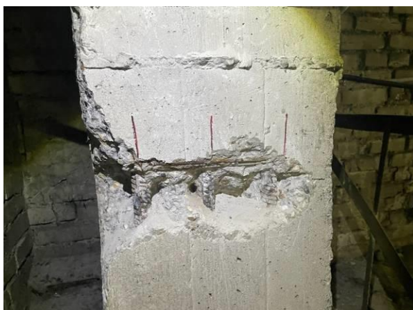
Фото 72. Вскрытие несущей конструкции с целью определения геометрических характеристик и армирования.
