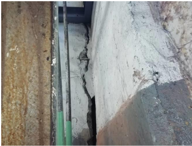
Фото 43. Скол бетона из-за разрыва примыкания к стене.
