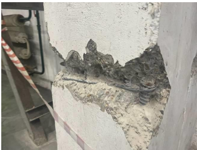
Фото 73. Вскрытие несущей конструкции с целью определения геометрических характеристик и армирования.
