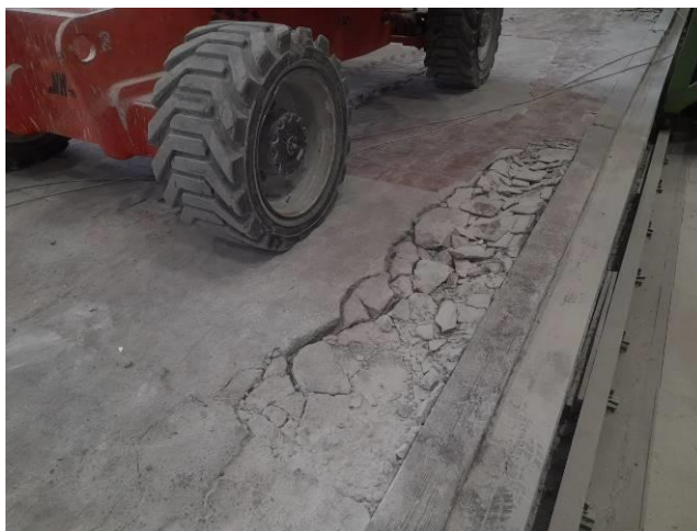
Фото 21. Разрушение напольного покрытия.
