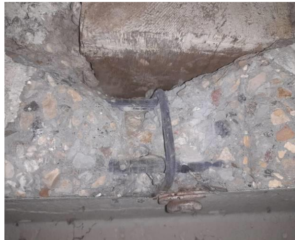
Фото 74. Вскрытие несущей конструкции с целью определения геометрических характеристик и армирования.
