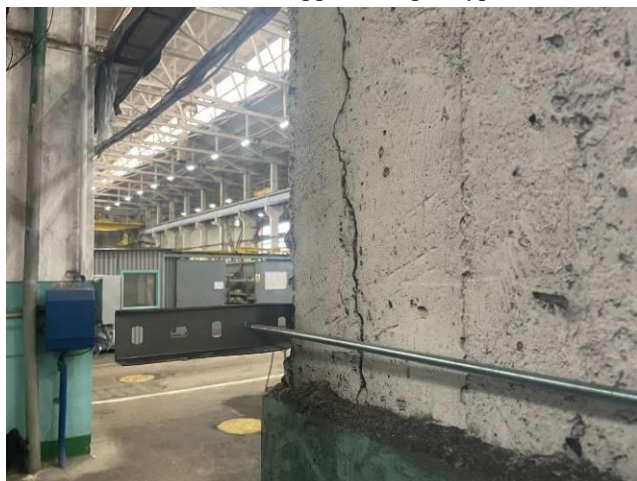
Фото 41. Вертикальные трещины в теле бетона колонны.
