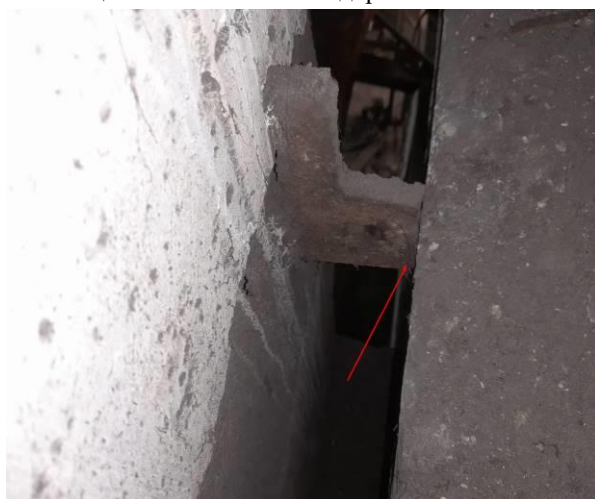
Фото 60. Нарушение крепления верхнего пояса подкрановой балки с конструкцией колонны (разрыв сварного шва).
