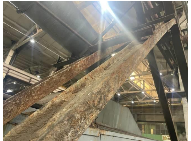
Фото 46. Продукты коррозии элементов вертикальной связи по колоннам. Отсутствие АКЗ.
