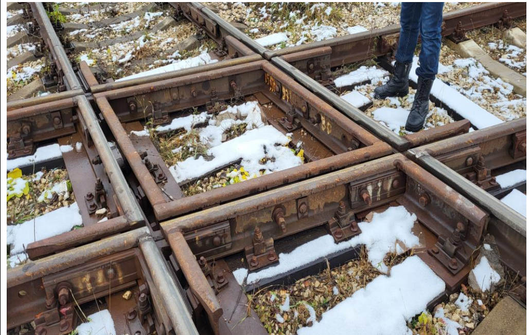
Фото №4. Дефектные элементы глухого пересечения. Трещины.
