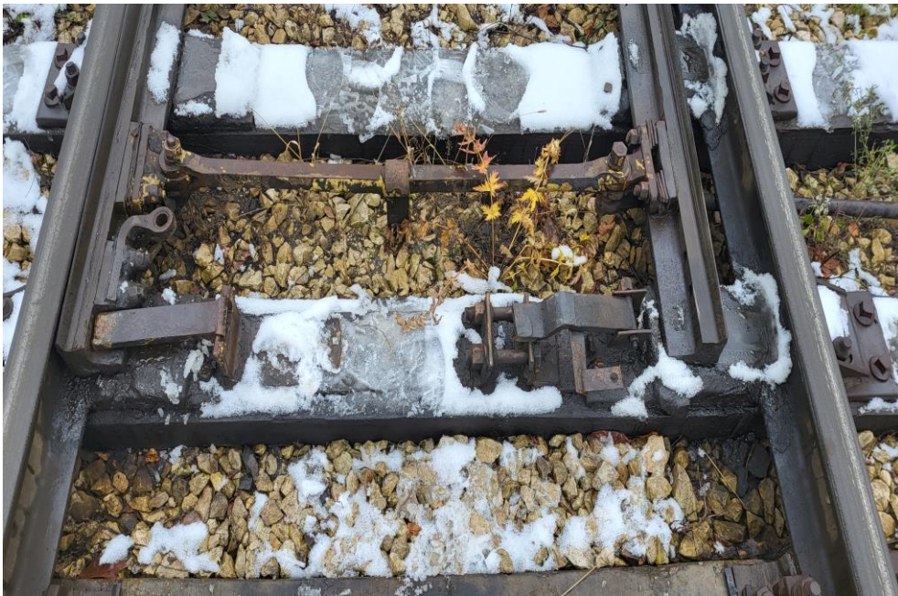
Фото №3. С левой стороны нетиповая запорная закладка.
